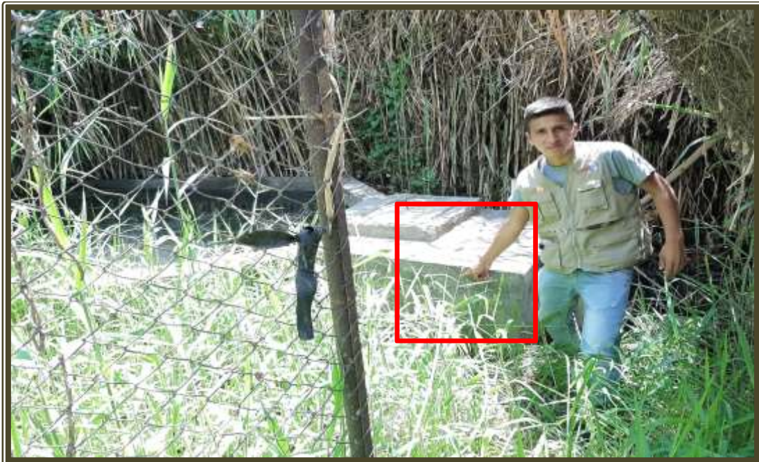
Fotografía 08: Se observa que la estructura de la cámara de captación presenta grietas y fisuras.
