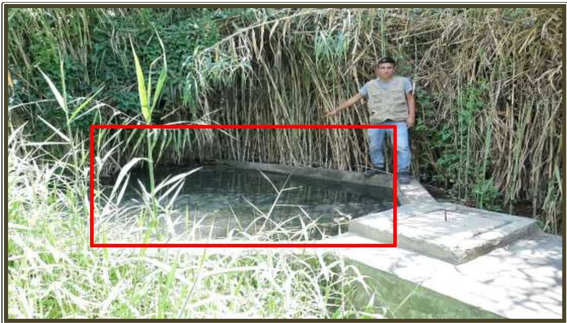
Fotografía 06: Se observa la estructura de captación que no tiene ninguna protección de afloramiento, además se indica que está expuesto ante agentes contaminantes.
