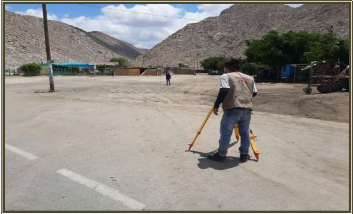
Fotografía 25: Se observa el trabajo de levamiento topográfico que se realizó en la red de distribución del centro poblado María Cristina.
