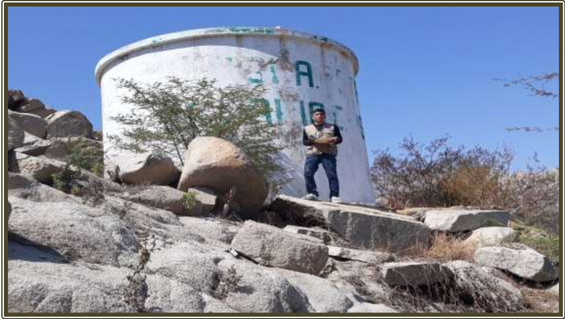
Fotografía 13: Se observa el reservorio de almacenamiento, donde se evaluó el estado de operación y funcionamiento.
