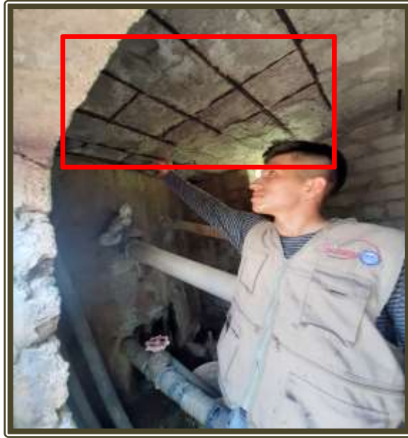
Fotografía 15: Se observa la inspección de la estructura de la caja de válvula del reservorio, se indica que el acero se encuentra en estado de corrosión y el concreto en estado de desprendimiento.
