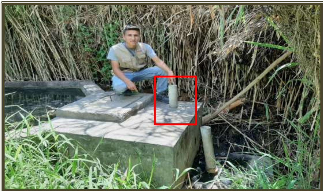
Fotografía 10: Se indica la tubería de ventilación de la cámara húmeda, que no cumple con un diseño correcto que permita realizar su funcionamiento correcto.
