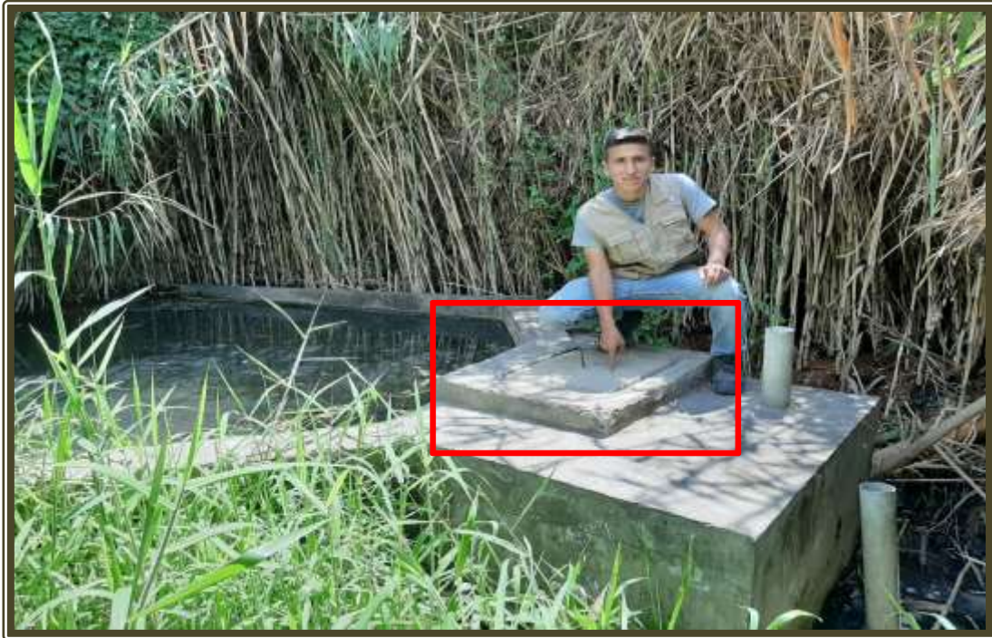
Fotografía 09: Se observa la tapa de la cámara húmeda de concreto armado, no cuenta con ningún seguro que pueda evitar que se manipule por personal no autorizado.
