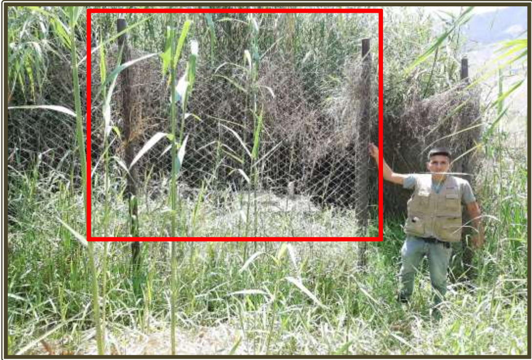
Fotografía 07: Se indica el cerco perimétrico de protección en estado de oxidación, además se observa que no tiene ninguna puerta que puede restringir el ingreso.
