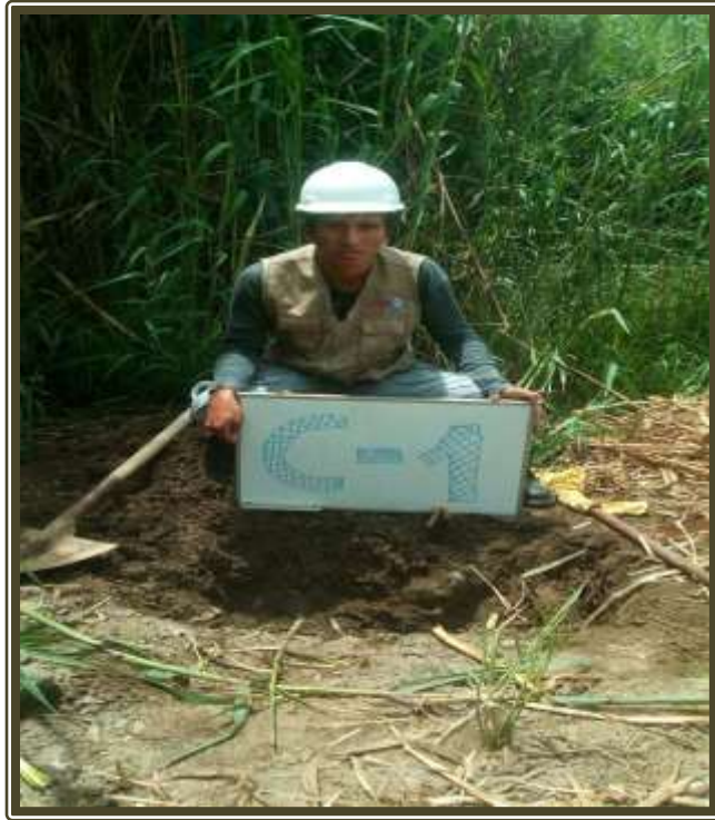
Fotografía 29: Se muestra la calita C-1, con fines de cimentación en el punto de captación.
