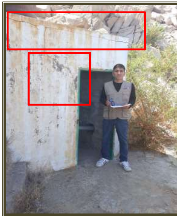
Fotografía 14: Se indica que se realizó la inspección de la estructura del reservorio de almacenamiento, se puede apreciar que presenta fisuras en la parte superficial del acabado.
