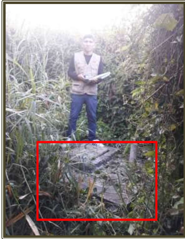
Fotografía 05: Se observa la estructura de la cámara de captación en estado de deterioramiento.
