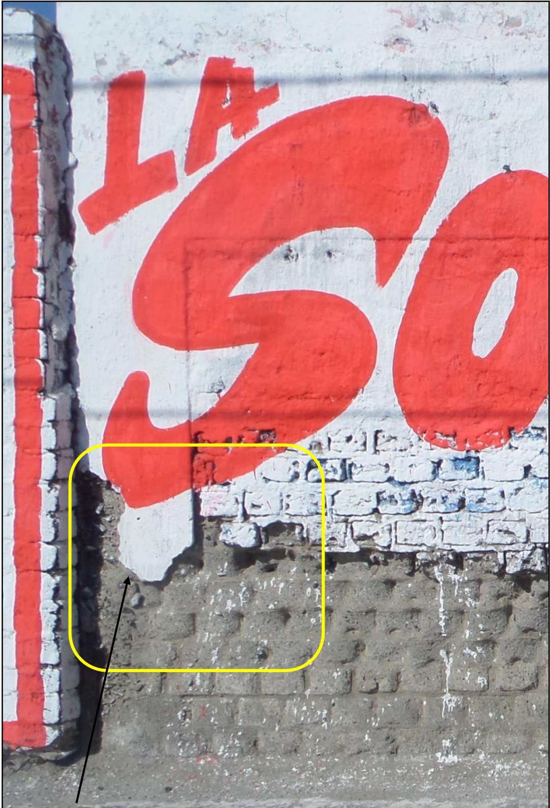
Fotografía 08: Desprendimiento. (U.M.: 2 y 3)
