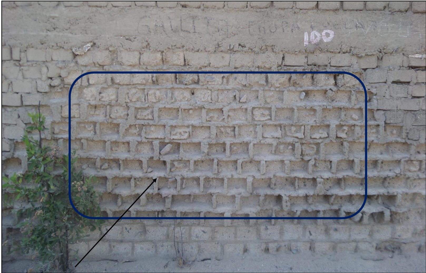
Fotografía 03: Erosión. (U.M.: 2 y 3)
