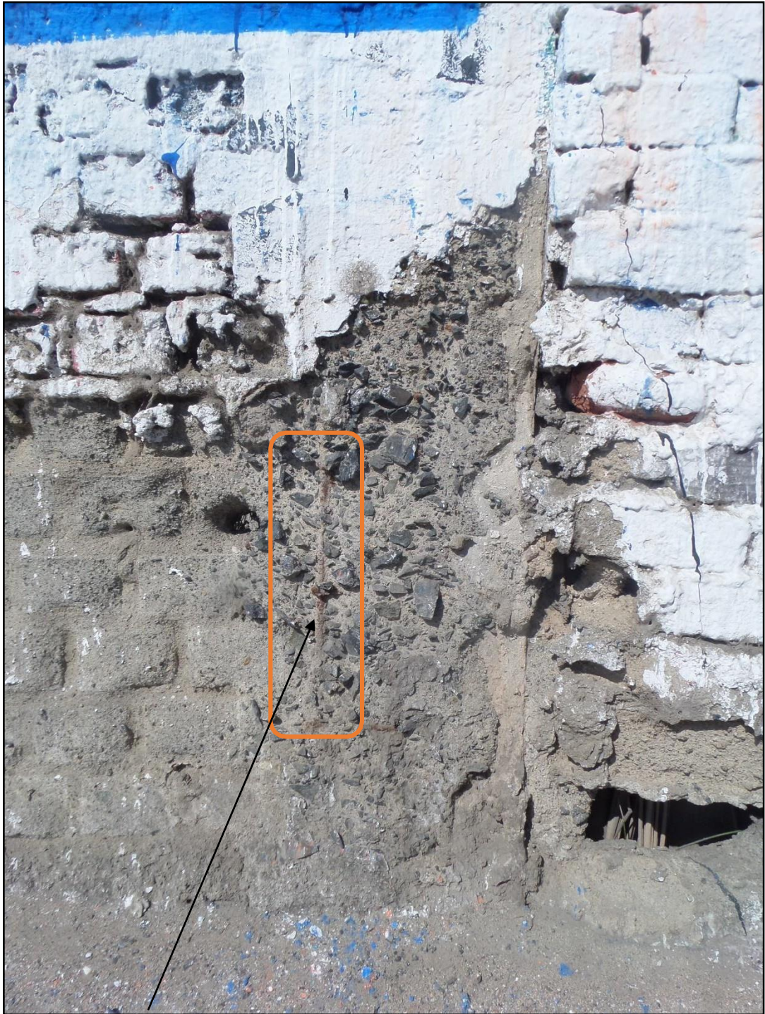
Fotografía 06: Corrosión. (U.M.: 6 y 10 )
