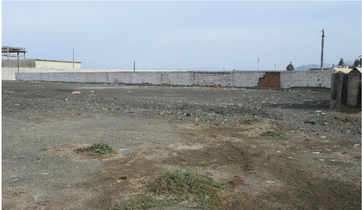
Fotografía 3: Vista panorámica del tramo externo B-C del cerco del local de almacenamiento de la empresa Petroperú.
