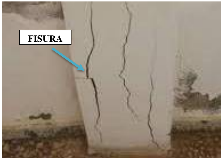
Gráfico 17. Patología fisura. Fuente: Pinterest (2017).
