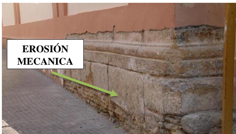
Gráfico 20. Patología erosión mecánica.
