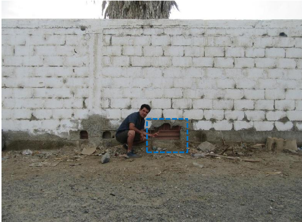
Fotografía 6: Se visualiza el muro de albañilería afectada por la desintegración
