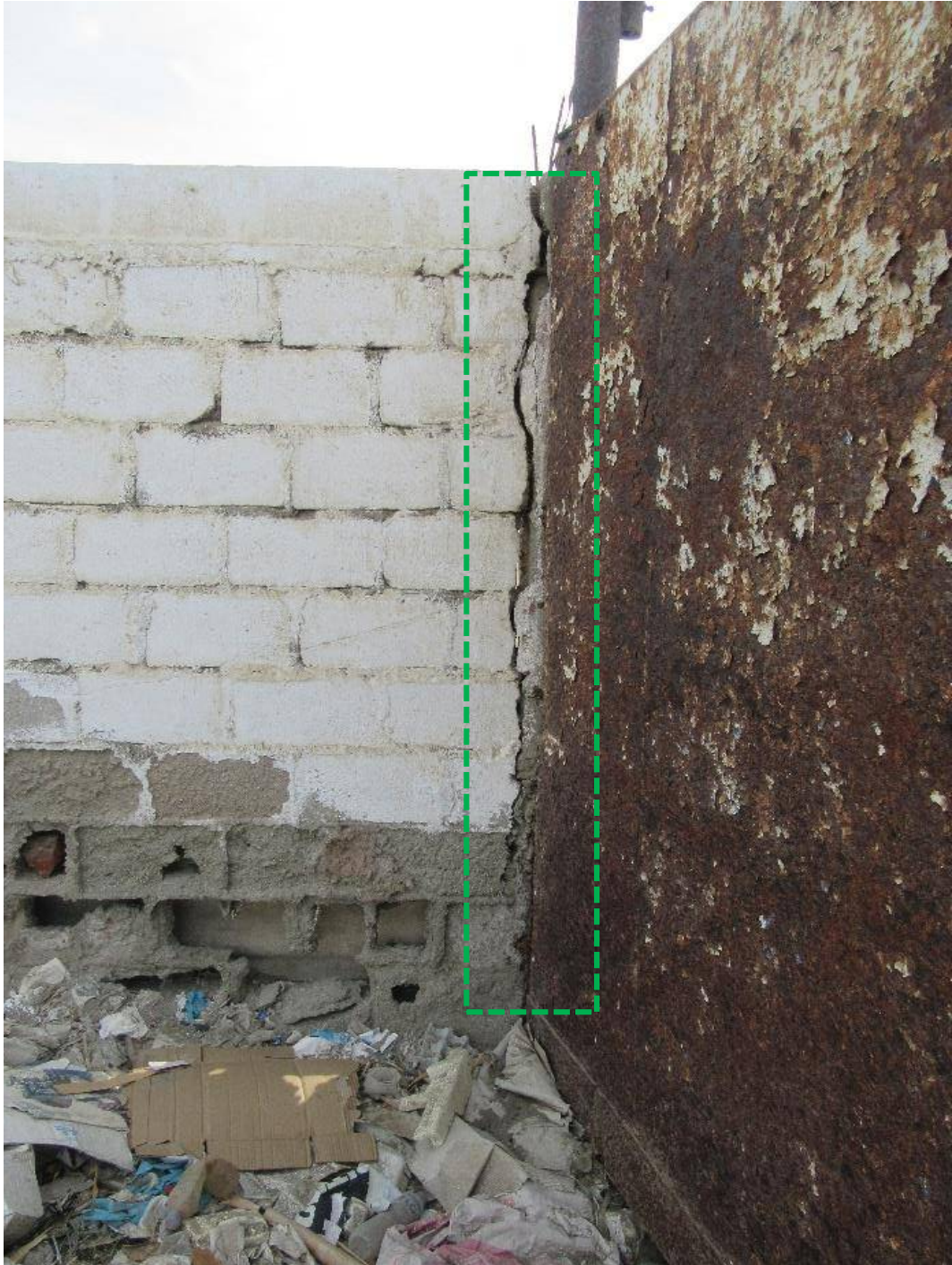
Fotografía 5: Muro de albañilería y viga afectada por una grieta de un nivel de severidad alto, en la UM-4
