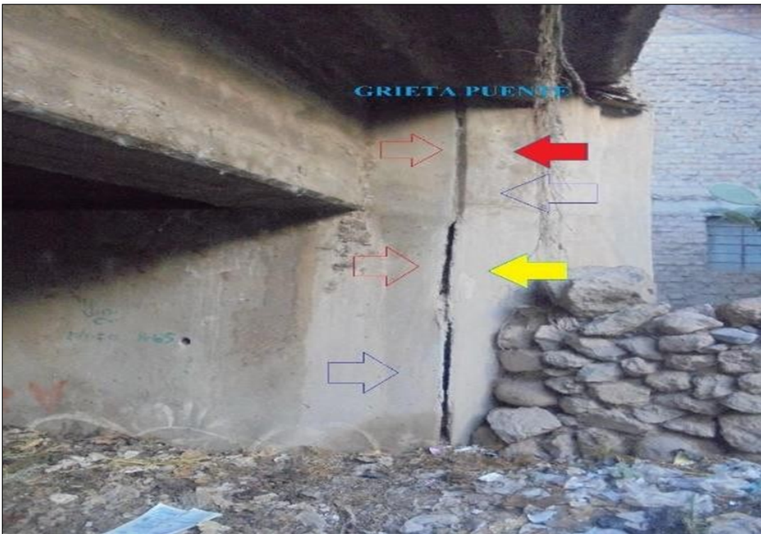
Fotografía 4: Fisuras en la Columna 1.
