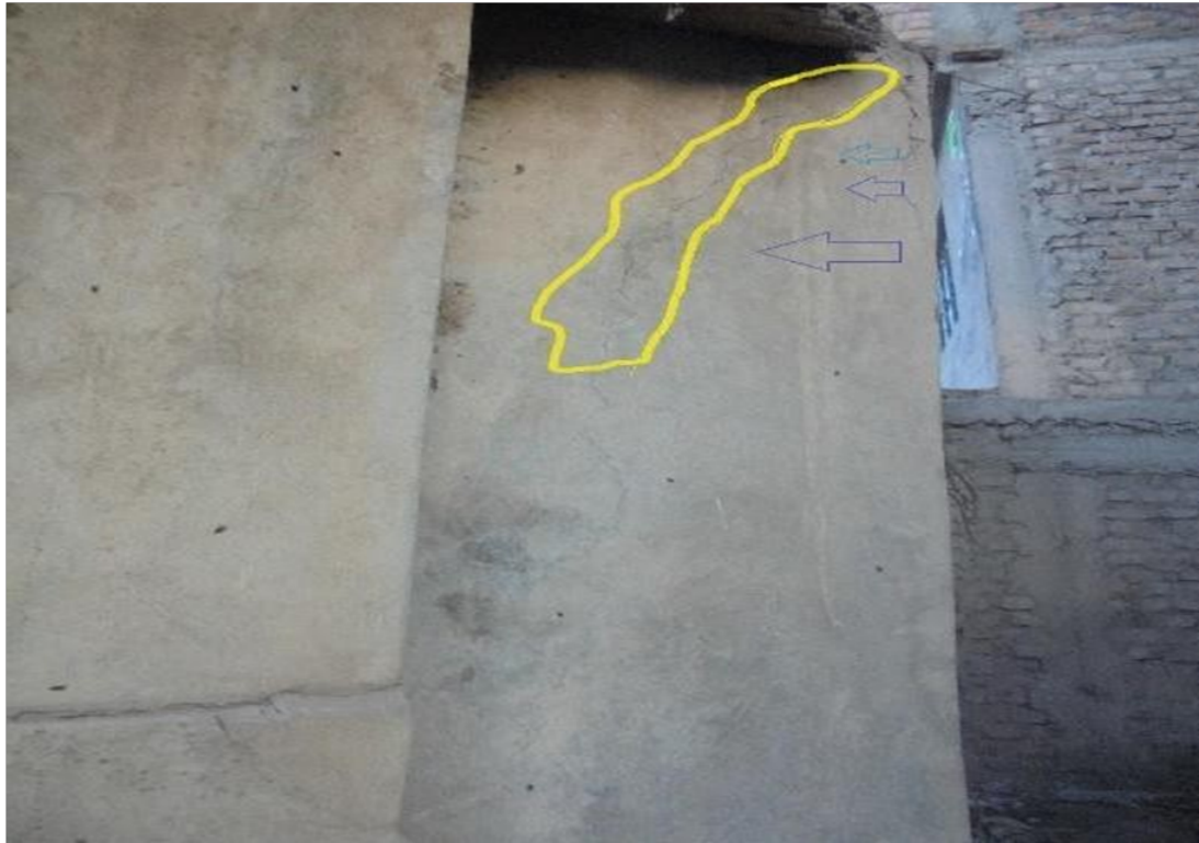
Fotografía 5: Fisuras en la Columna 2.
