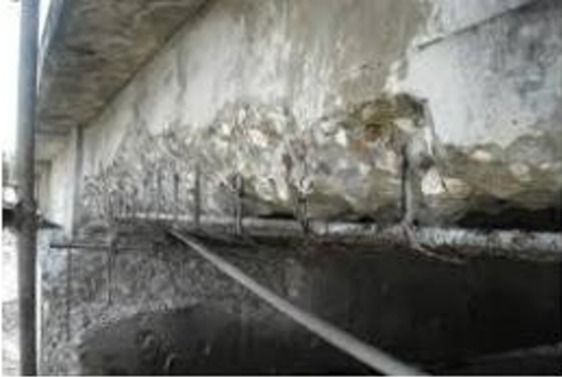
Figura 2.11: Desprendimiento del concreto Fuente: Elaboración Propia
