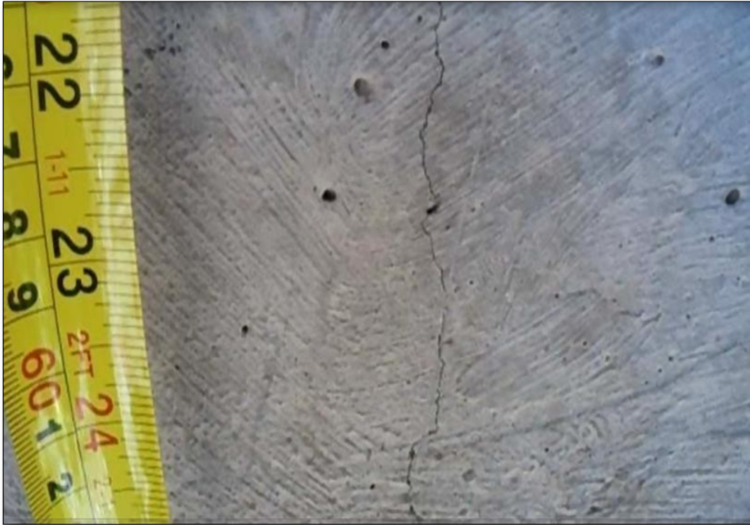
Fotografía 3: Fisuras en la viga 3.
