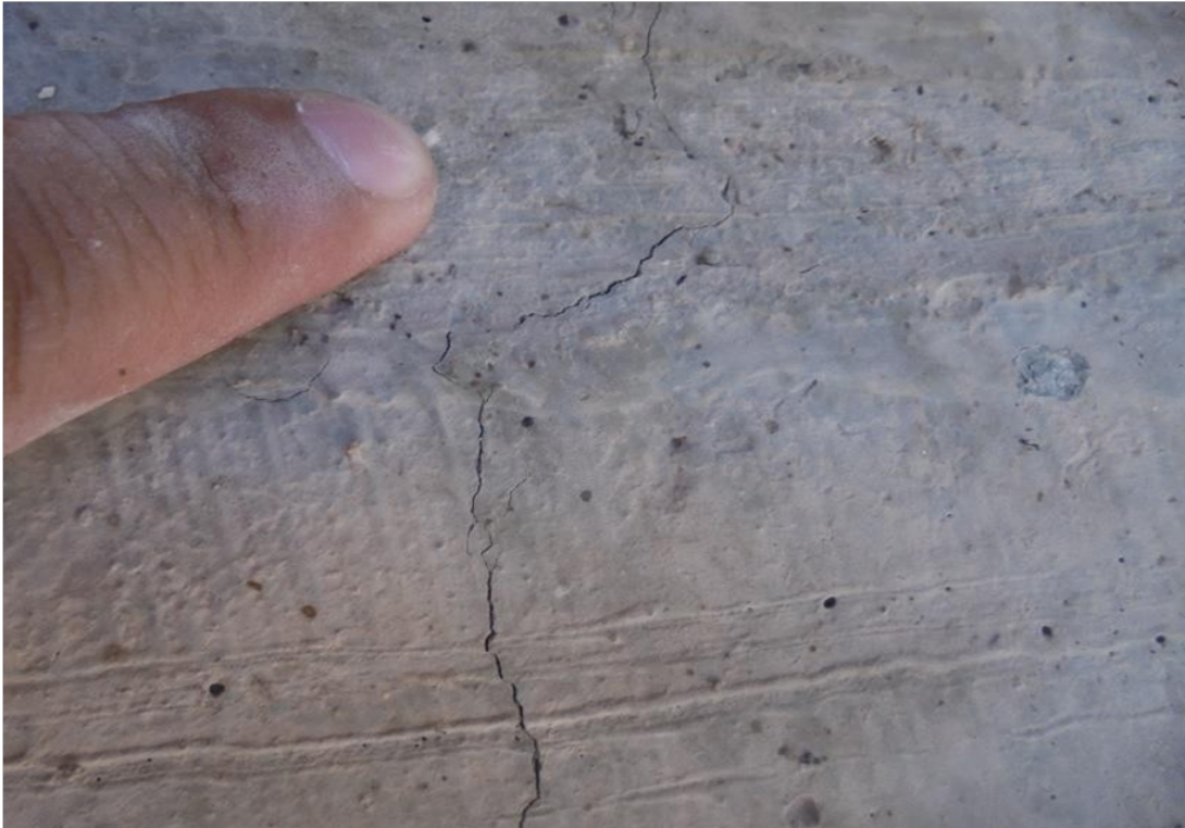
Fotografía 1: Fisuras en la Viga 1.
