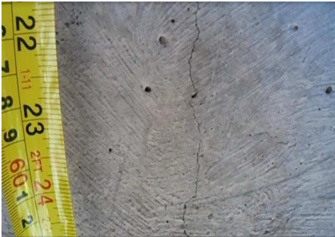
Fotografía 2: Fisuras en la viga 2.
