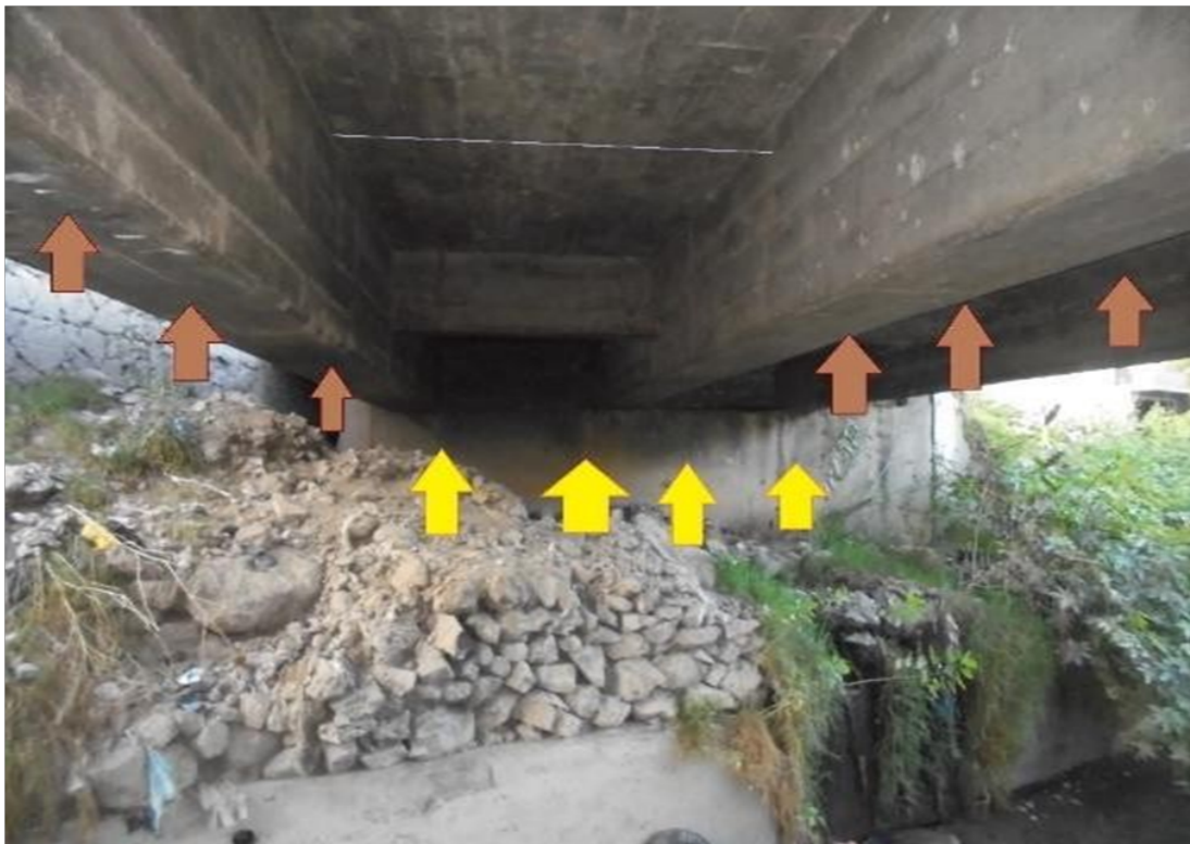
Fotografía 6: Fisuras en la Viga.
