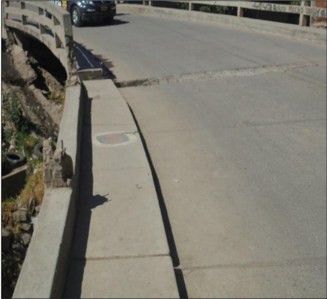
Figura 5.7: Patología en la Baranda del puente.
