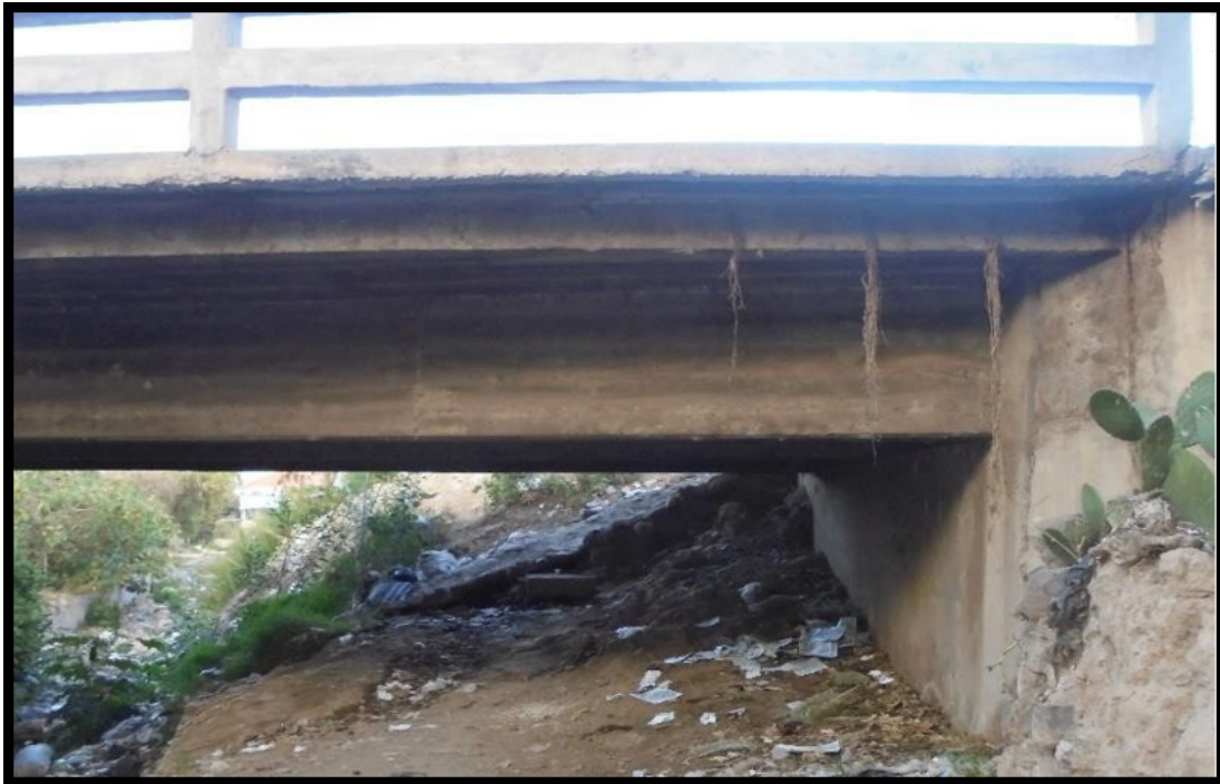
Figura 5.5: Patología en la Viga del puente. Fuente: Elaboración propia.
