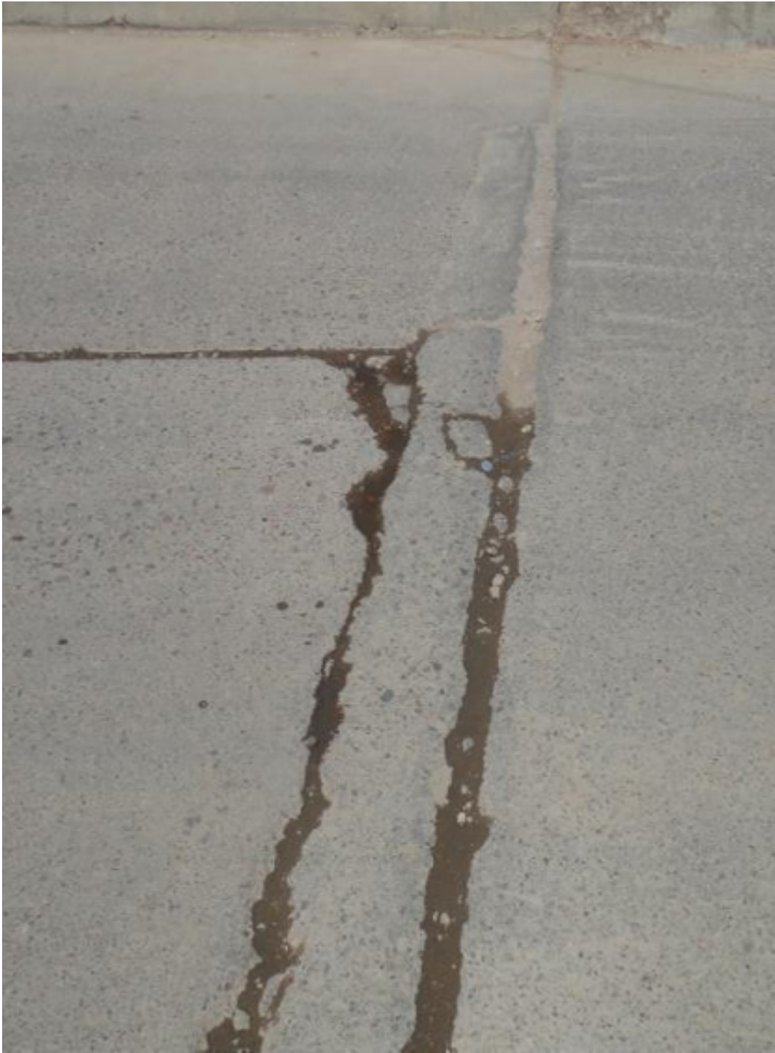
Figura 5.3: Patología en la losa del puente.
