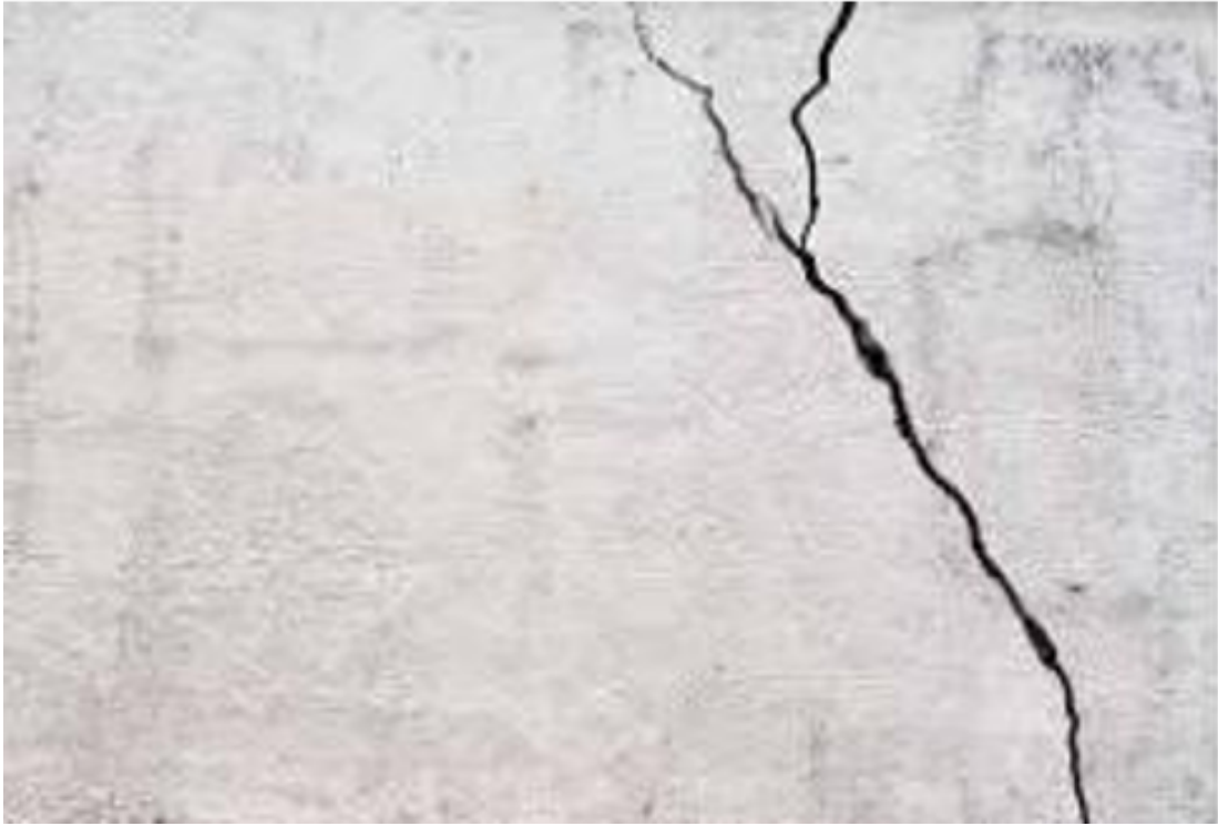
Figura 2.10: Fisura en concreto
