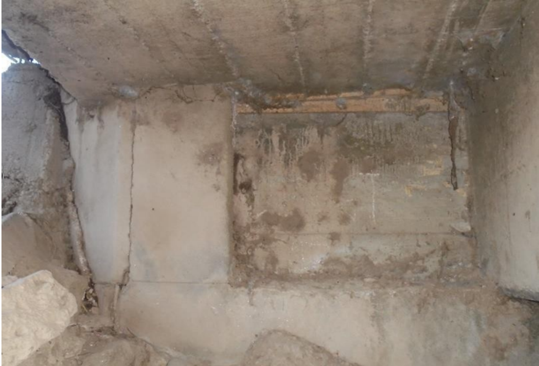
Figura 5.1: Patología en la columna del puente. Fuente: Elaboración propia.
