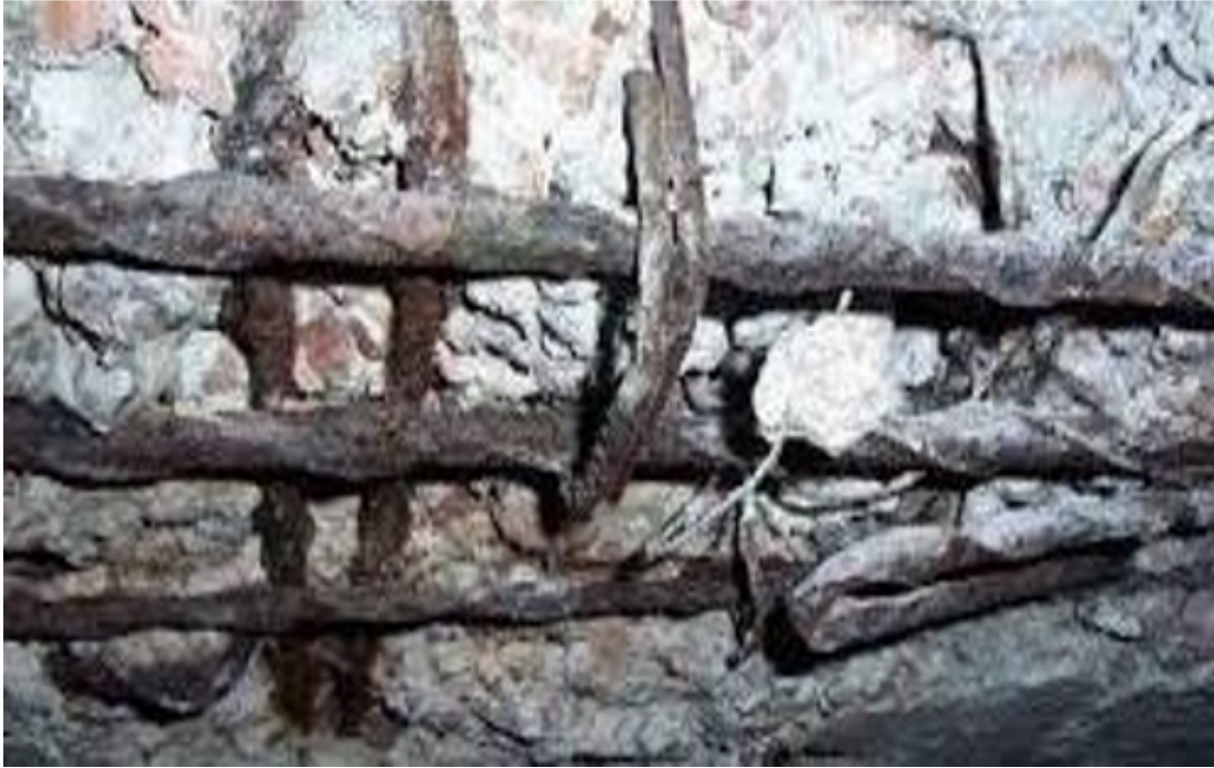
Figura 2.12: Patología corrosión del acero Fuente: Elaboración Propia
