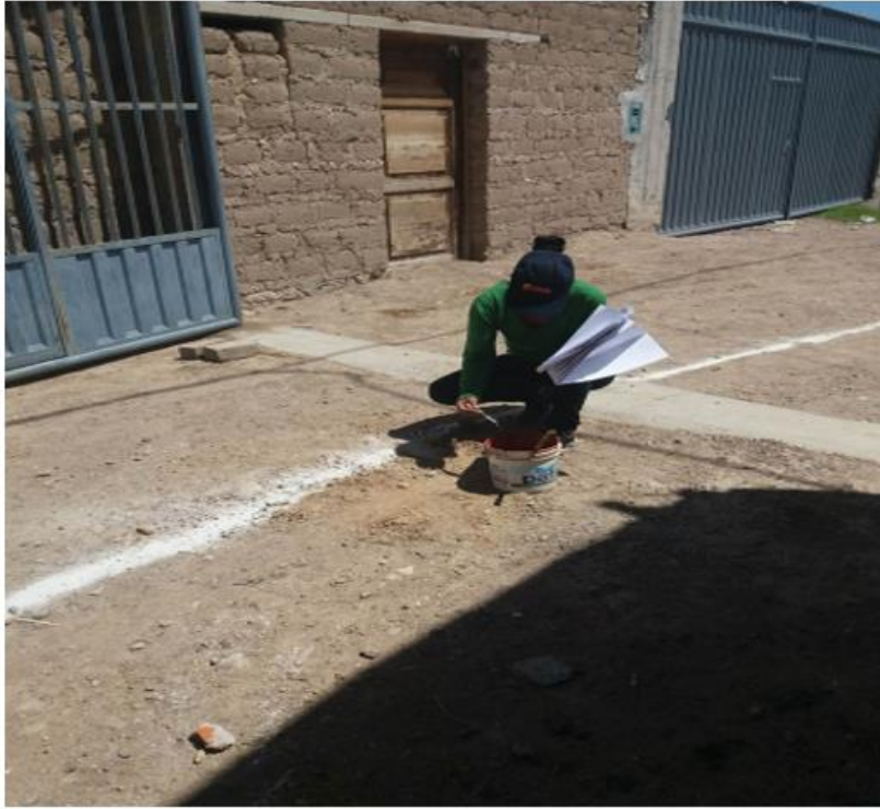
Fotografía 5: Trazo y replanteo de la línea de conducción en jr. Buena Vista.
