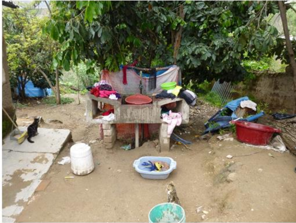
Figura 5.5: San Juan Bautista: Instalaciones domiciliarias de agua potable.
