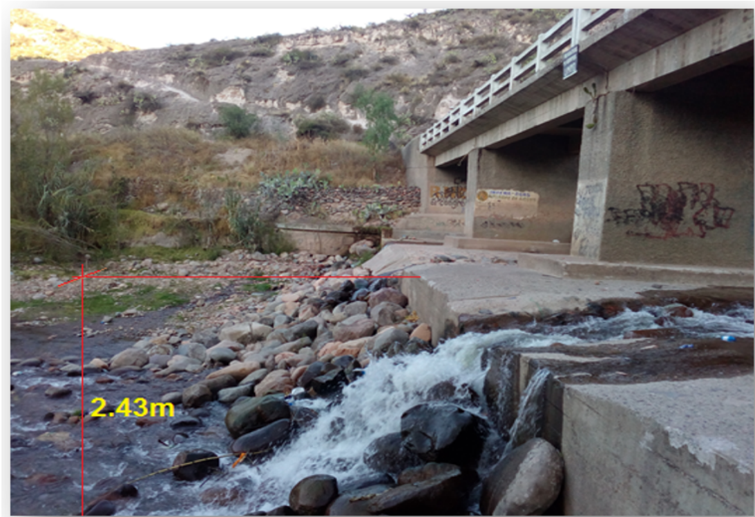
Figura 6.1: Profundidad de socavación en el puente Huatatas .
