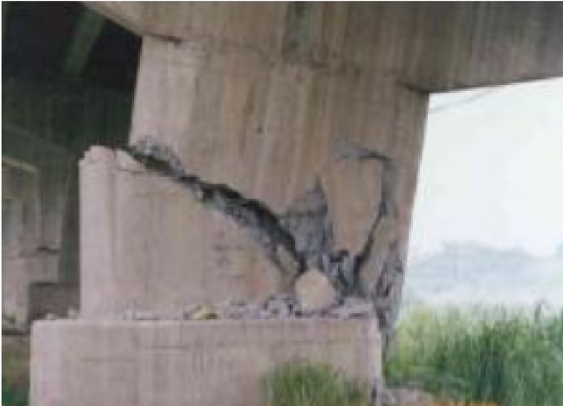
Figura 2.3: Fractura por cortante en la Pila. Puente U Shi. Taiwan.
