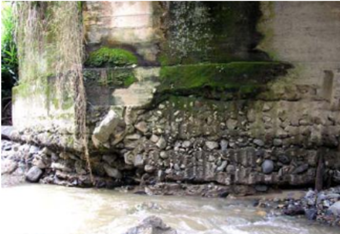
Figura 2.4: Socavación en un estribo.
