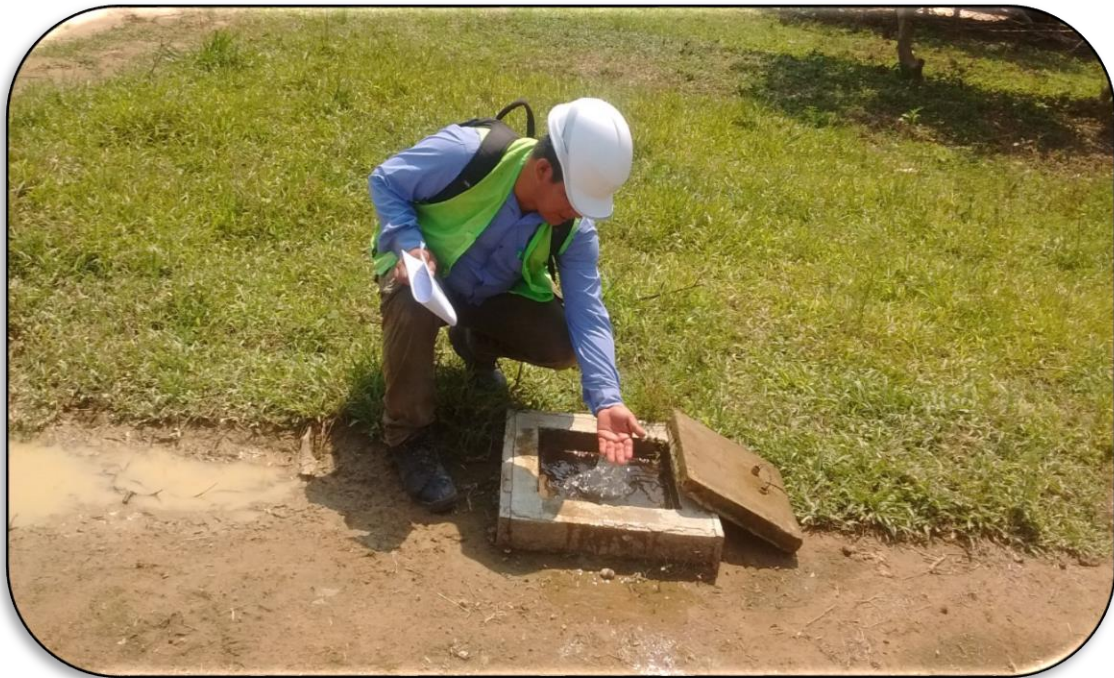
En la Vista se Observa, Cajas de llave de paso en Conexiones Domiciliarias
