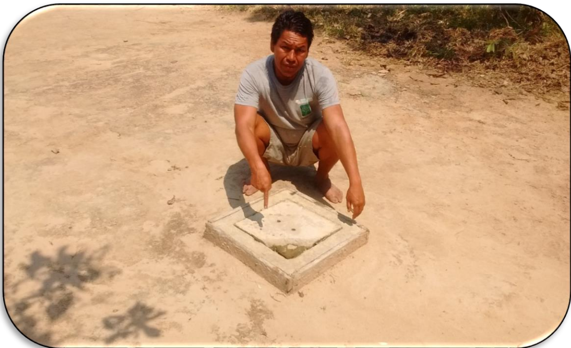
En la Vista se Observa, Caja de Paso de Concreto deteriorado en Red Domiciliaria
