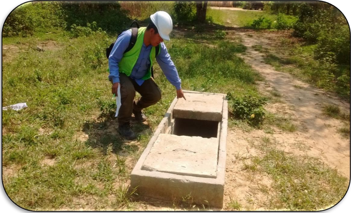
Se Observa la Verificación, Cajas de Válvula de Distribución de Red Primaria
