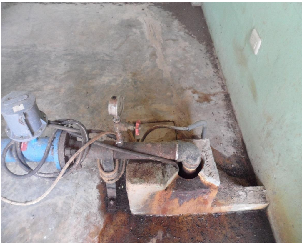
Foto n° 8: Accesorio en mal estado
