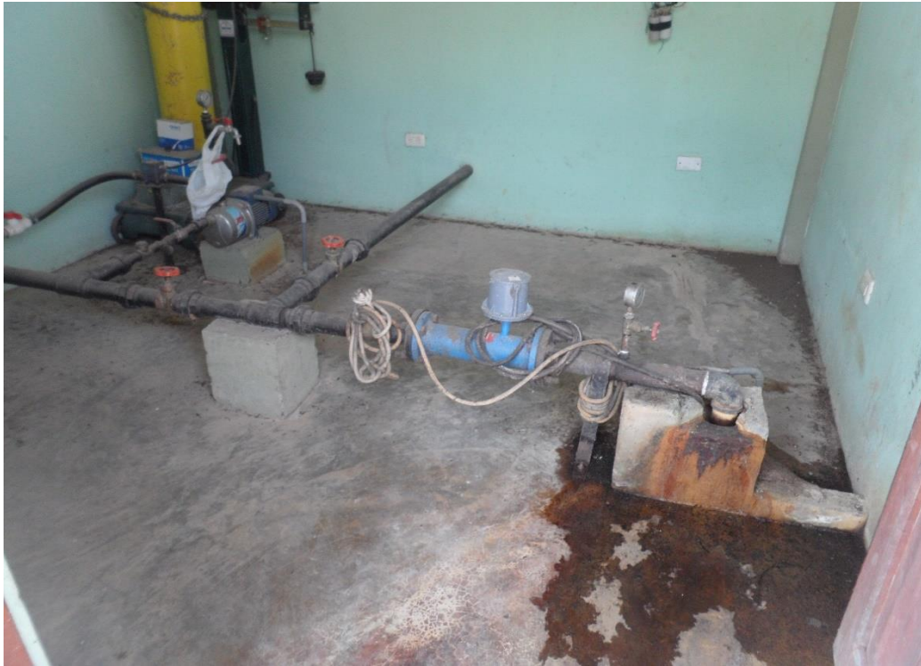
Foto n° 7: Dosificador de cloro
