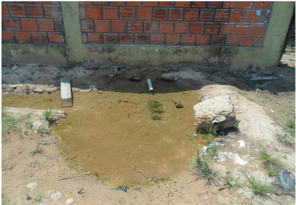
Foto n° 14: Tuvo de desfogue de agua
