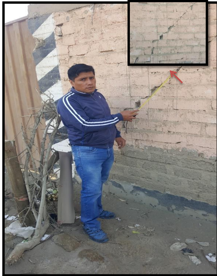
Imagen 4: Patología de grietas en el muro entre los ejes G-F de la Unidad Muestral 4
