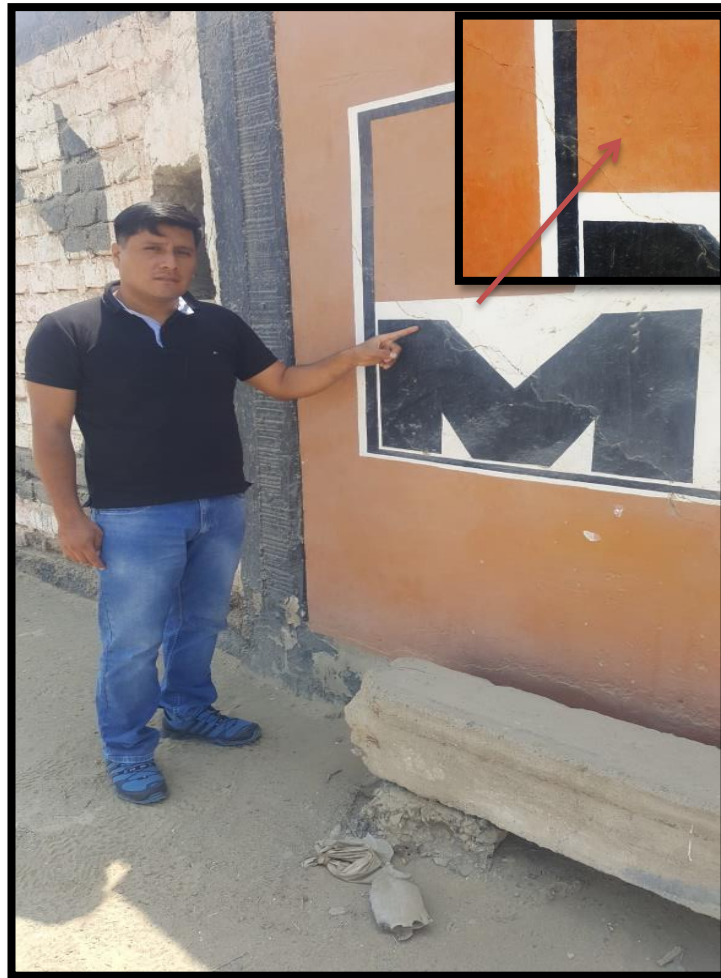
Imagen 6: Patología de fisura en el muro de los ejes H-I de la Unidad Muestral 5.
