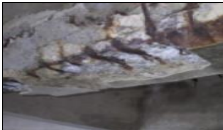
Figura 14: Patología de la corrosión – Fuente Manual de rehabilitación de estructuras de hormigón
