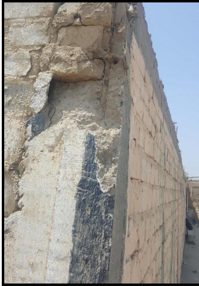
Ubicado en la U.M 7, en la columna 13, Leve
