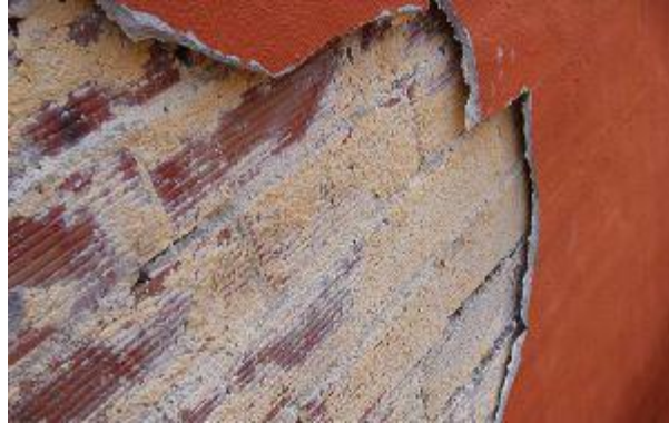
Figura 12: Desprendimiento - Fuente: http://itegranca.es/criptoflorescencia
