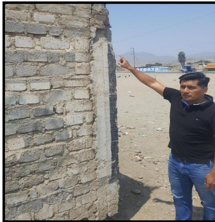
Imagen 8: Patología de Desprendimiento en columna del eje 1 de la Unidad Muestral 7
