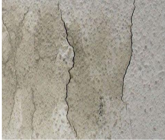
Figura 10: Fisuras en muros - Fuente: Astorga A, Rivero P. 2009
