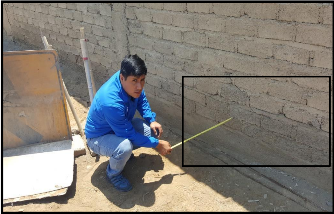
Imagen 5: Patología de Disgregación en el muro entre los ejes G 2 -F' de la unidad muestral 15
