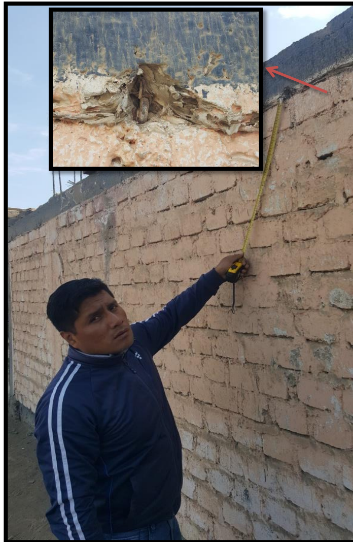
Imagen 9: Patología de la Corrosión en la viga entre el eje B-C de la Unidad Muestral 1
