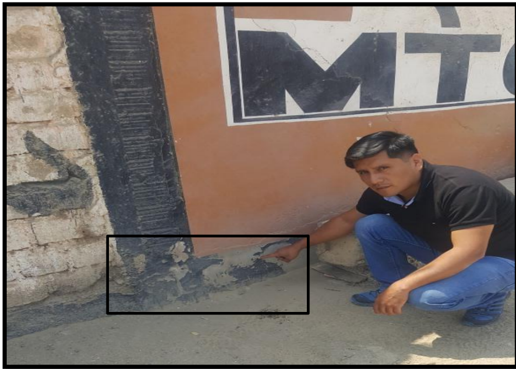
Imagen 7: Patología de Descascaramiento en el muro de los ejes H-I de la Unidad Muestral 5
