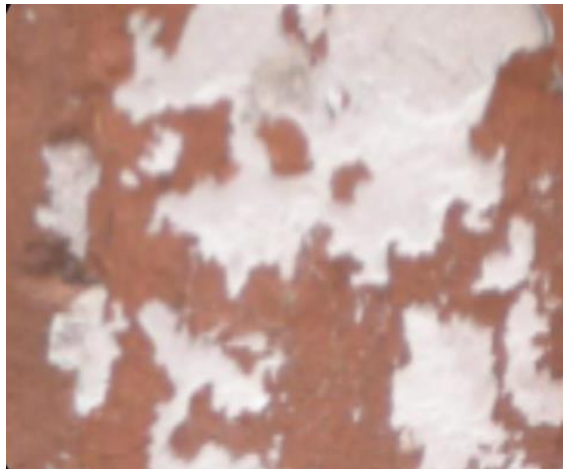
Figura 13: Descascaramiento en muro – Fuente: Quezada E. 2004
