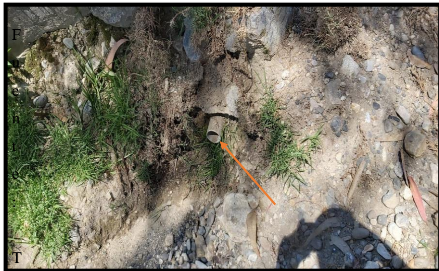
Fotografía N° 16: Tubería de limpia y rebose sin dado.
