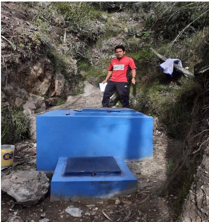
Fotografía N° 02: Captación, se observa la cámara humedad y seca
