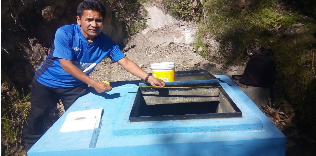
Fotografía N° 01: Captación, se observa que la estructura de la cama húmeda está en funcionamiento.
