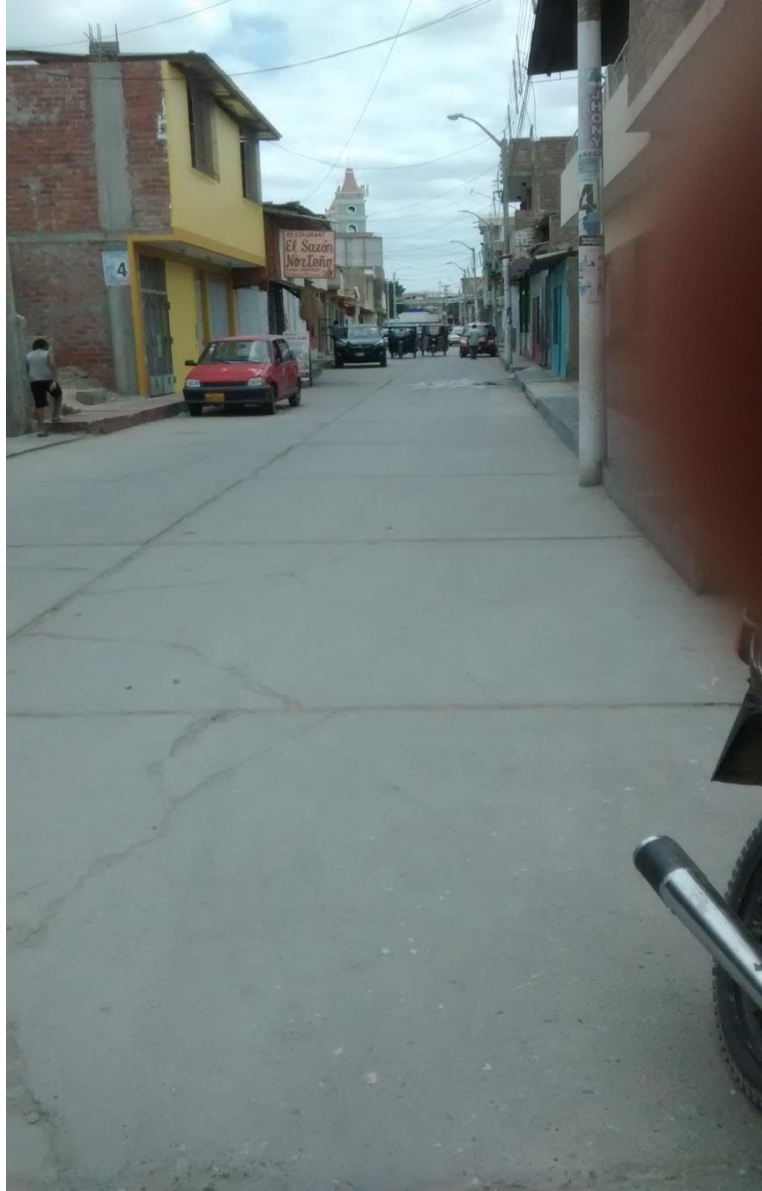
FOTO N°2: Pavimento rígido de la Calle Comercio
