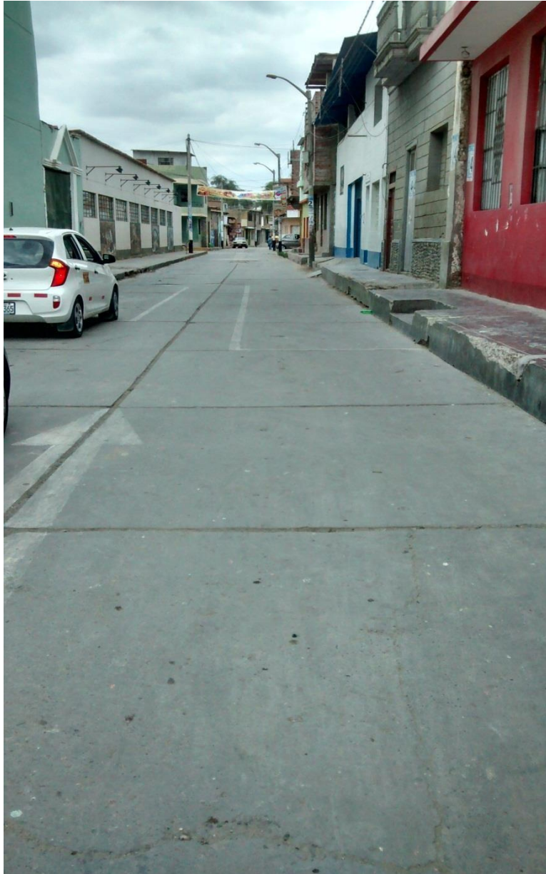
FOTO N°3: Pavimento rígido de la Calle Zepita
