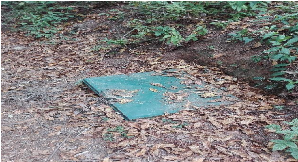
Ilustración 32: SE OBSERVA VALVULA DE CONTROL DE LA LINEA DE DISTRIBUCION
