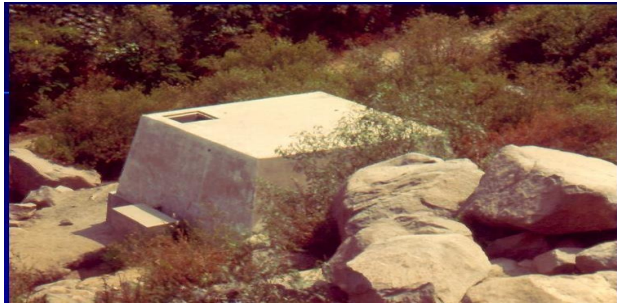
Fuente: Blog Marco A. – Abastecimiento de Agua
