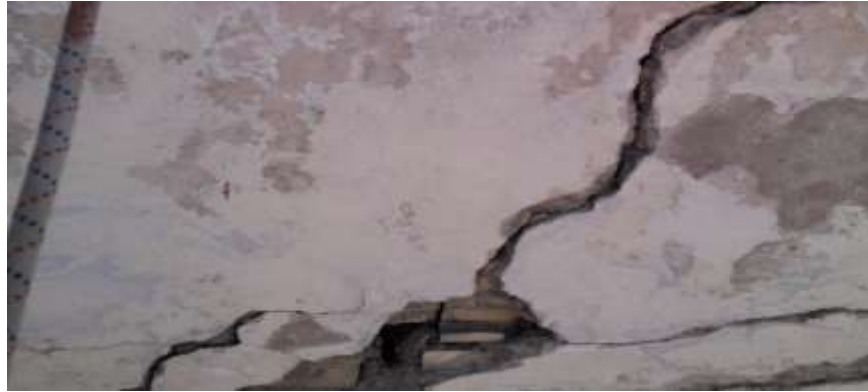
Figura 20: Grietas en un Muro de una vivienda.
