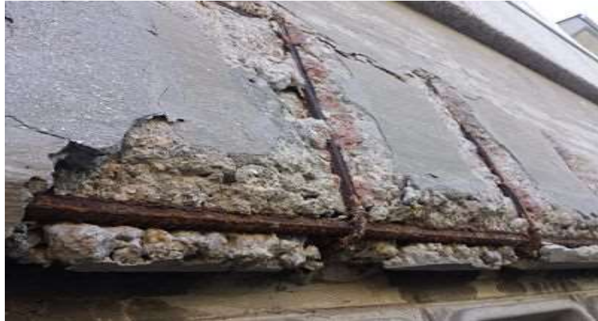
Figura 25: Corrosión del acero en una Viga.
