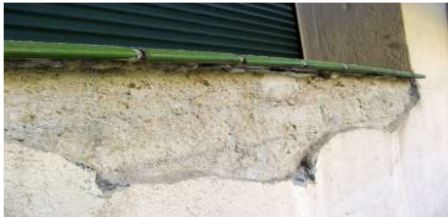
Figura 27: Desprendimiento del Revestimiento en un Muro.
