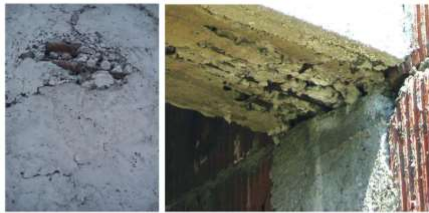
Figura 19: Patología del Concreto.
