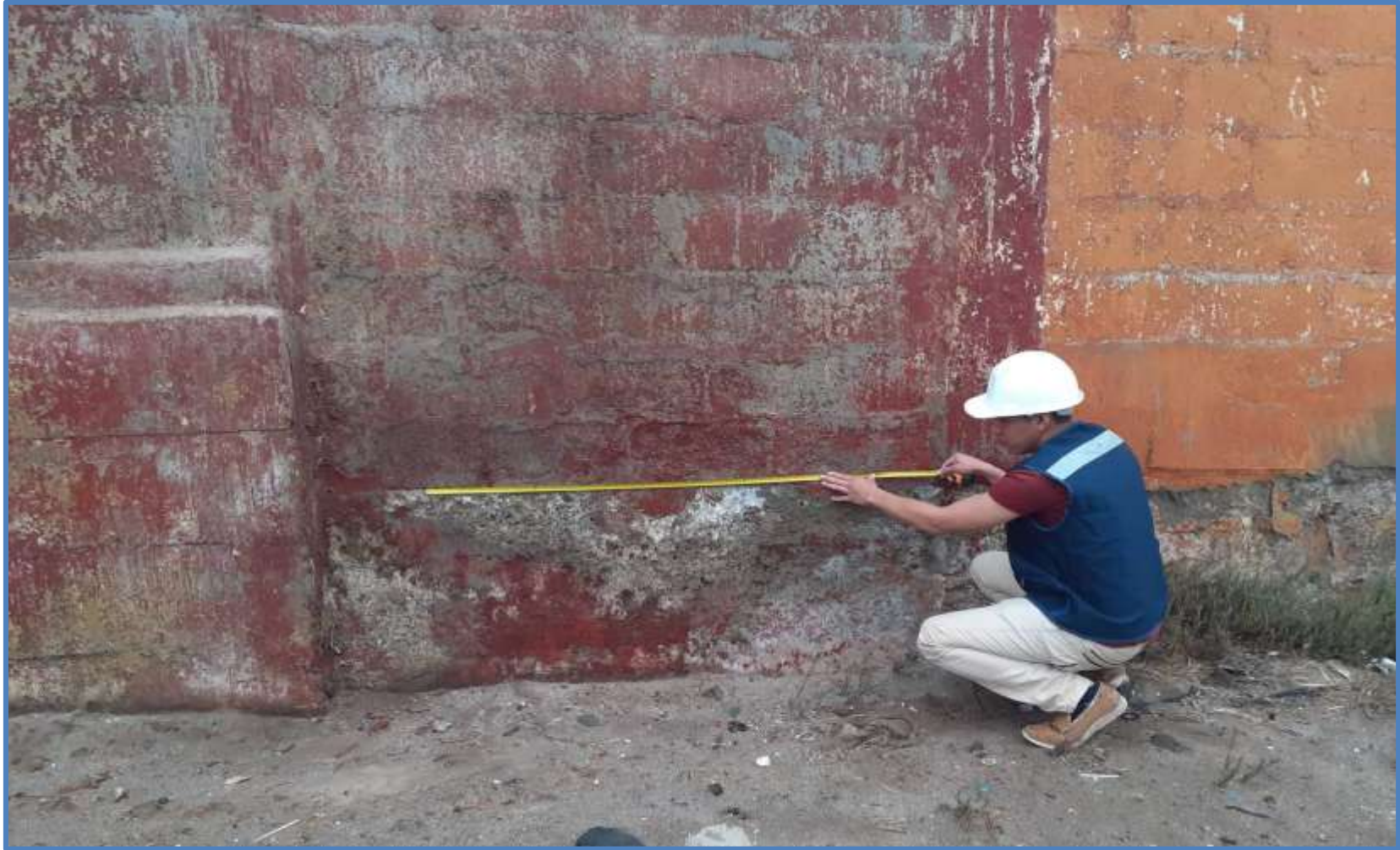
Imagen 3: Patología Eflorescencia presente en el Muro de la Unidad Muestral 06 del Depósito Pesquero Exalmar S.A. Fuente: Elaboración propia. (2019).
