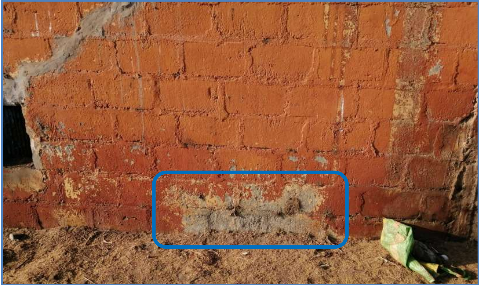
Imagen 11: Patología Eflorescencia presente en el Muro de la Unidad Muestral 12 del Depósito Pesquero Exalmar S.A.
