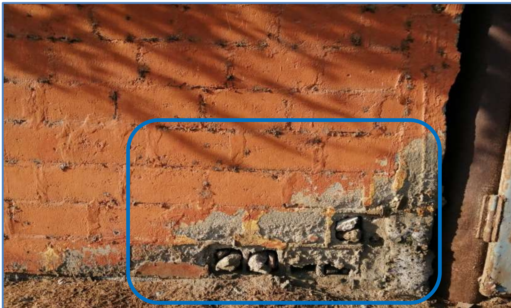
Imagen 10: Patología Erosión presente en el Muro de la Unidad Muestral 03 del Depósito Pesquero Exalmar S.A. Fuente: Elaboración propia. (2019).
