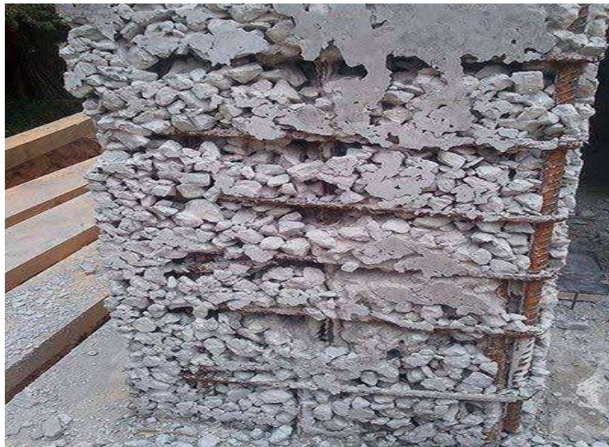
Figura 29: Desintegración del concreto en columna.
