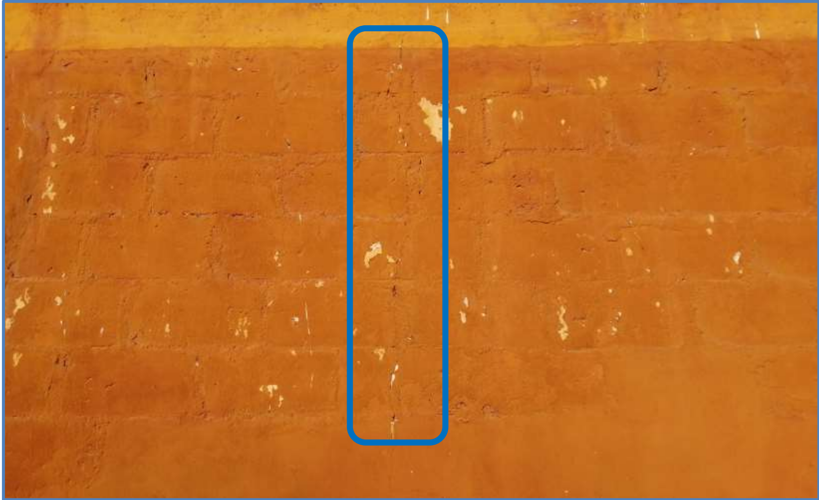
Imagen 8: Patología Fisura presente en el Muro de la Unidad Muestral 08 del Depósito Pesquero Exalmar S.A. Fuente: Elaboración propia. (2019).
