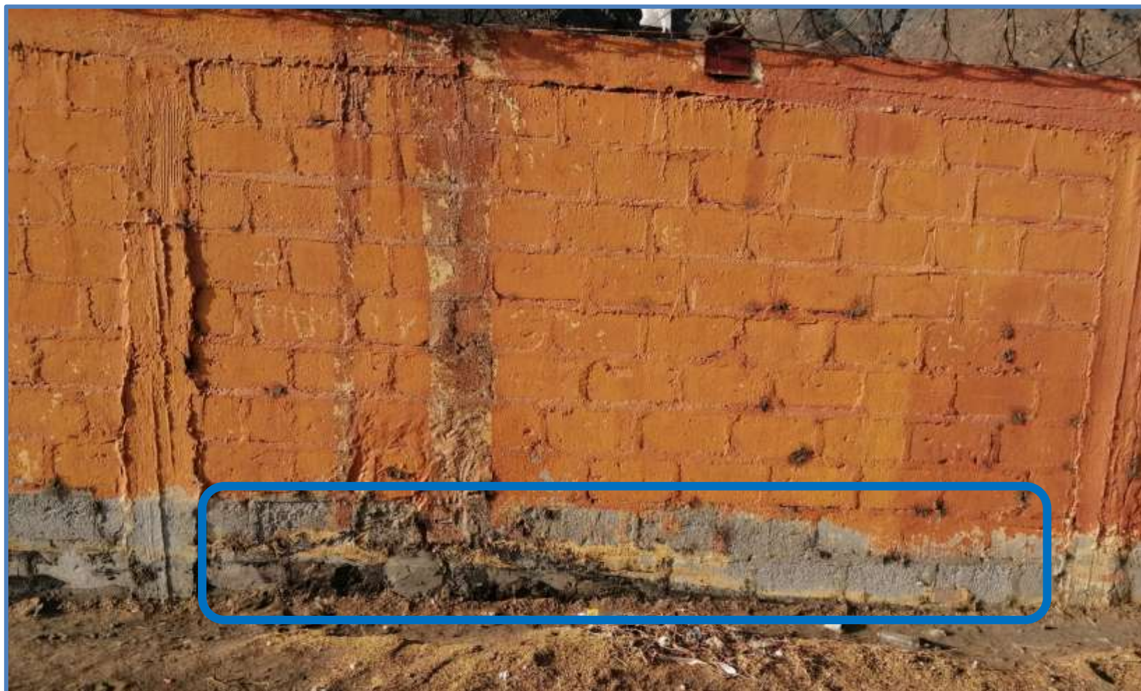
Imagen 6: Patología Erosión presente en el Muro de la Unidad Muestral 03 del Depósito Pesquero Exalmar S.A. Fuente: Elaboración propia. (2019).
