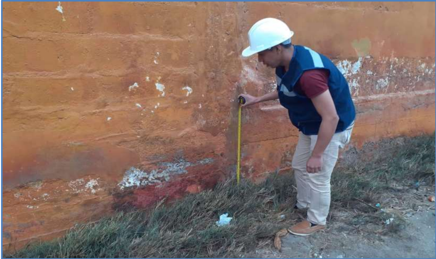
Imagen 5: Patología Grieta presente en el Muro de la Unidad Muestral 08 del Depósito Pesquero Exalmar S.A. Fuente: Elaboración propia. (2019).
