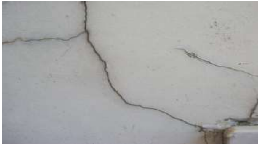
Figura 24: Grietas en un Muro.
