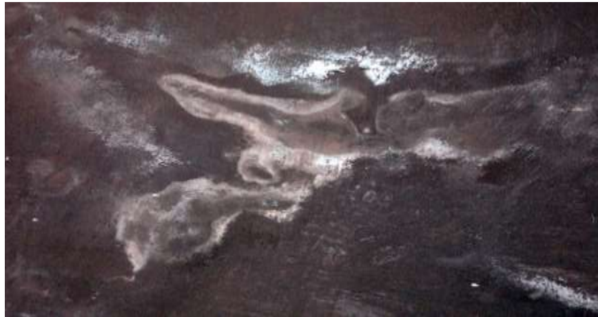
Figura 26: Eflorescencia en un Muro.
