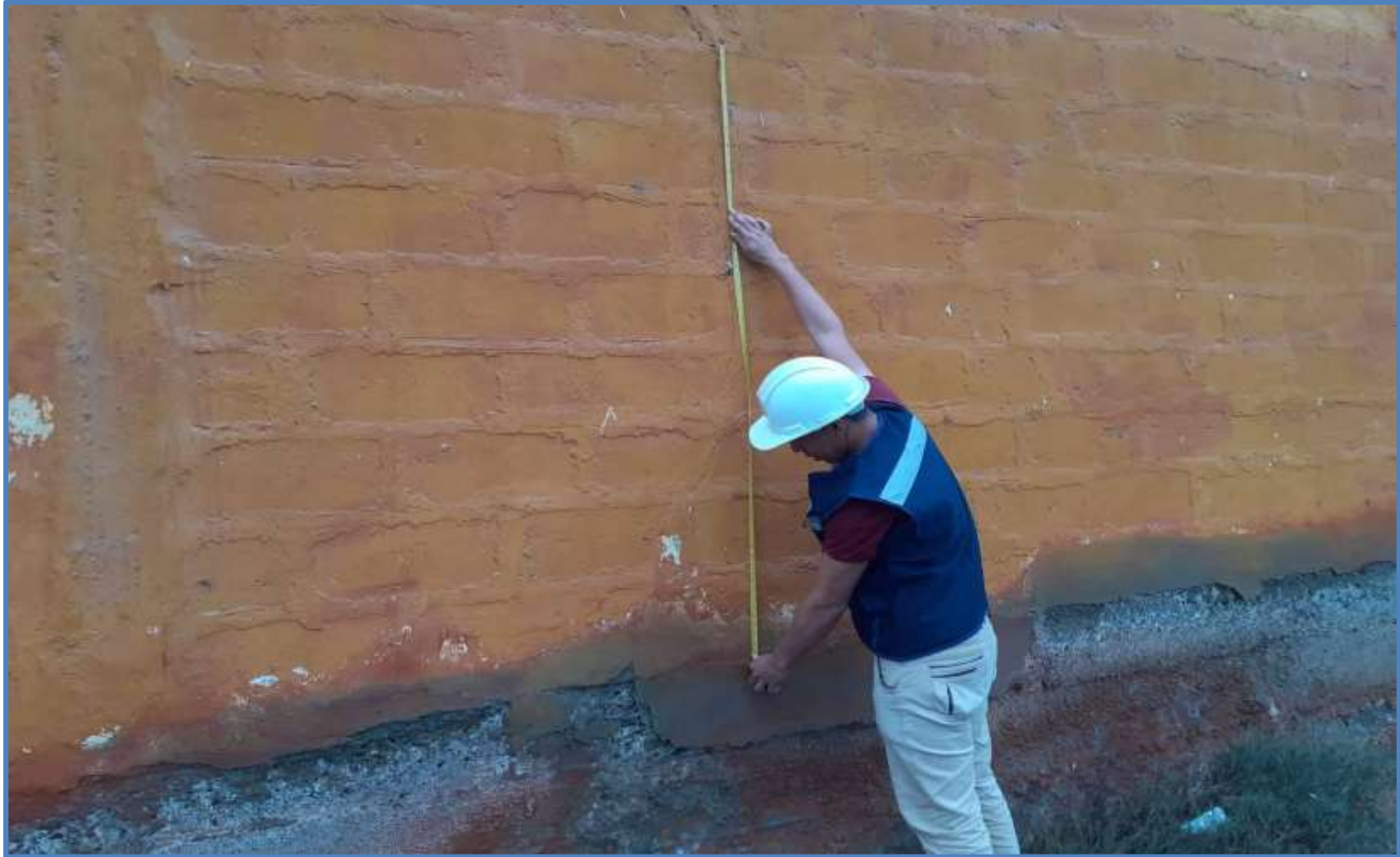
Imagen 4: Patología Fisura presente en el Muro de la Unidad Muestral 10 del Depósito Pesquero Exalmar S.A. Fuente: Elaboración propia. (2019).
