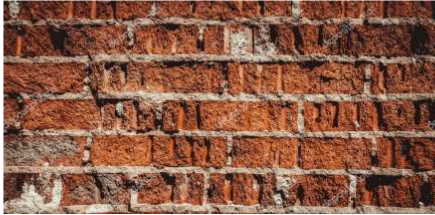
Figura 22: Erosión del ladrillo.
