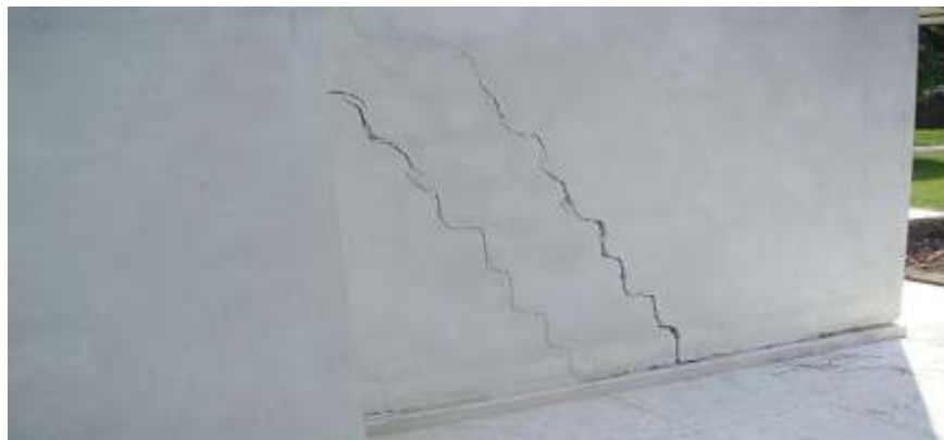
Figura 23: Fisuras en un Muro.
