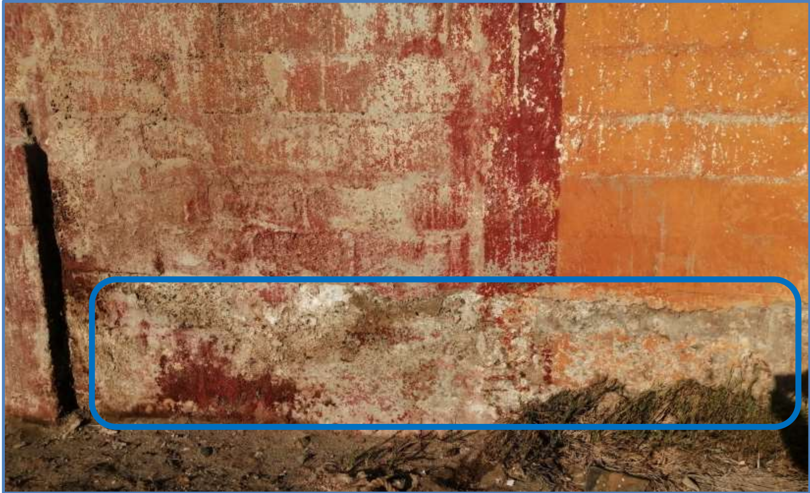
Imagen 7: Patología Eflorescencia presente en el Muro de la Unidad Muestral 04 del Depósito Pesquero Exalmar S.A. Fuente: Elaboración propia. (2019).
