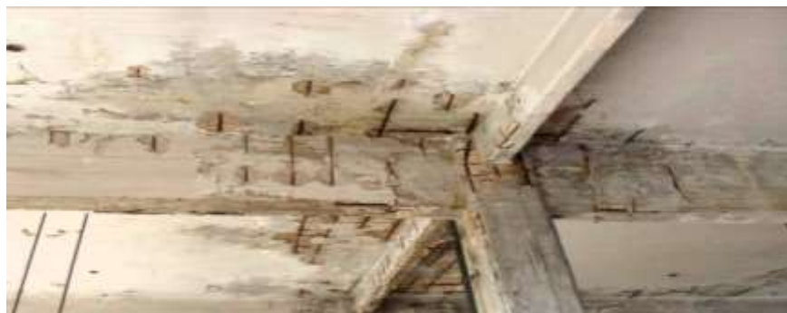
Figura 18: Patología del Concreto.
