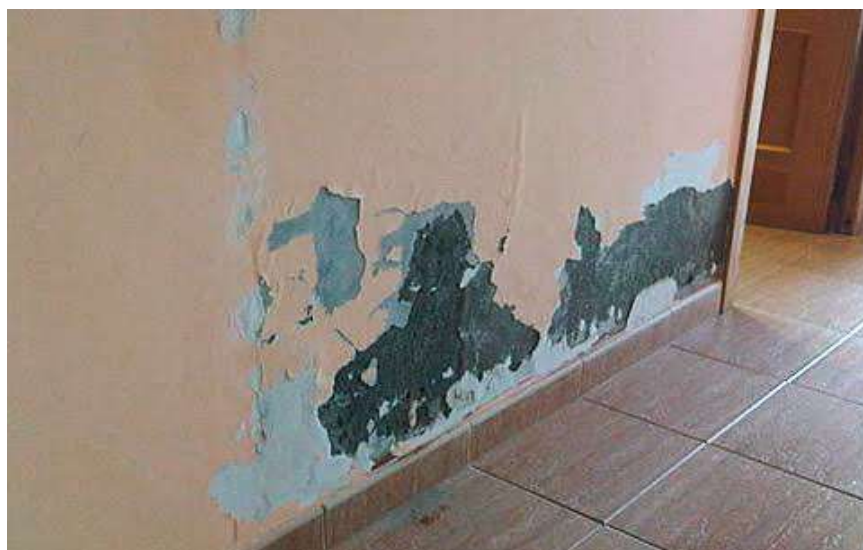
Figura 28: Desconchamiento en un Muro.
