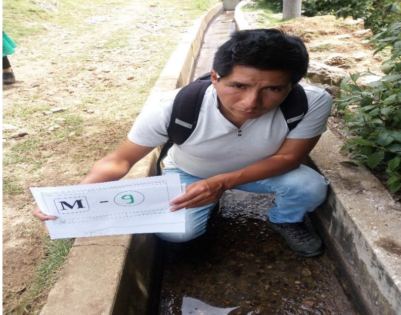
FOTOGRAFIA N° 10 : Patologías observadas en canal de riego Poyac – sector
