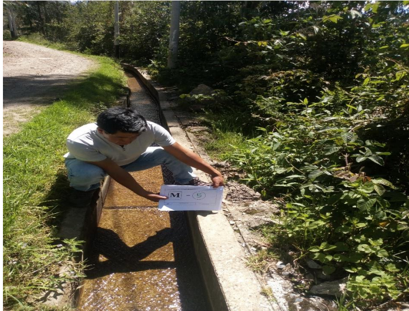
FOTOGRAFIA N° 08: Patologías observadas en canal de riego Poyac – sector
