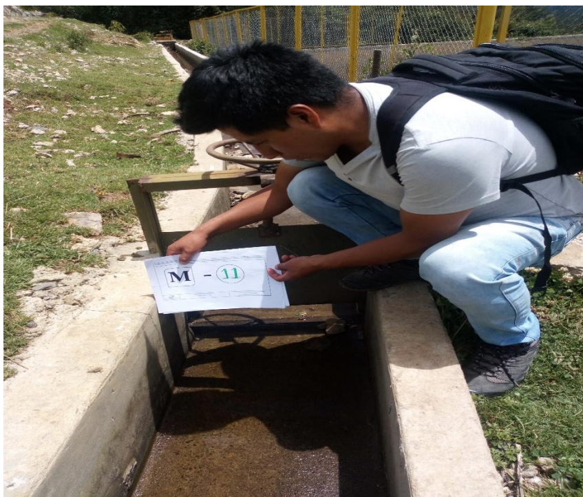
FOTOGRAFIA N° 12: Patologías observadas en canal de riego Poyac – sector
