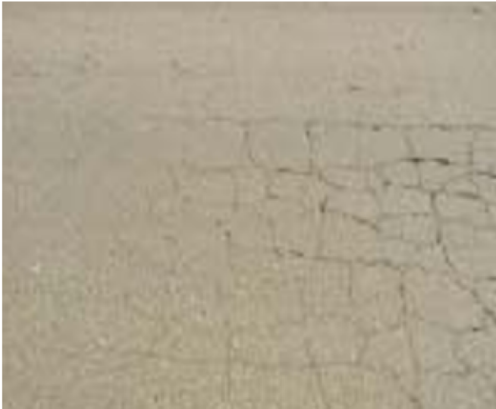
Figura 2.3: Fisuras y grietas en bloque.
