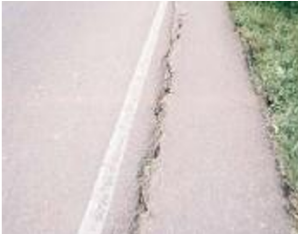
Figura 2.17: Deficiencia de sellado
