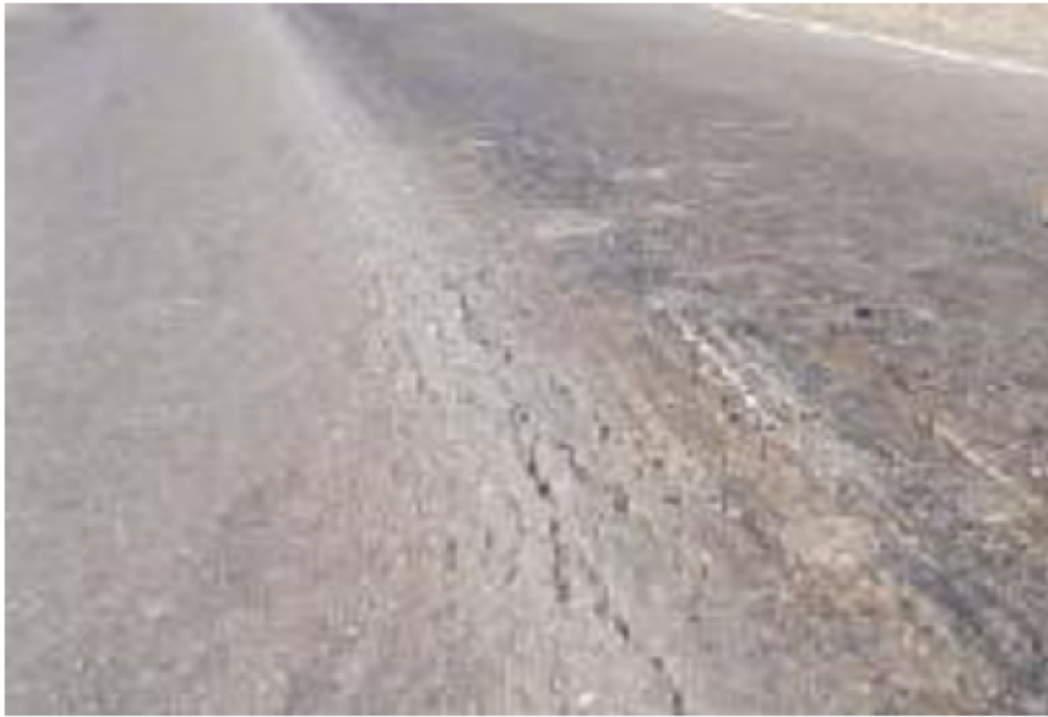
Figura 2.10: Deformación transversal. Fuente: (Deterioros en pavimentos flexibles y rígidos.)
