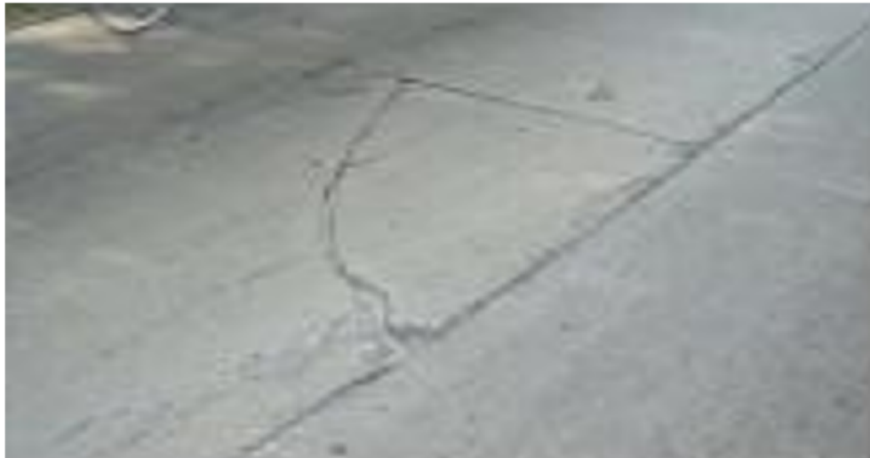
Figura 2.21: Grietas longitudinales. Fuente:(Deterioros en pavimentos flexibles y rígidos.)
