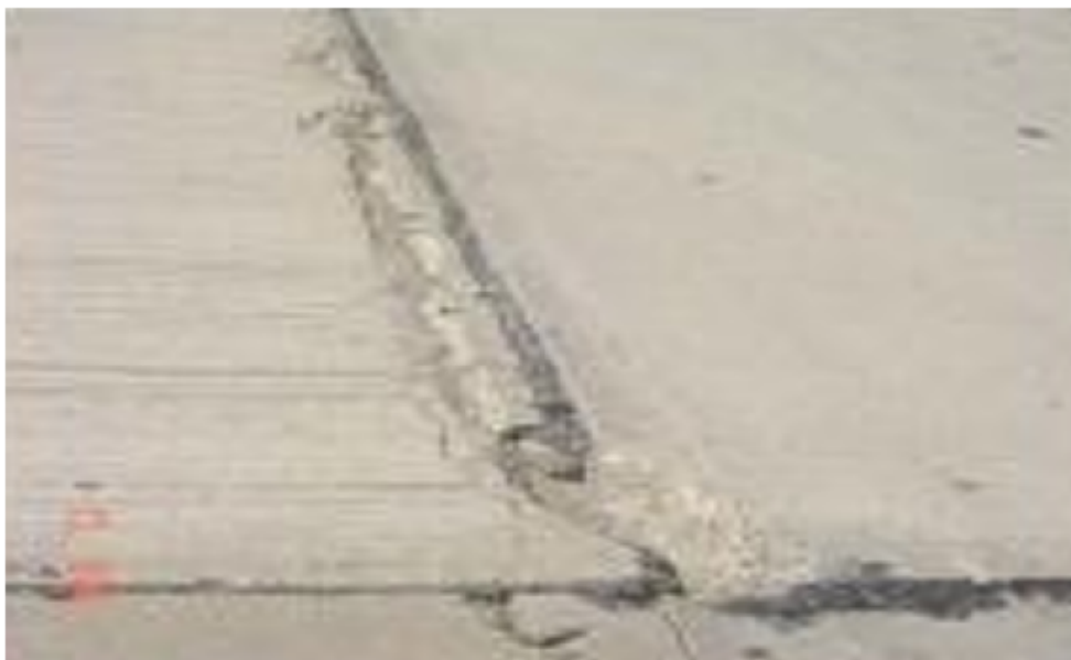
Figura 2.19: Separación de junta longitudinal.
