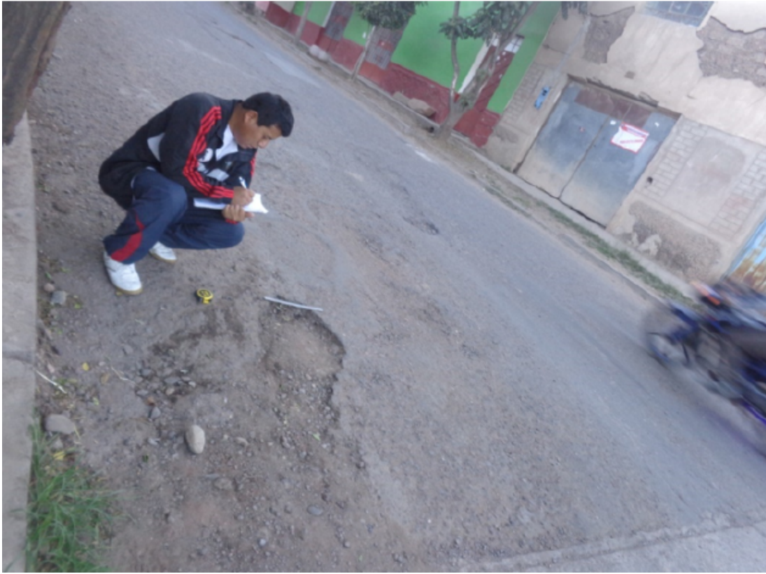
Fotografía 1: Patologías encontradas en la muestra.
