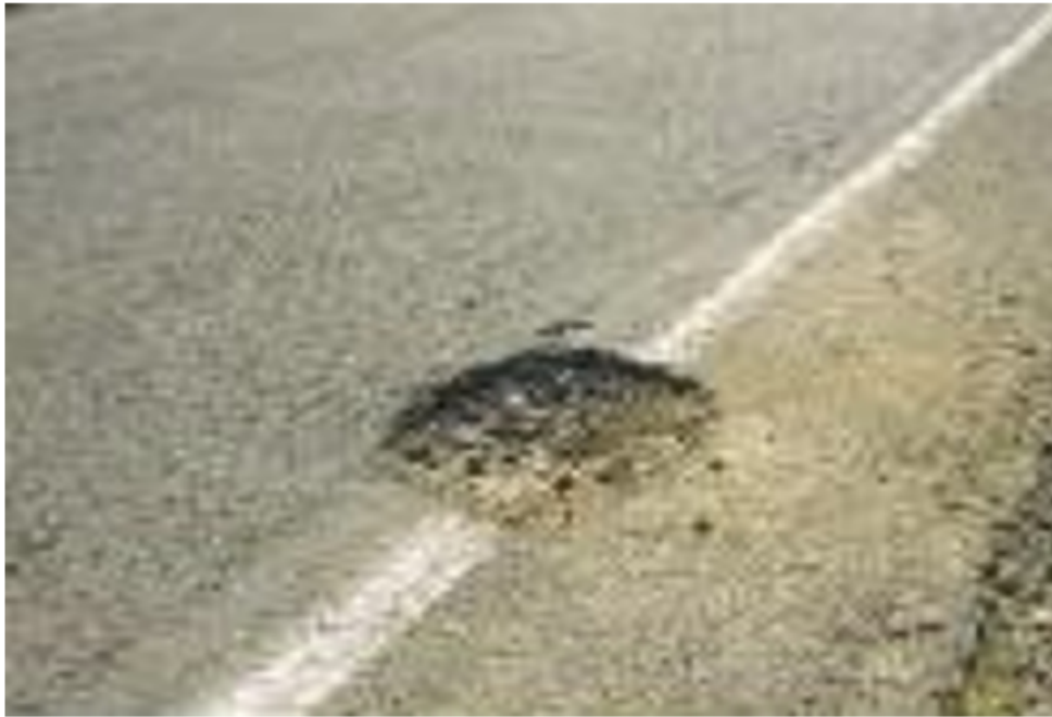
Figura 2.8: Baches en carpetas asfálticas .
