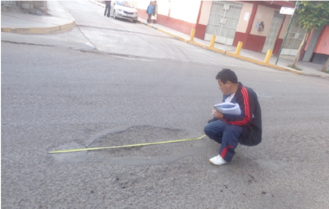
Fotografía 3: Patologías encontradas en la muestra.
