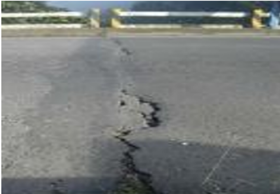
Figura 2.6: Fisuras y grietas reflejadas. Fuente: (Deterioros en pavimentos flexibles y rígidos.)
