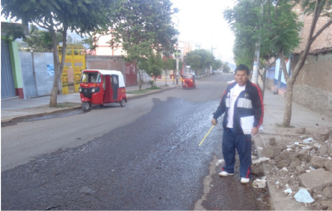
Fotografía 5: Patologías encontradas en la muestra.
