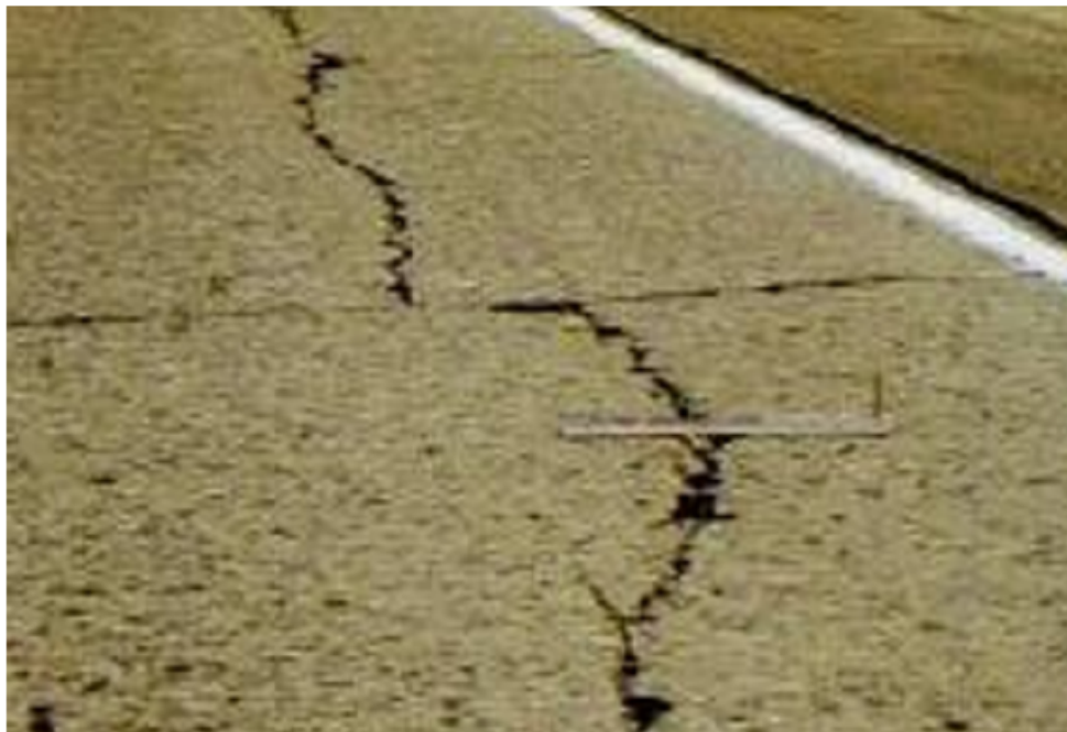
Figura 2.22: Grietas transversales. Fuente:(Deterioros en pavimentos flexibles y rígidos.)
