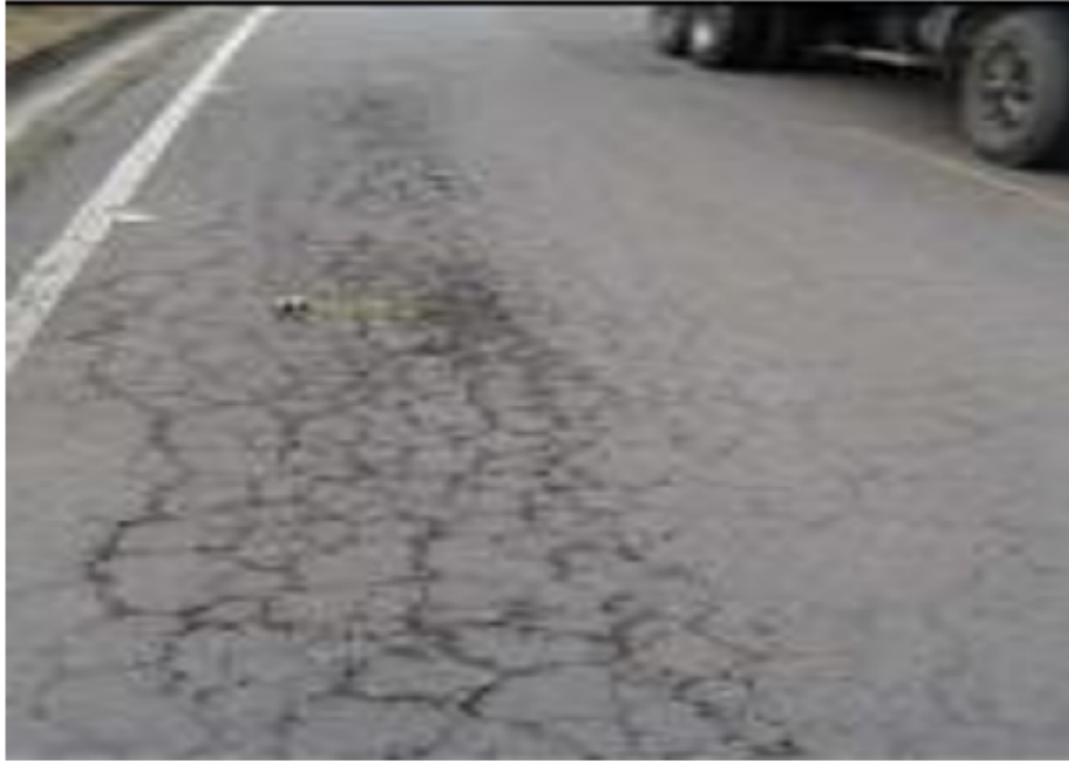
Figura 2.2: Fisuras y grieta por fatigamiento.
