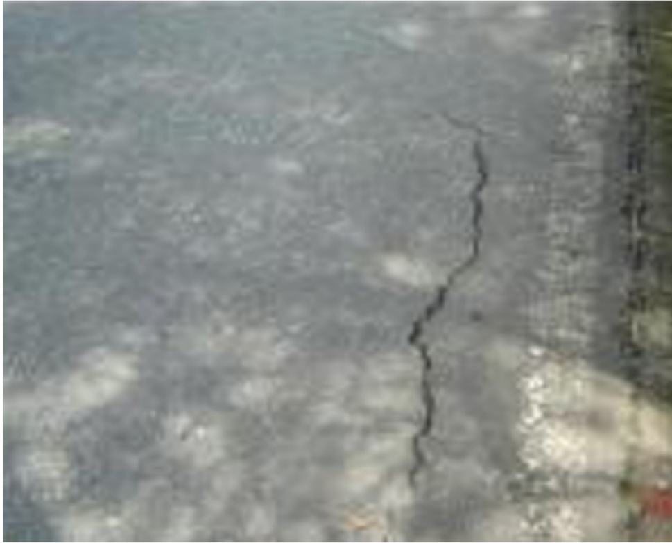
Figura 2.4: Grieta de borde.
