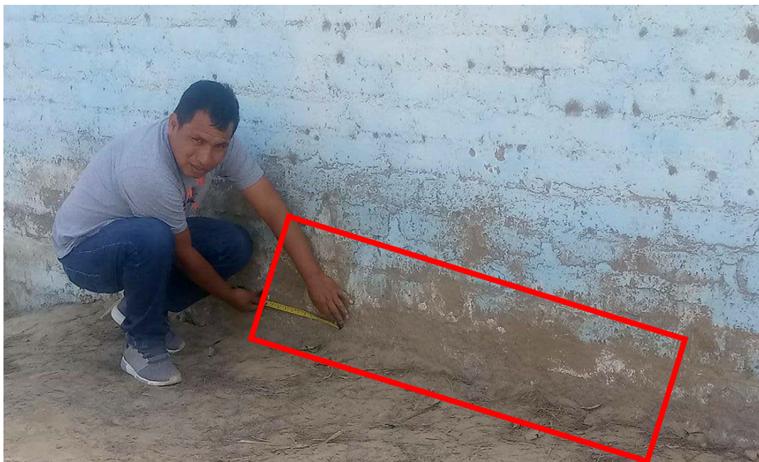
Fotografía 05: Muro afectado por erosión en la unidad muestral 06, con un área afectada de 23.54% y un nivel de severidad medio.
