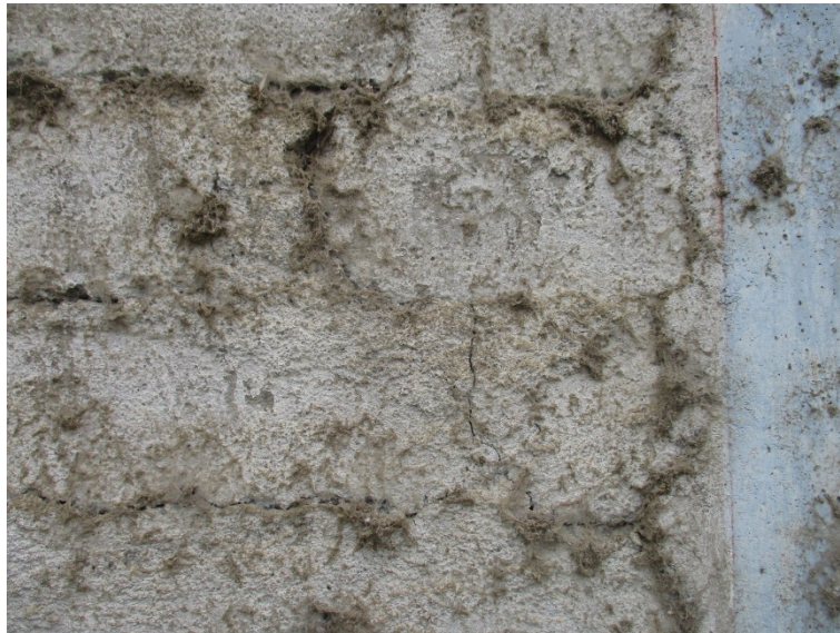
Figura 05. Imagen de fisura en muro.
