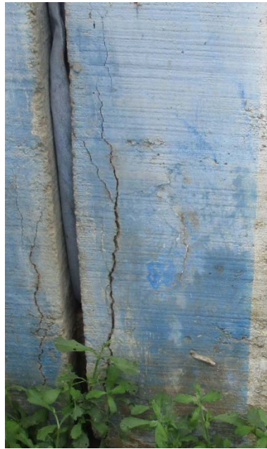
Figura 06. Imagen de grieta en muro.
