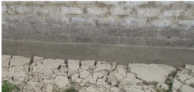
Figura 03. Imagen de desprendimiento en sobrecimiento.
