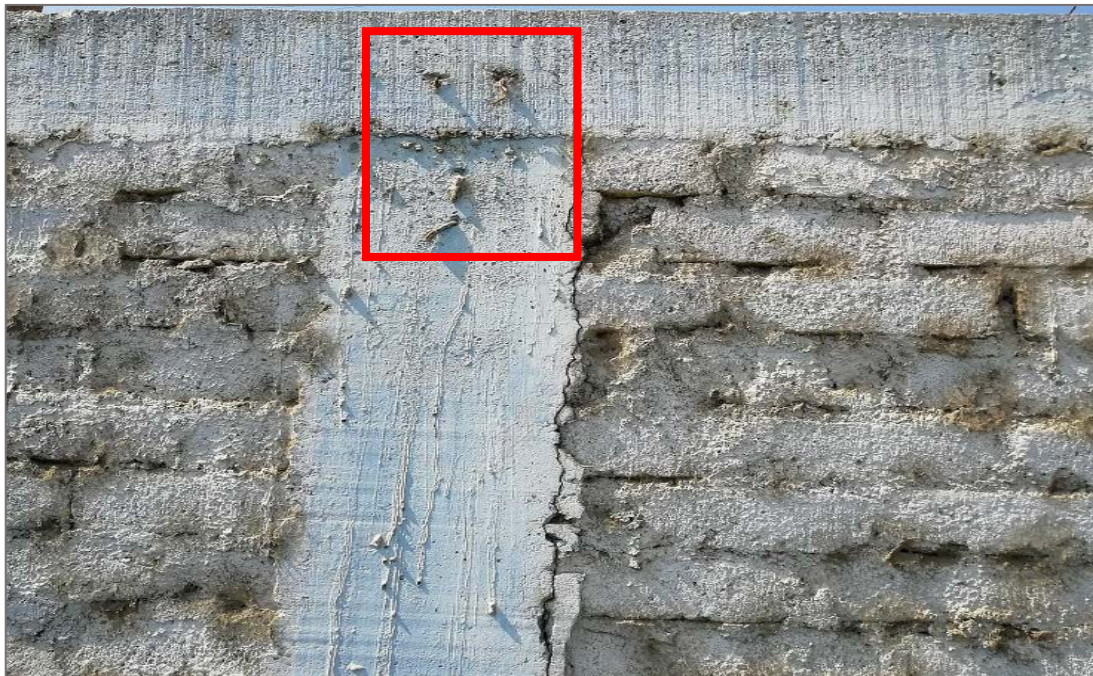
Fotografía 07: Columna afectada por corrosión en la unidad muestral 03, con un porcentaje de área afectada de 11.62% y un nivel de severidad medio.
