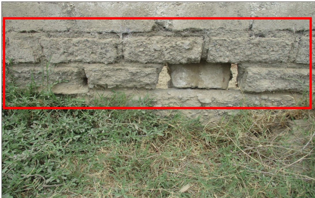
Fotografía 08: Muro afectado por desintegración en la unidad muestral 11, con un porcentaje de área afectada de 38.89% y un nivel de severidad medio.
