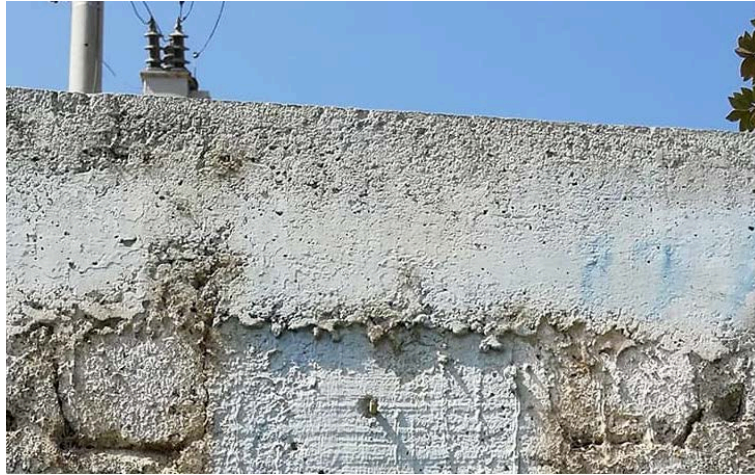
Figura 02. Imagen de erosión en viga.
