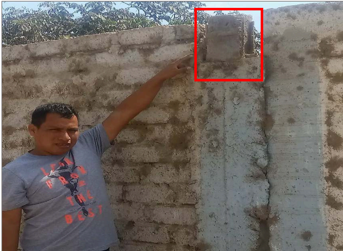
Fotografía 06: Columna afectada por corrosión en la unidad muestral 02, con un porcentaje de área afectada de 21.77% y un nivel de severidad medio.
