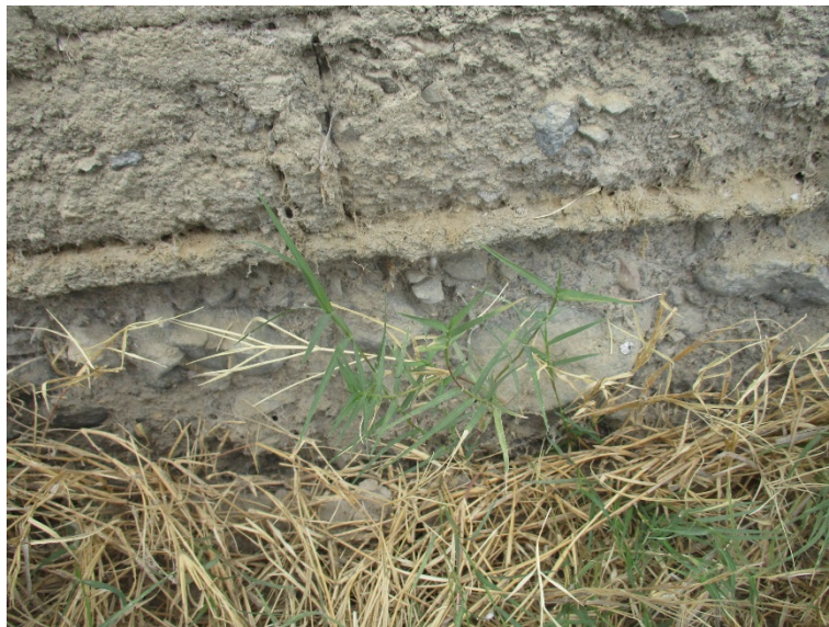
Figura 04. Imagen de desintegración en sobrecimiento y muro
