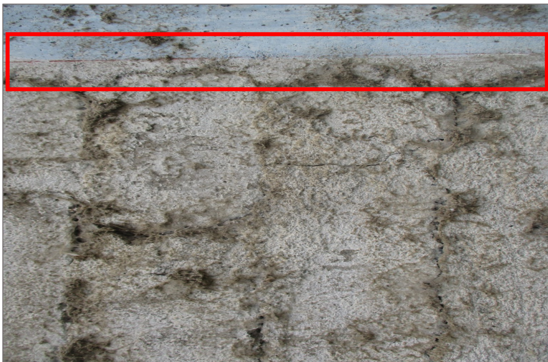
Fotografía 09: Viga afectada por fisura en la unidad muestral 02 con un ancho de 0.25 mm y un nivel de severidad medio.
