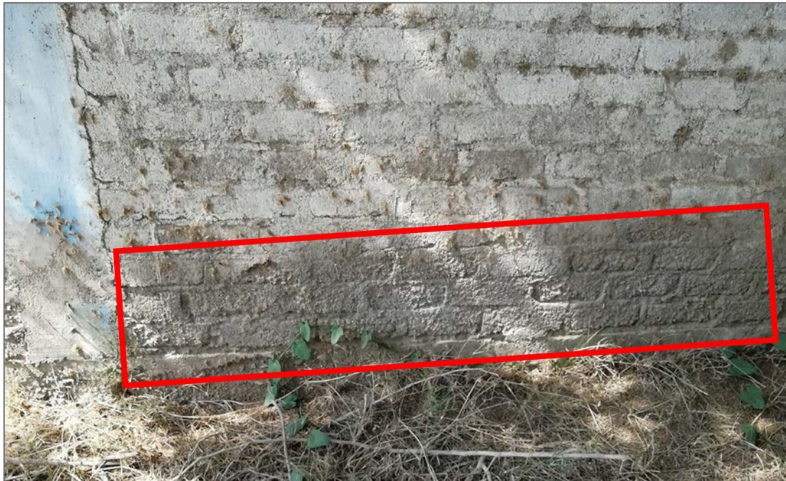
Fotografía 04: Muro afectado por erosión en la unidad muestral 03, con un área afectada de 17.78% y un nivel de severidad medio.
