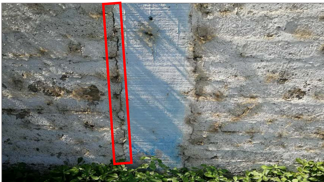
Fotografía 03: Muro afectado por grieta en la unidad muestral 17, con un ancho de 2.40 mm y un nivel de severidad alto, medida con un medidor de cinta métrica.
