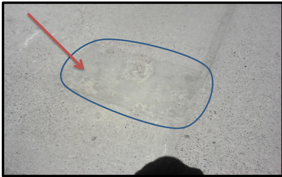
Fotografía N° 06: Se observa la existencia de la patología parche pequeño.
