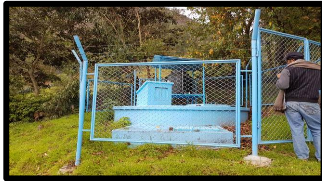
Ilustración 15: Reservorio Existente en regular estado de conservación
