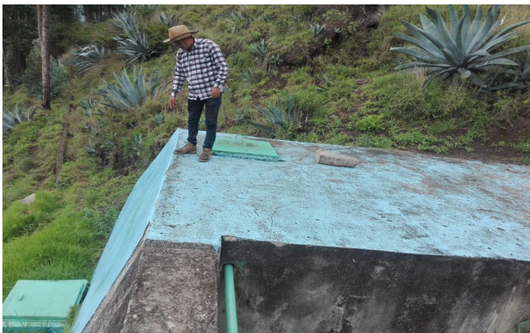
Ilustración 27: Reservorio de almacenamiento de agua para el consumo humano.
