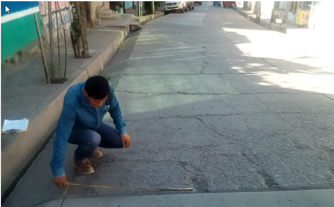
Fotografía 4: Patologías observadas en el pavimento evaluado.
