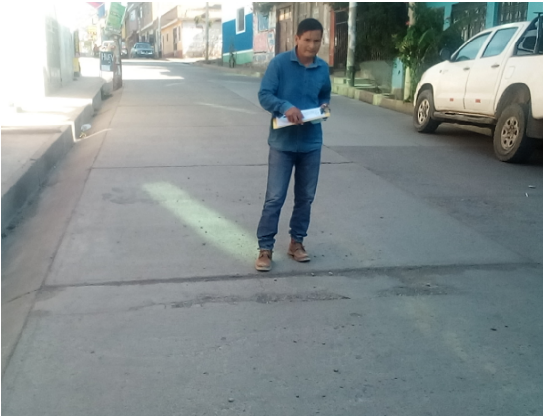
Fotografía 2: Patologías observadas en el pavimento evaluado.
