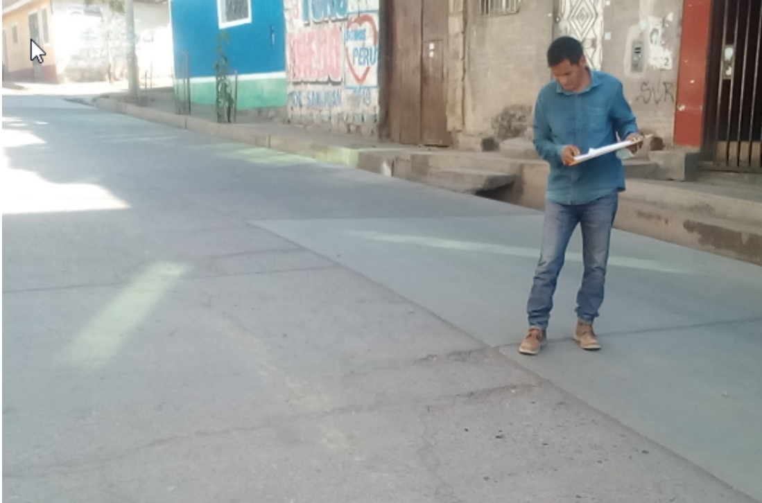
Fotografía 3: Patologías observadas en el pavimento evaluado.
