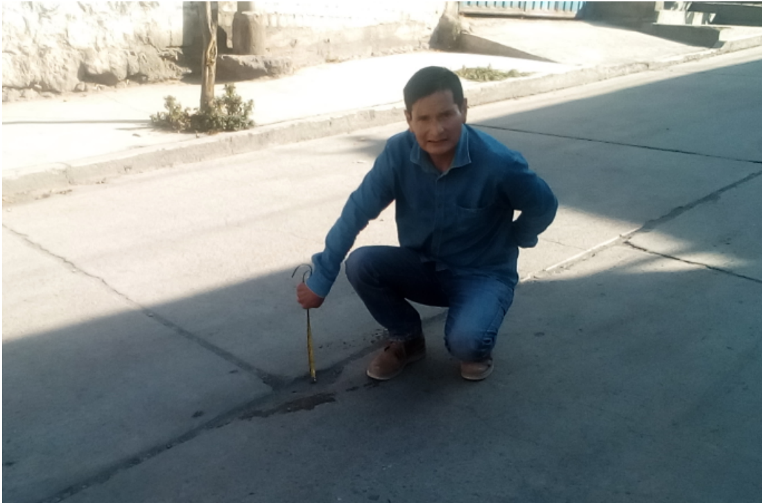
Fotografía 5: Patologías observadas en el pavimento evaluado.
