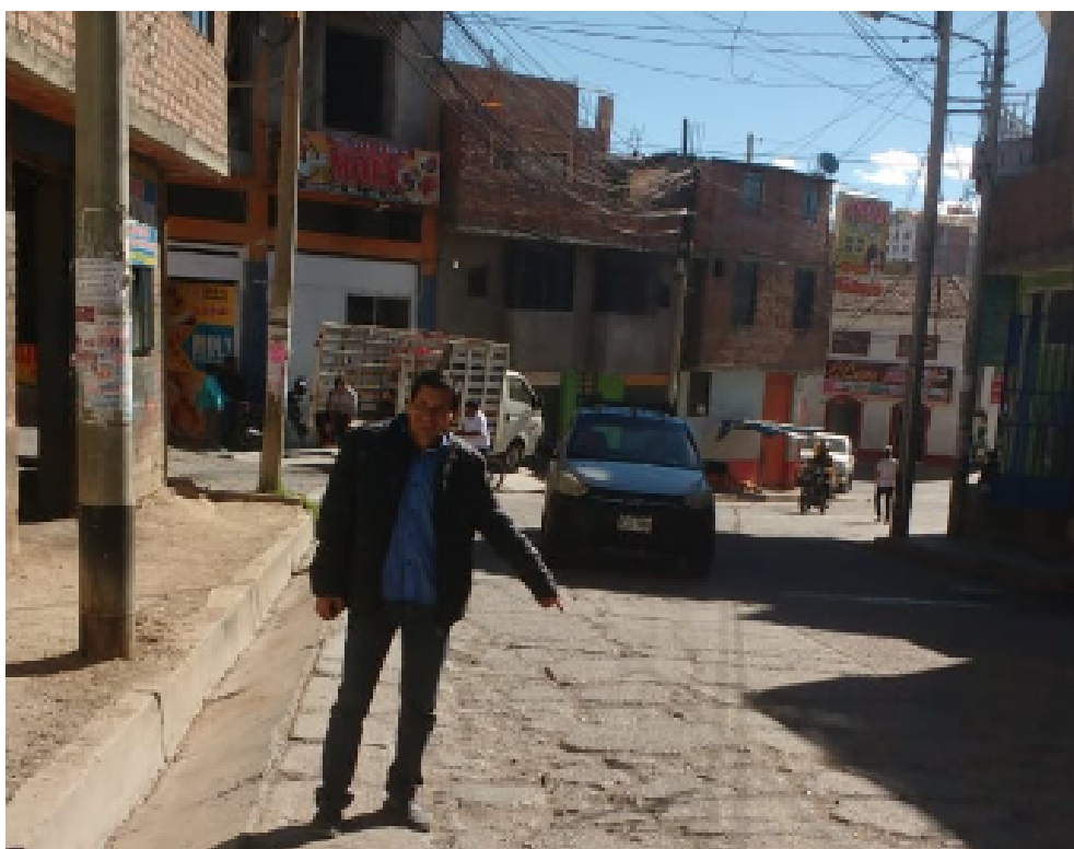
Fotografía 8: Patologías observadas en el pavimento evaluado.
