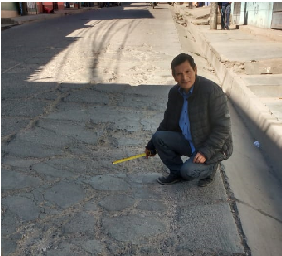
Fotografía 7: Patologías observadas en el pavimento evaluado.
