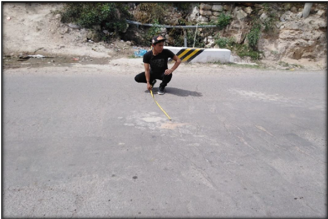
Fotografía 8: Falla tipo grieta longitudinal y transversal encontrado en el Km 187+090.
