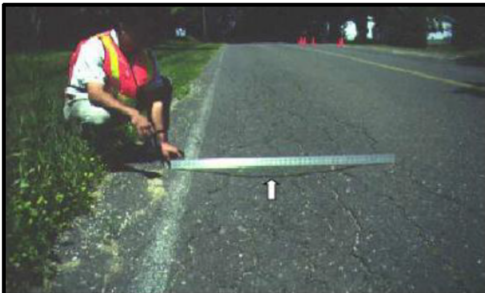
Figura 2.10: Patología por depresión.
