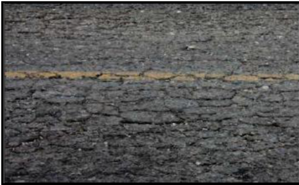
Figura 2.5: Patología piel de cocodrilo.
