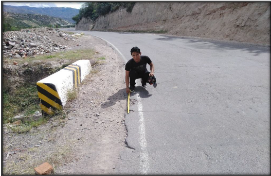
Fotografía 3: Falla tipo grieta borde encontrado en el Km 186+180.
