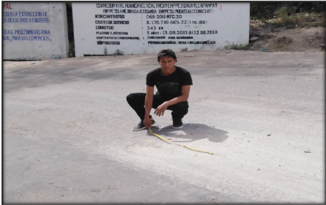
Fotografía 7: Falla tipo desprendimiento de los agregados encontrado en el Km 186+780.
