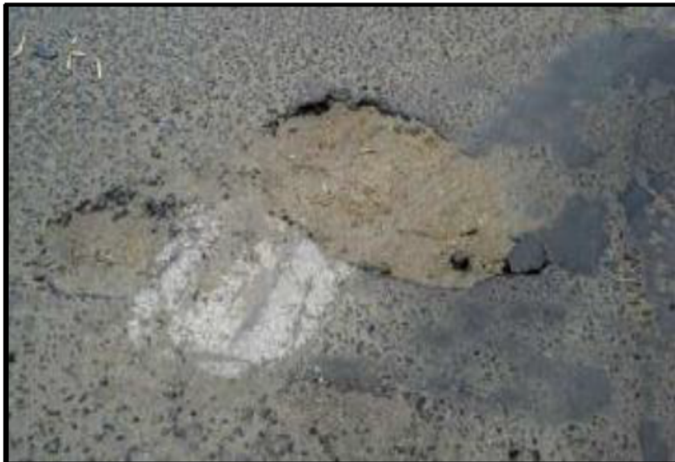
Figura 2.11: Patología por baches.
