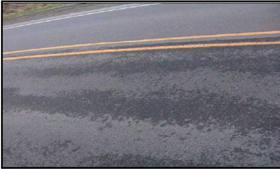
Figura 2.6: Patología por exudación.
