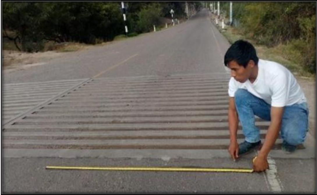
Fotografía 1: Falla tipo pulimiento.
