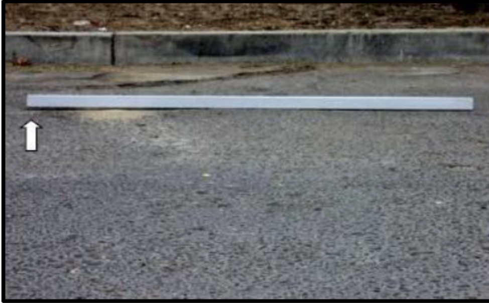
Figura 2.8: Patología por abultamiento y hundimiento.
