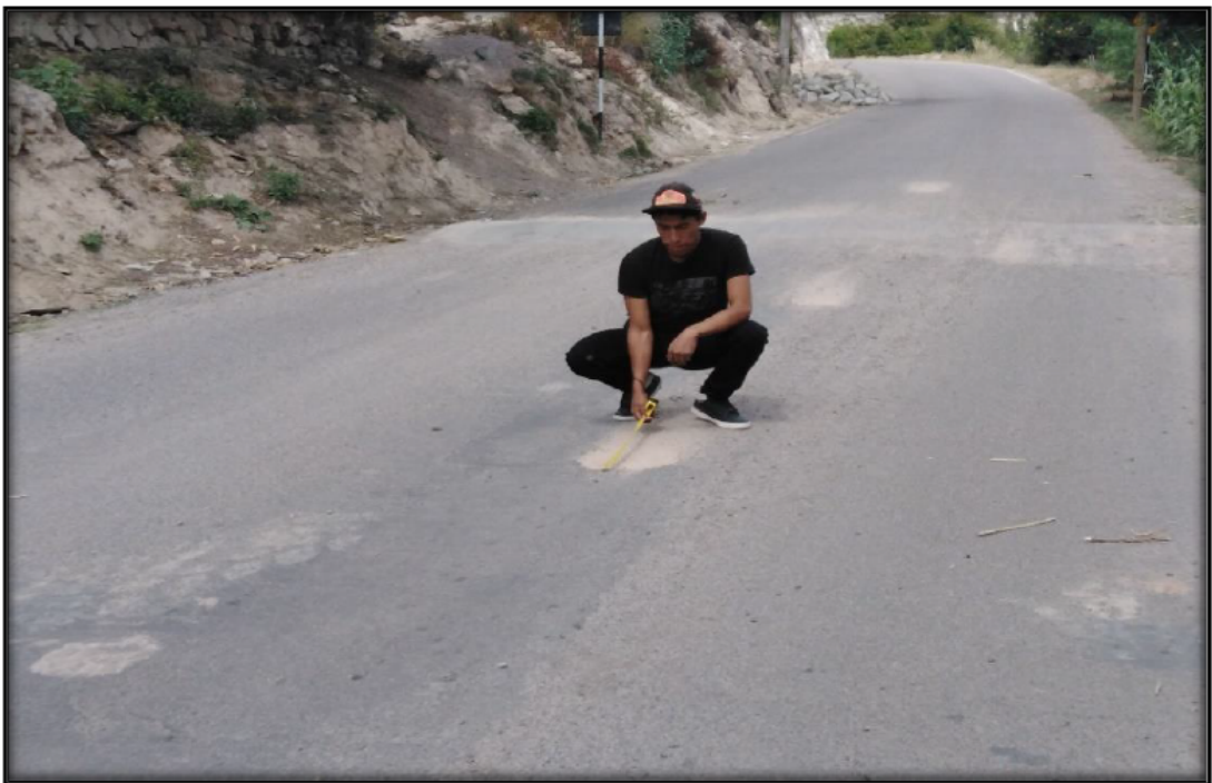
Fotografía 6: Falla tipo baches encontrado en el Km 186+580.
