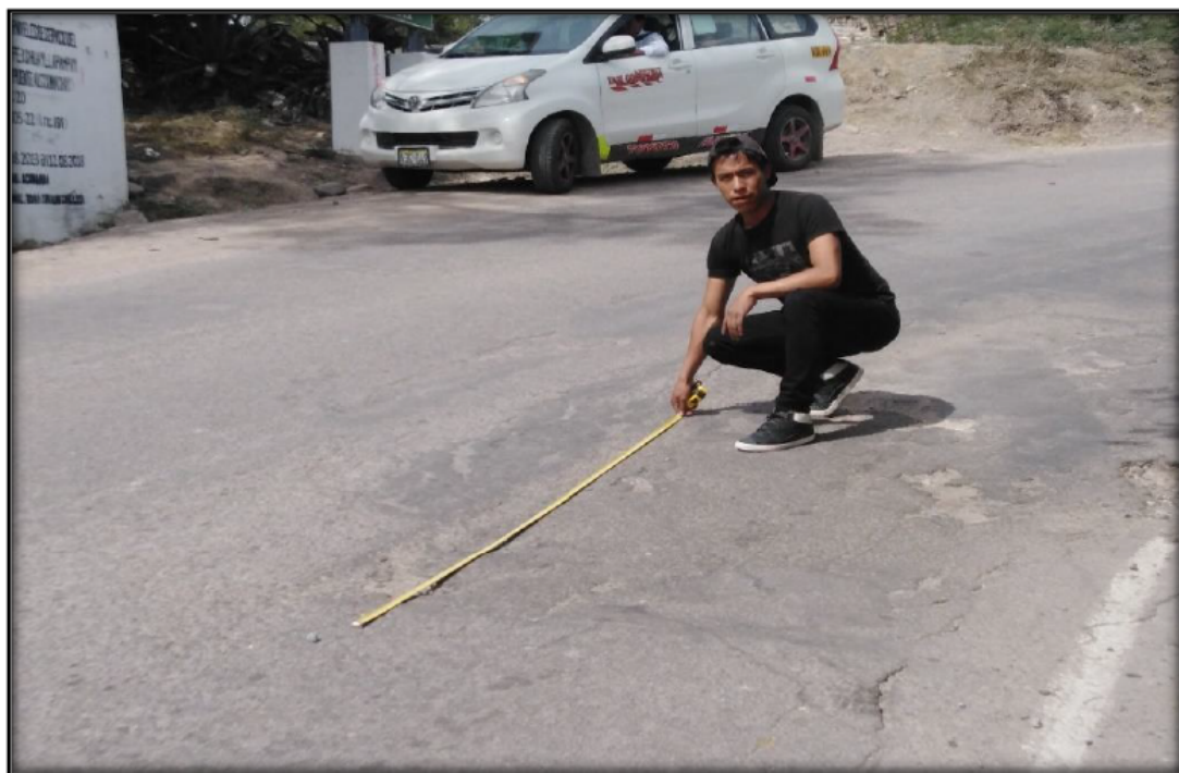
Fotografía 4: Falla tipo piel de cocodrilo encontrado en el Km 186+360.
