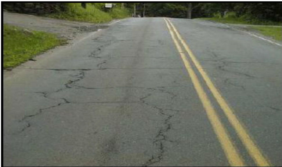
Figura 2.7: Patología por agrietamiento en bloque.
