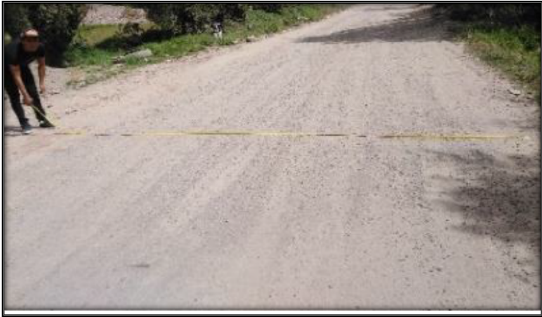
Fotografía 5: Falla tipo desprendimiento de los agregados.
