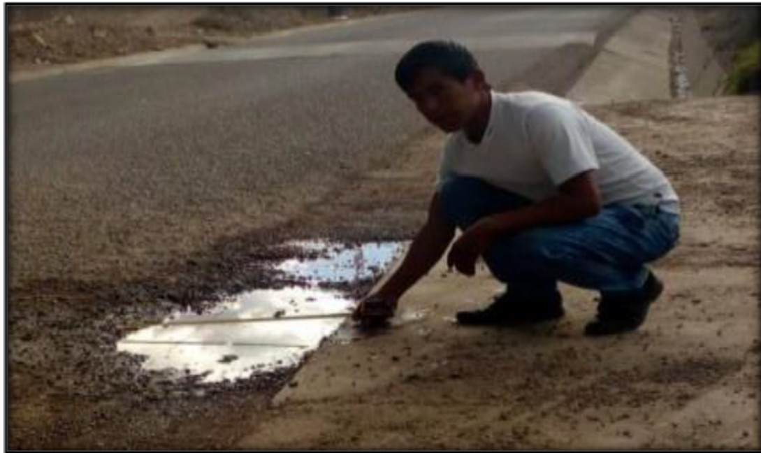
Fotografía 2: Falla tipo baches encontrado en el Km 186+142.
