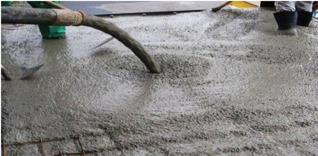
Figura 2.19: Exudación de concreto. Fuente:(Elaboración propia ).
