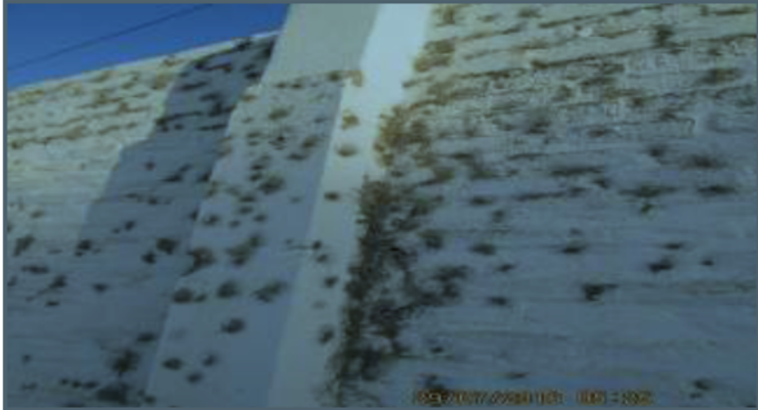
Figura 2.27: Suciedad de fachadas.
