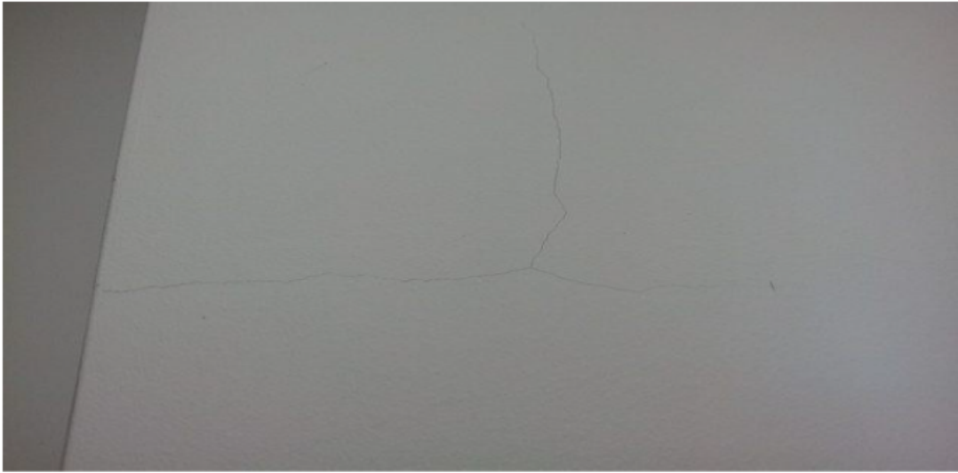
Figura 2.20: Fisura en el concreto. Fuente: (Elaboración propia ).
