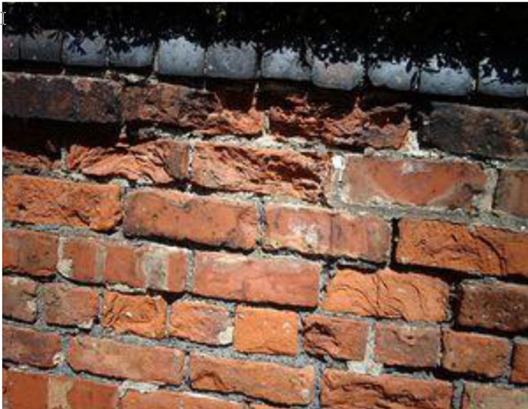
Figura 2.18: Erosión. Fuente:(Elaboración propia ).
