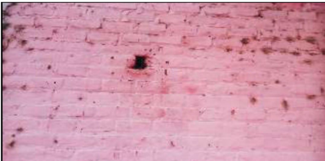
Figura 2.26: Picaduras en muros. Fuente:(Elaboración propia ).
