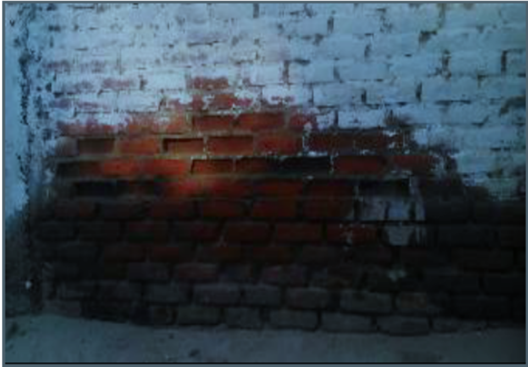
Figura 2.22: Humedad en los muros.
