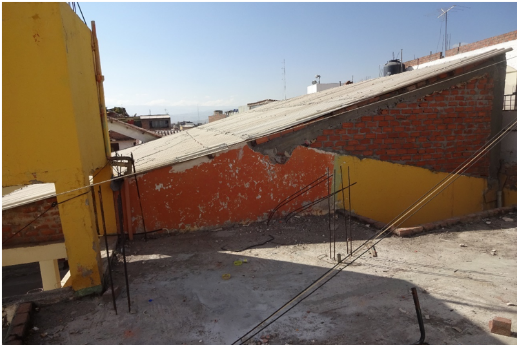
Fotografía 10: Se observa tarragia de 2" a 3" pulgadas en el muro de la segunda planta.
