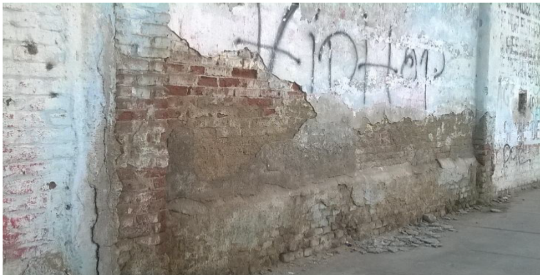
Figura 2.15: Desprendimiento de tarrajeo en muro.
