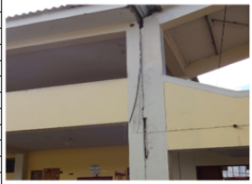
Figura 5.44: Gráfico de las patologías encontradas en la muestra 6
