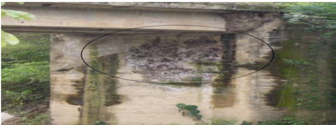
Figura 2.16: Eflorescencia. Fuente:(Elaboración propia ).
