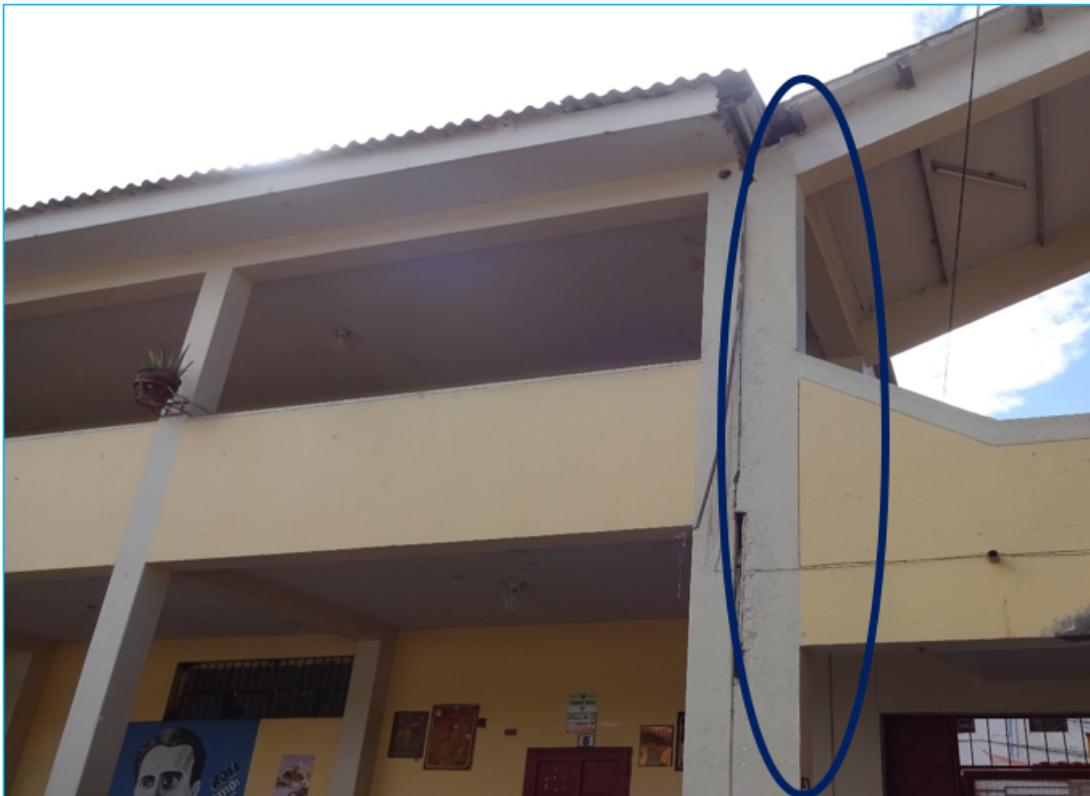
Fotografía 8: Se observa una grieta entre la columna vertical y la junta.
