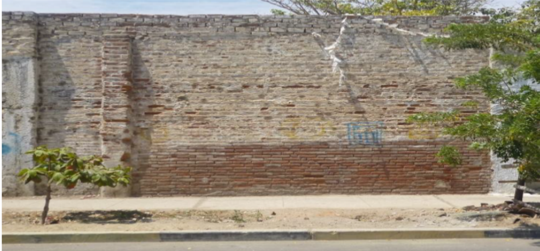
Figura 2.6: Humedad por capilaridad. Fuente:(Elaboración propia, 2019).
