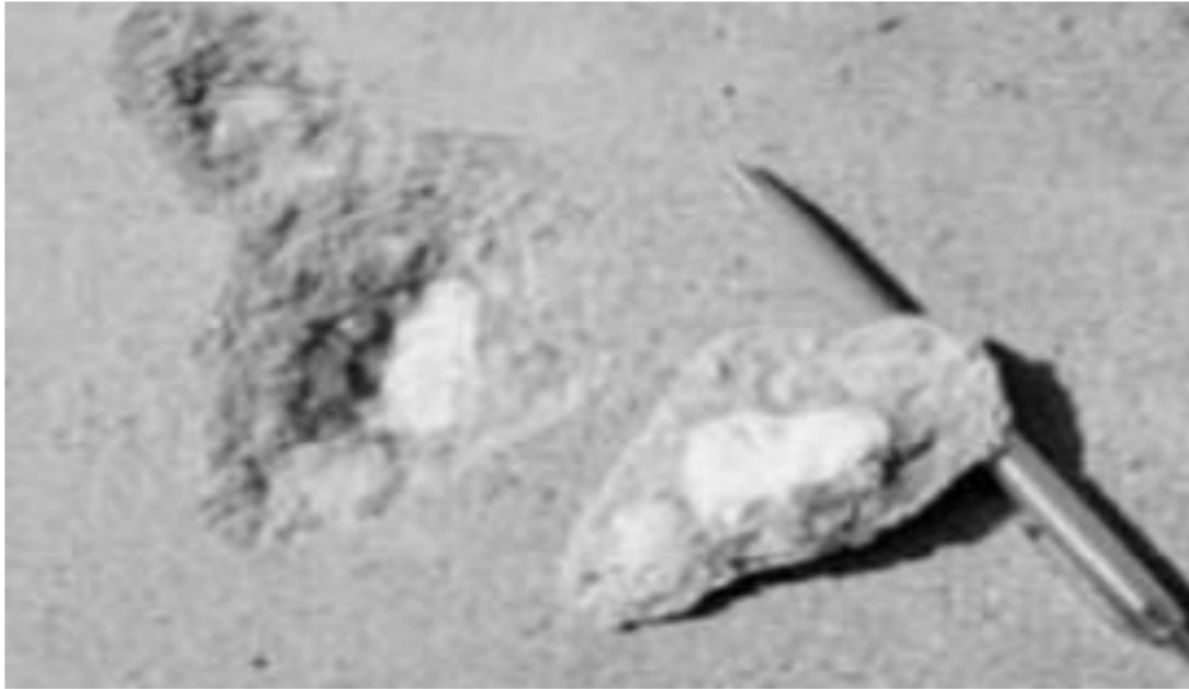
Figura 2.25: Popouts o cráteres en el concreto. Fuente:(Elaboración propia ).
