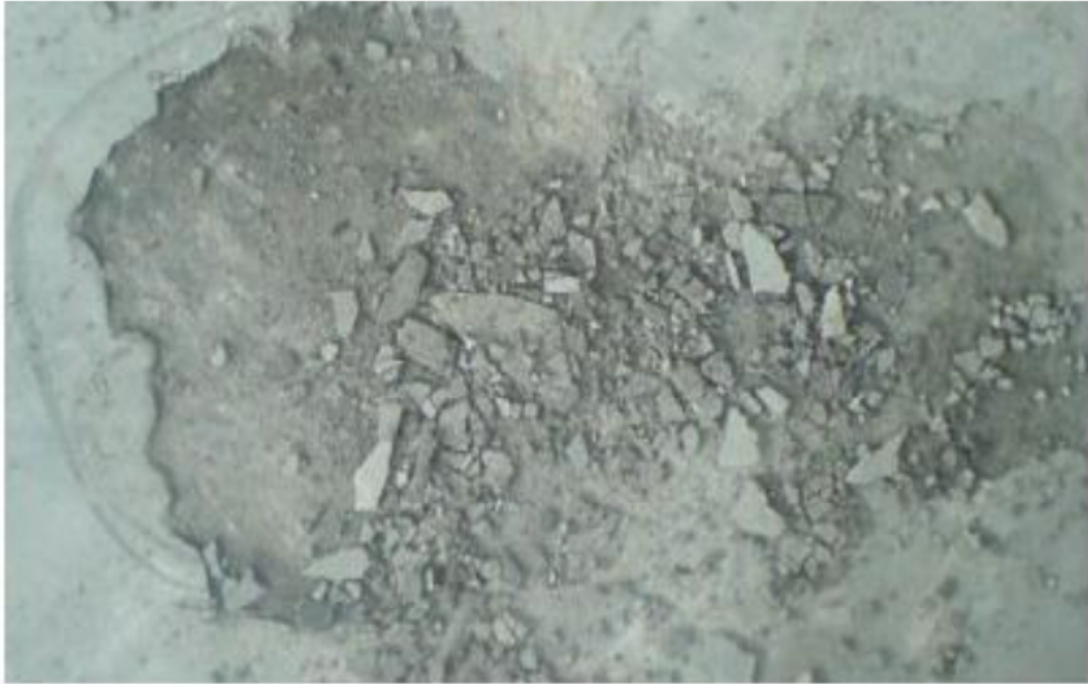
Figura 2.12: Delaminación. Fuente:(Imagen propia de investigación).
