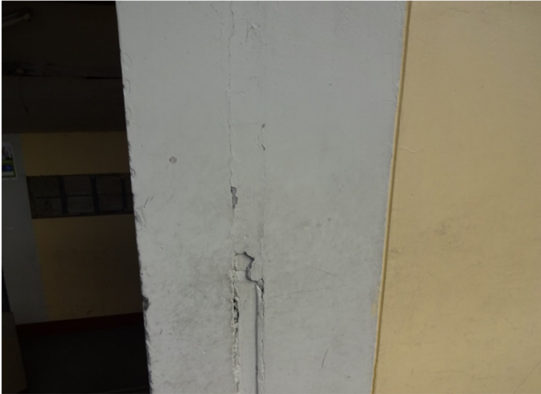
Fotografía 7: Se observa una grieta de la separación entre la columna vertical.
