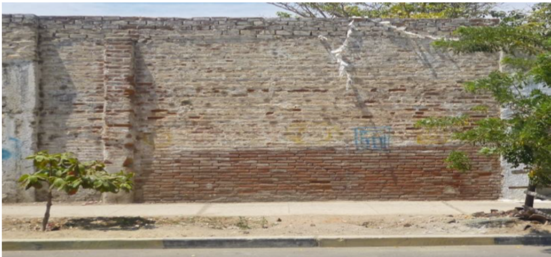
Figura 2.7: Humedad por capilaridad. Fuente:(Elaboración propia, 2019).
