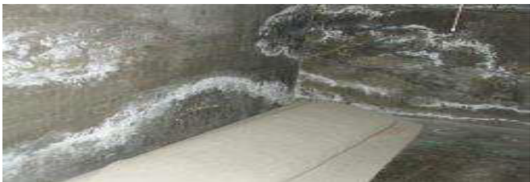
Figura 2.17: Imagen de eflorescencia en muros. Fuente:(Elaboración propia ).
