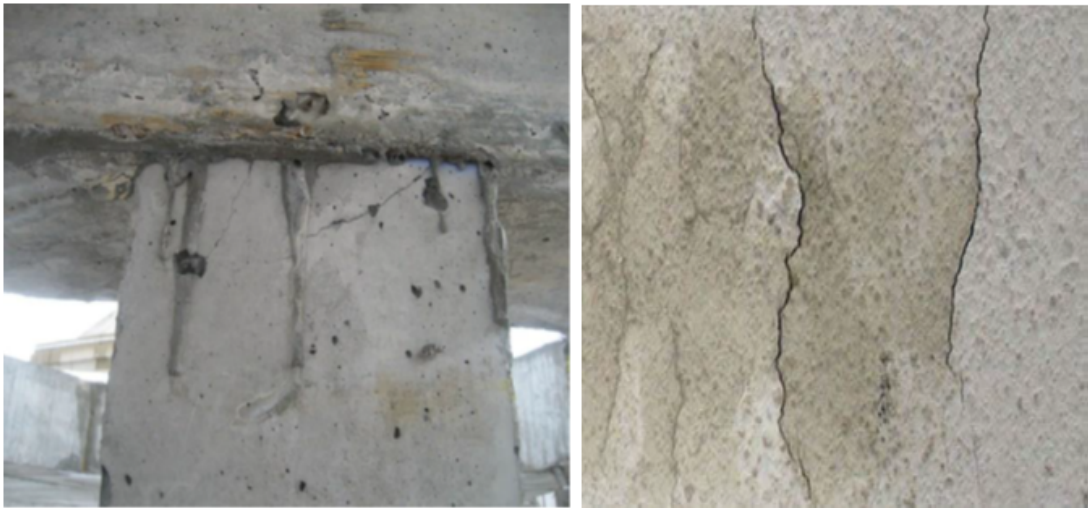
Figura 2.21: Imagen de fisuras en muros. Fuente: (Elaboración propia ).
