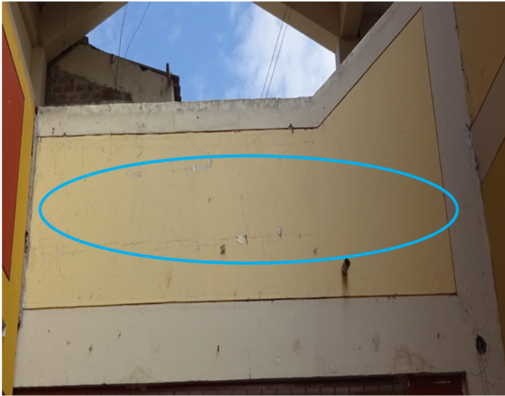
Fotografía 9: Se observa fisura vertical en el muro de la segunda planta.
