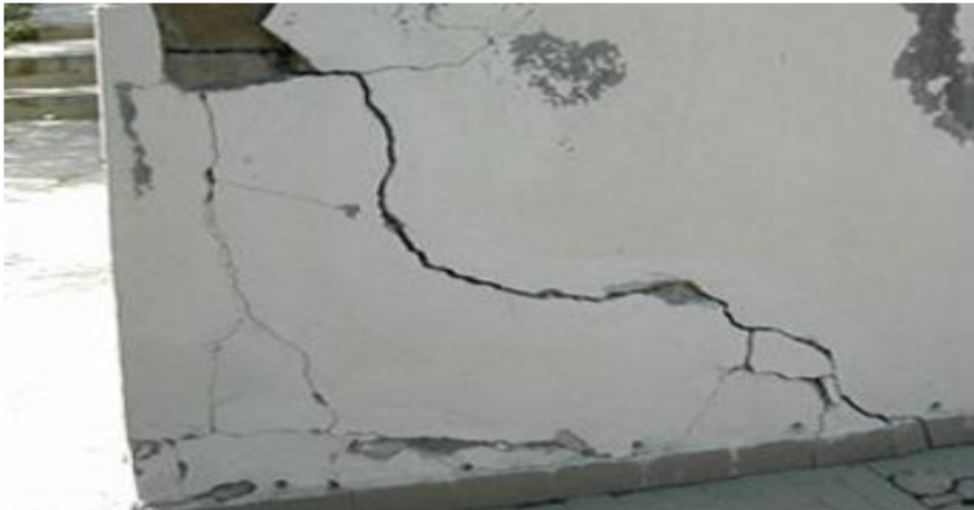
Figura 2.23: Agrietamiento en el concreto.
