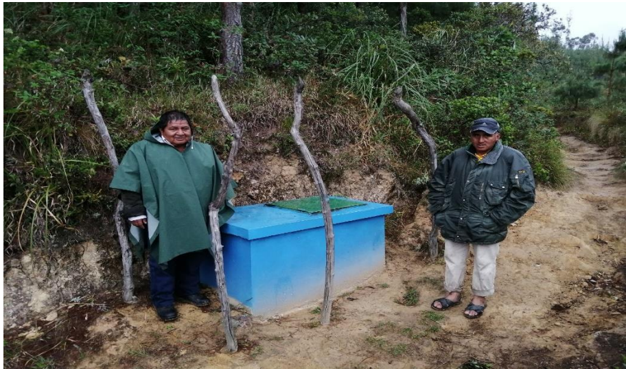
Imagen 14: Cámara Rompe Presión en línea de Distribución
