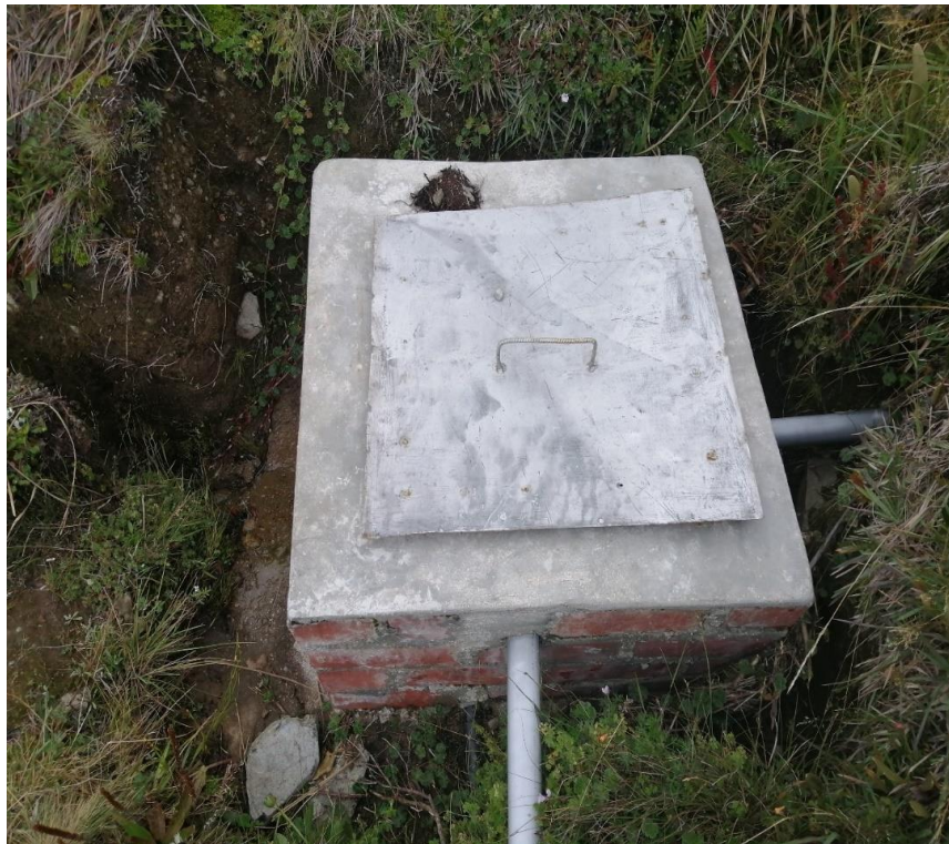
Imagen 11: Cámara Rompe presión en Línea de Conducción
