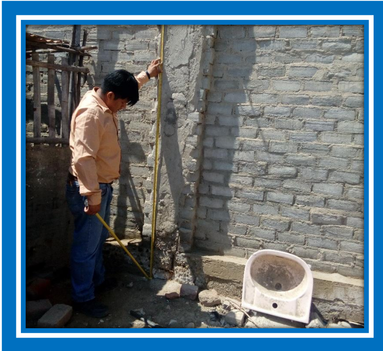
Imagen 6: Levantamiento de datos e identificación de la Patología Corrosión
