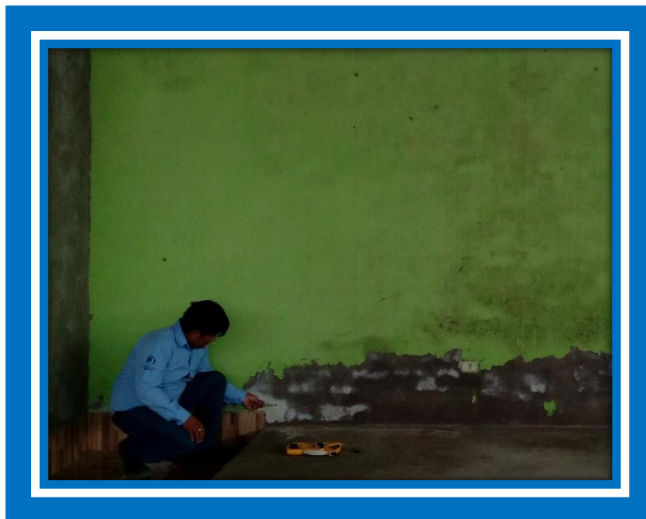
Imagen 7: Identificación de la patología eflorescencia.
