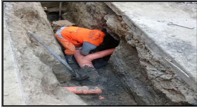
Figura 3: Tuberías Iniciales Fuente: Elaboración Propia.
