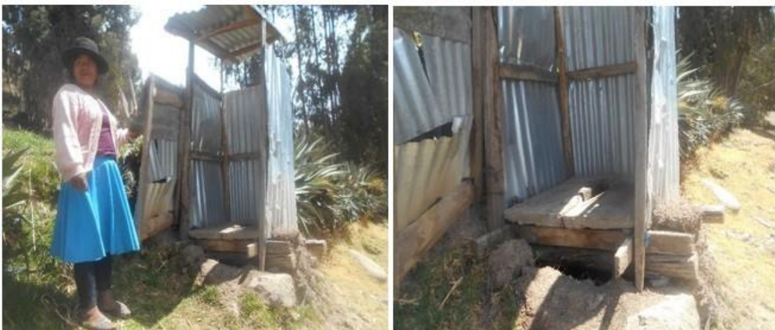
Figura 5.8: Vistas del estado malo de las letrinas.
