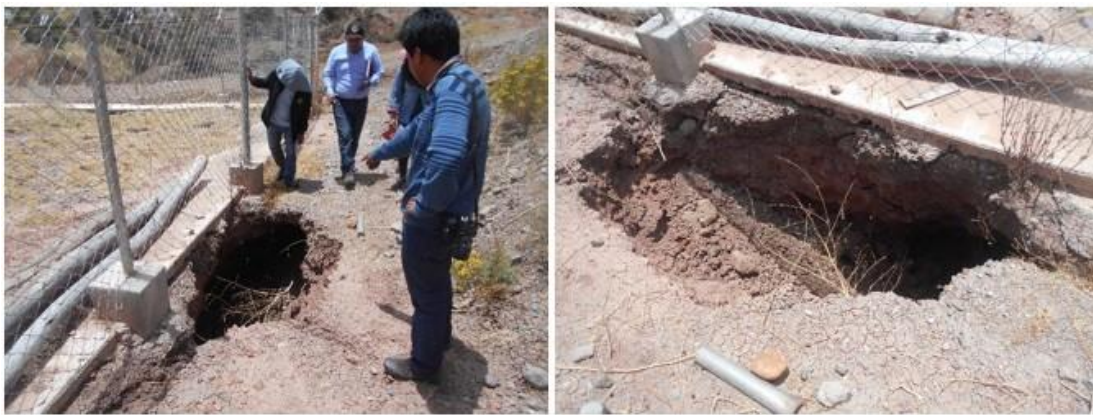
Figura 5.32: Vista del PTAR que carece de una adecuada evacuación de aguas pluviales. Fuente: (Municipalidad Distrital de Socos, 2019).
