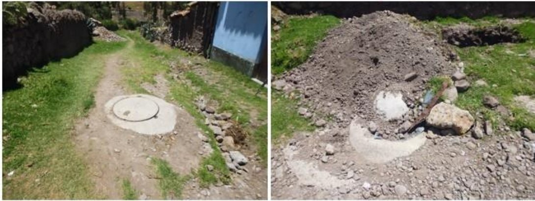
Figura 5.26: Vista de busones antiguos en las calles sin asfaltar que requieren cambiar. Fuente: (Municipalidad Distrital de Socos, 2019).
