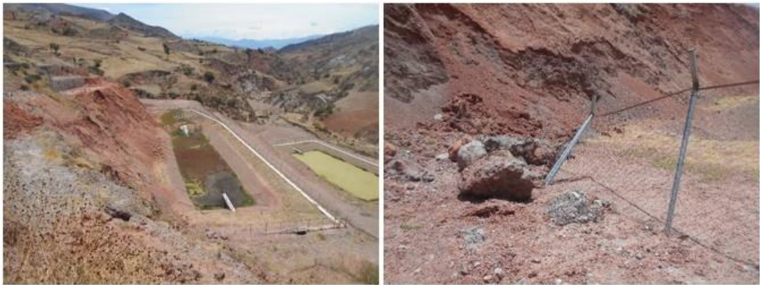
Figura 5.31: Vista del PTAR con riesgo de ser afectada por derrumbes. Fuente: (Municipalidad Distrital de Socos, 2019).
