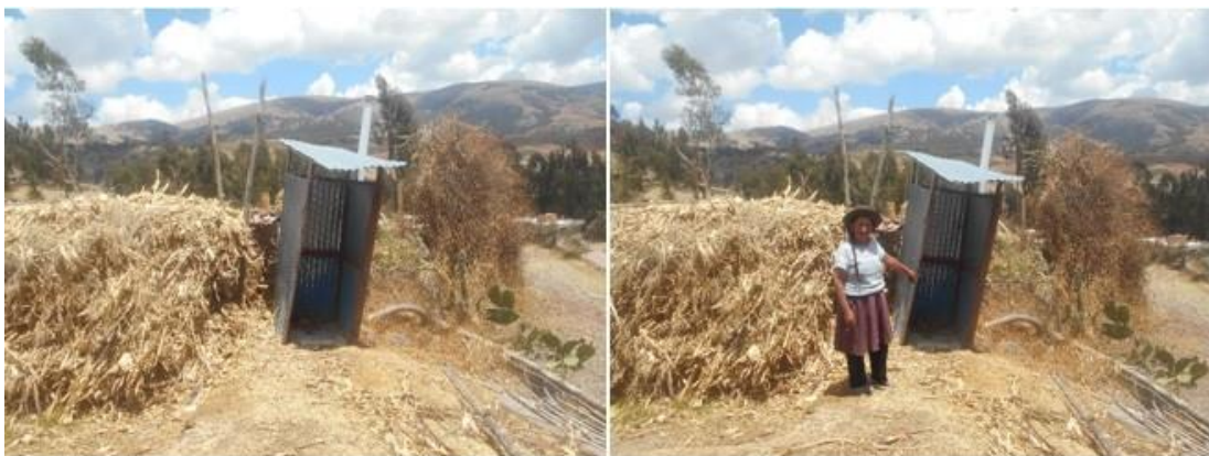
Figura 5.16: Vista del estado malo de las letrinas. Fuente: (Municipalidad Distrital de Socos, 2019).
