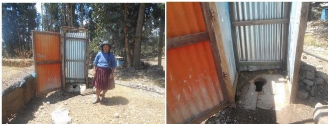
Figura 5.9: Vistas de las letrinas en mal estado.
