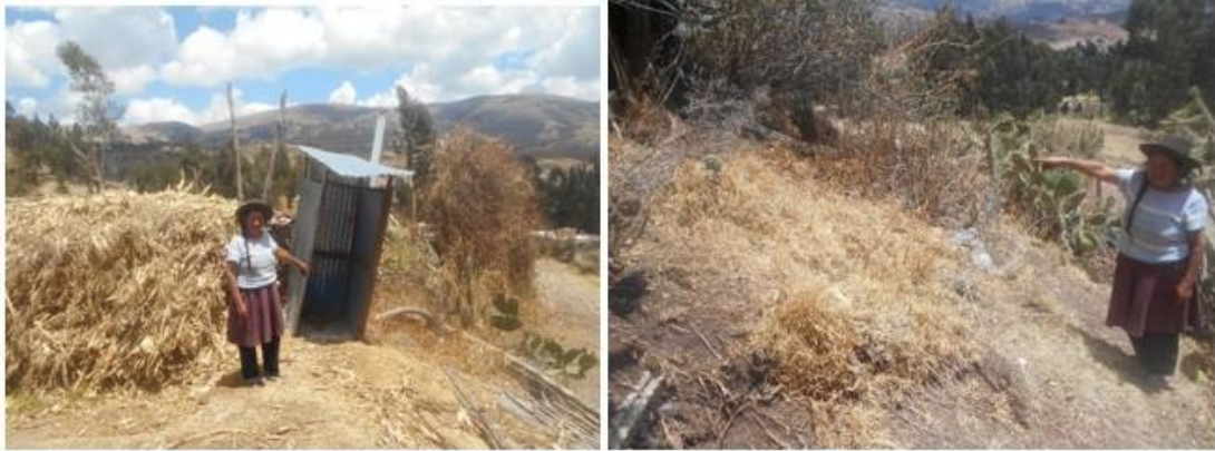
Figura 5.15: Vista del estado malo de las letrinas. Fuente: (Municipalidad Distrital de Socos, 2019).
