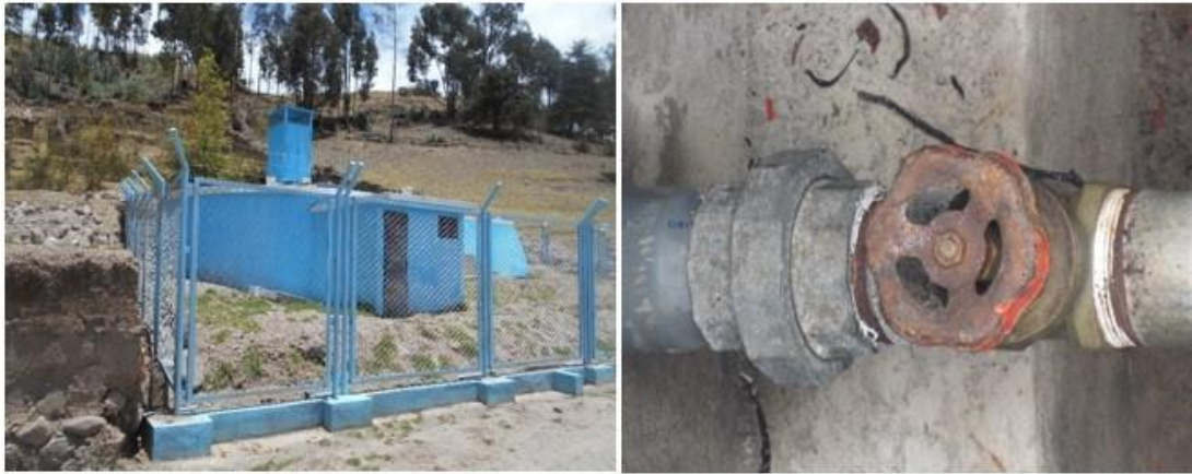
Figura 5.19: Cámara de válvulas del reservorio. Fuente: (Municipalidad Distrital de Socos, 2019).
