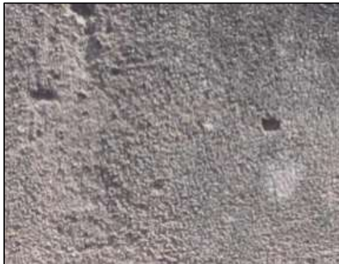
Imagen 10. Picaduras - Fuente: Elaboración Propia
