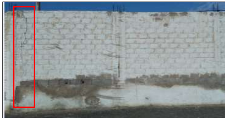
Imagen 7: Grietas - Fuente: Elaboración Propia
