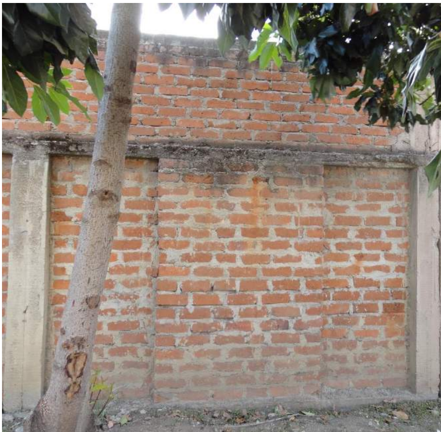
Fotografía n° 6 – Polvos en muro de ladrillo.
