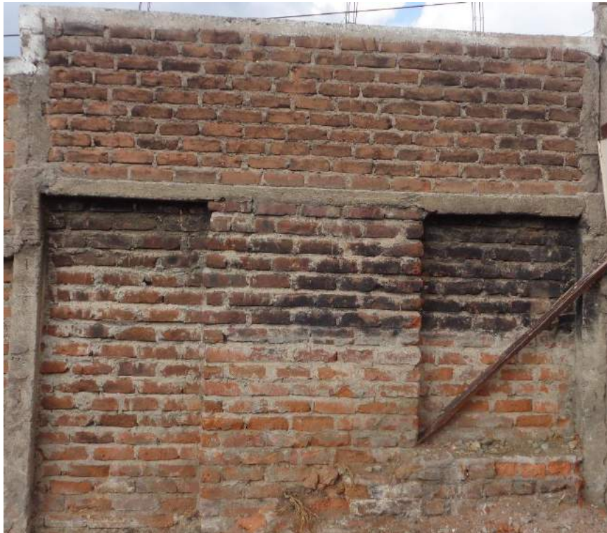
Fotografía n° 3 – Manchas en muro, columna y viga.
