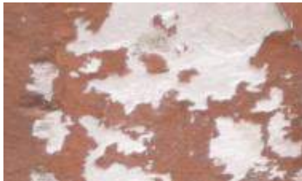
Figura 6: Abultamientos y Descascaramientos
