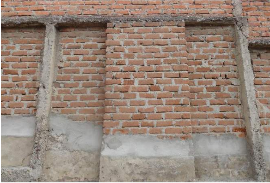
Fotografía n° 9 – Corrosión en columna y viga.
