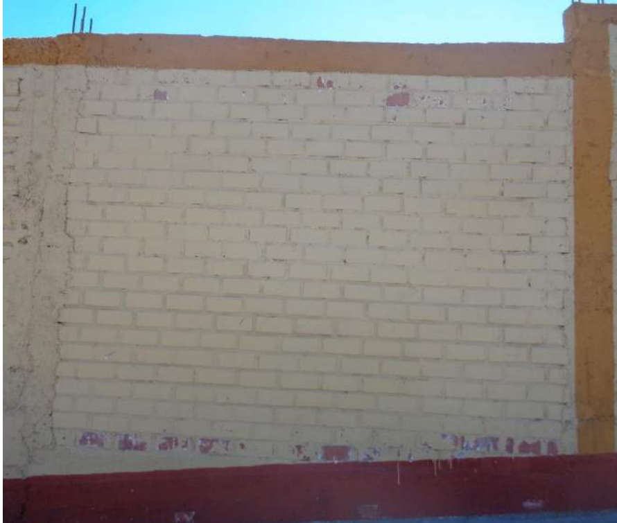
Fotografía n° 5 – Descascaramiento en muro de ladrillo.
