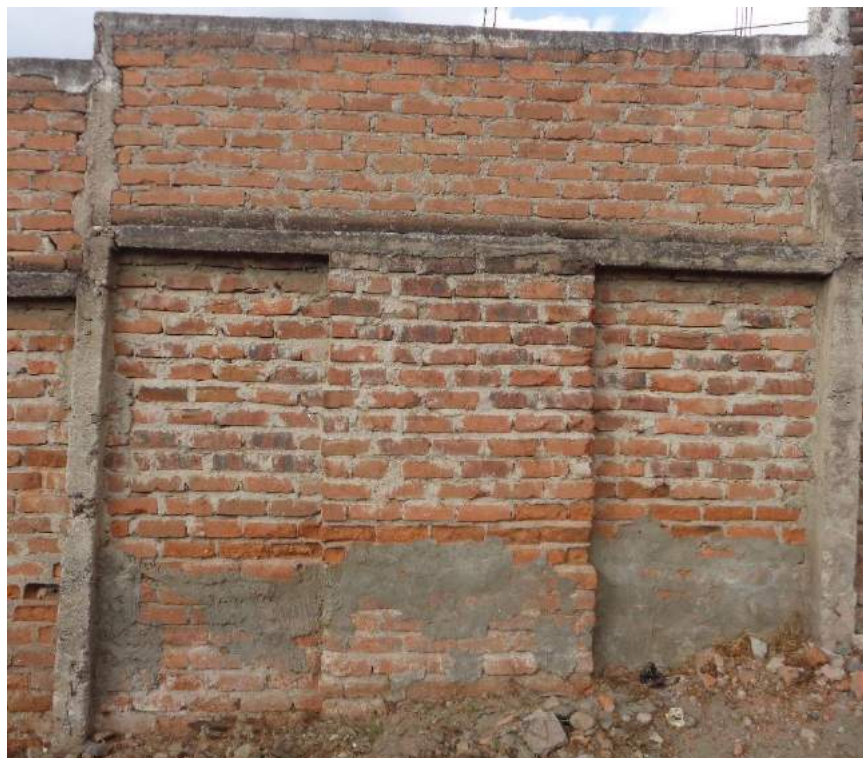
Fotografía n° 4 – Heladicidad en muro de ladrillo.
