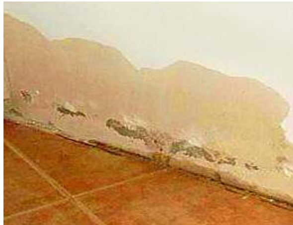
Figura 3: Daños Causados por la Humedad
