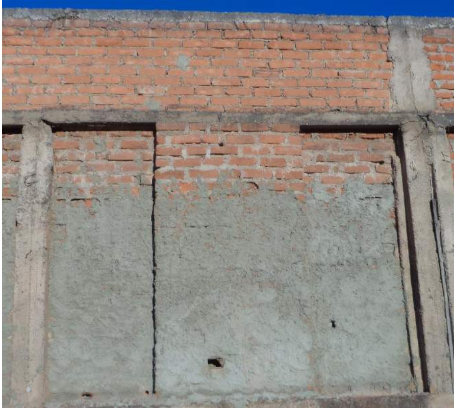
Fotografía n° 7 – Desprendimiento de ladrillo.
