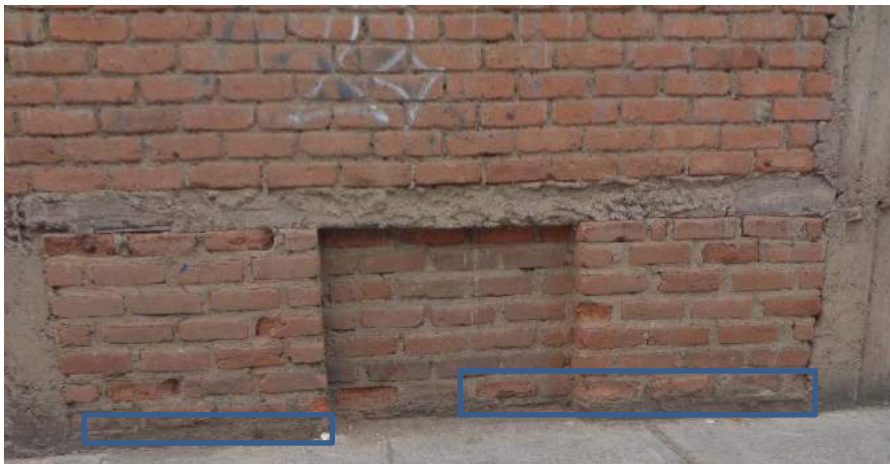
Fotografía n° 8 – Herosión en muros de ladrillo.
