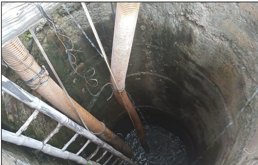
Figura 23: Pozo existente caserío Palo Parado.
