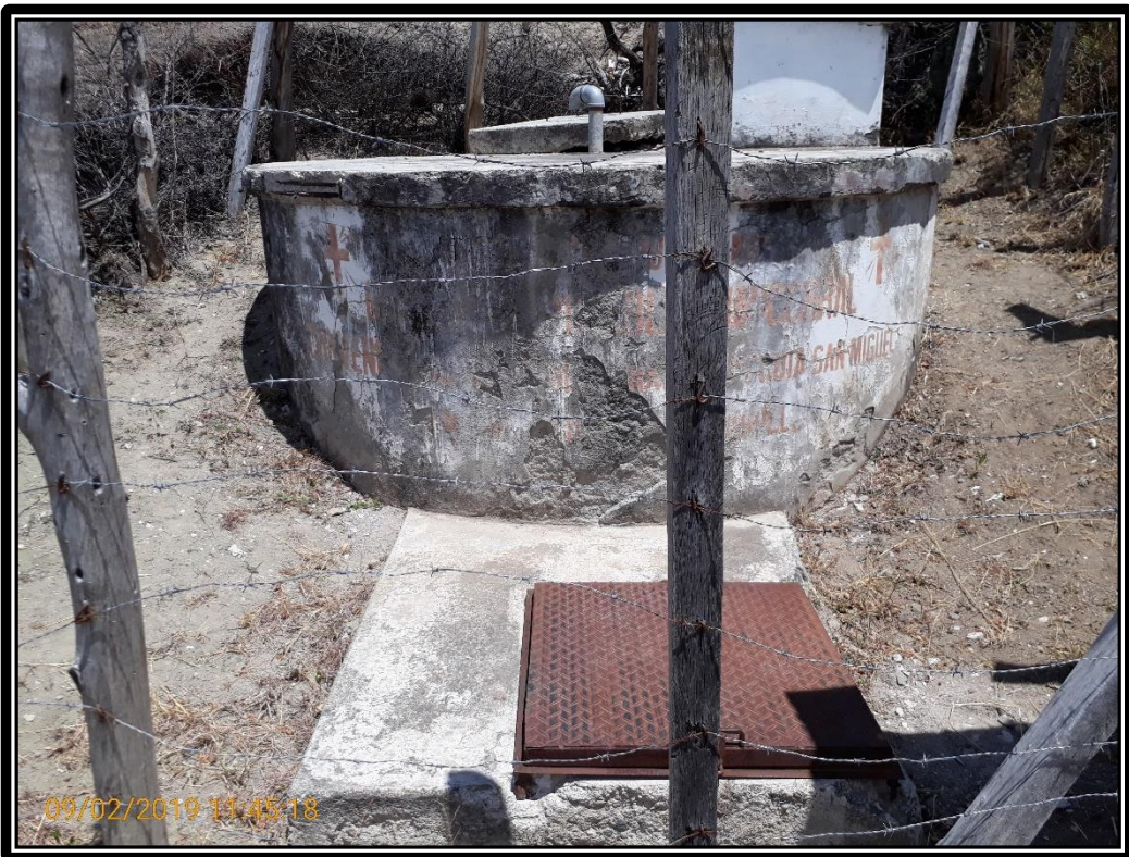
Fotografía 02: Mal estado de estructura de almacenamiento
