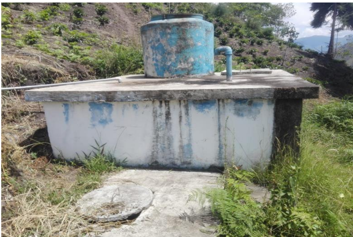
Imagen 5: Reservorio existente en pésimas condiciones, afectado por el fenómeno del niño costero
