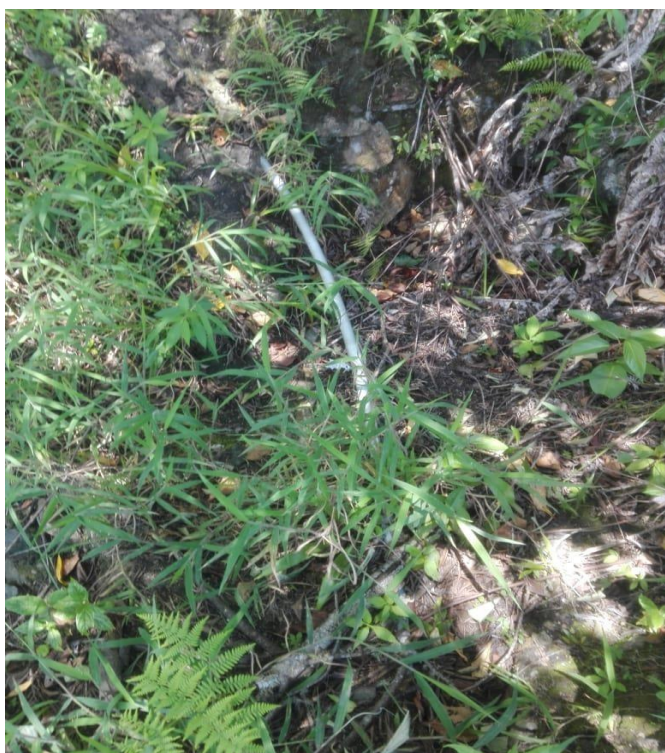
Imagen 8: Línea de conducción en malas condiciones, afectadas por derrumbes provocados por el FEN-2017
