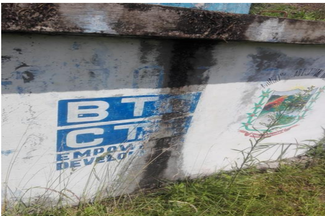
Imagen 6: Reservorio existente en pésimas condiciones, afectado por el fenómeno del niño costero
