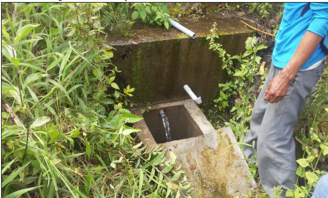
Imagen 2: Vista de captación boca buche 3 en malas condiciones
