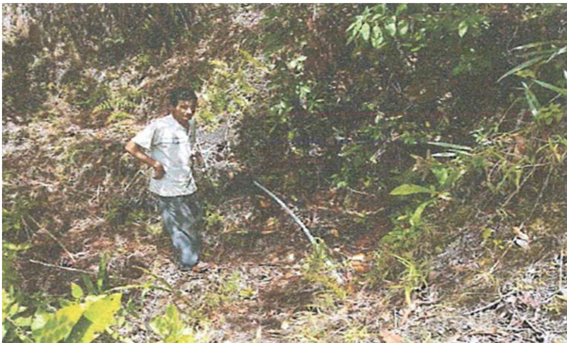
Imagen 7: Línea de conducción en malas condiciones, afectadas por derrumbes provocados por el FEN-2017
