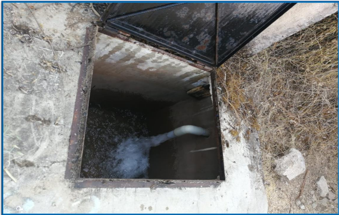
Fotografía 07: Cámara rompe presión tipo 6.
