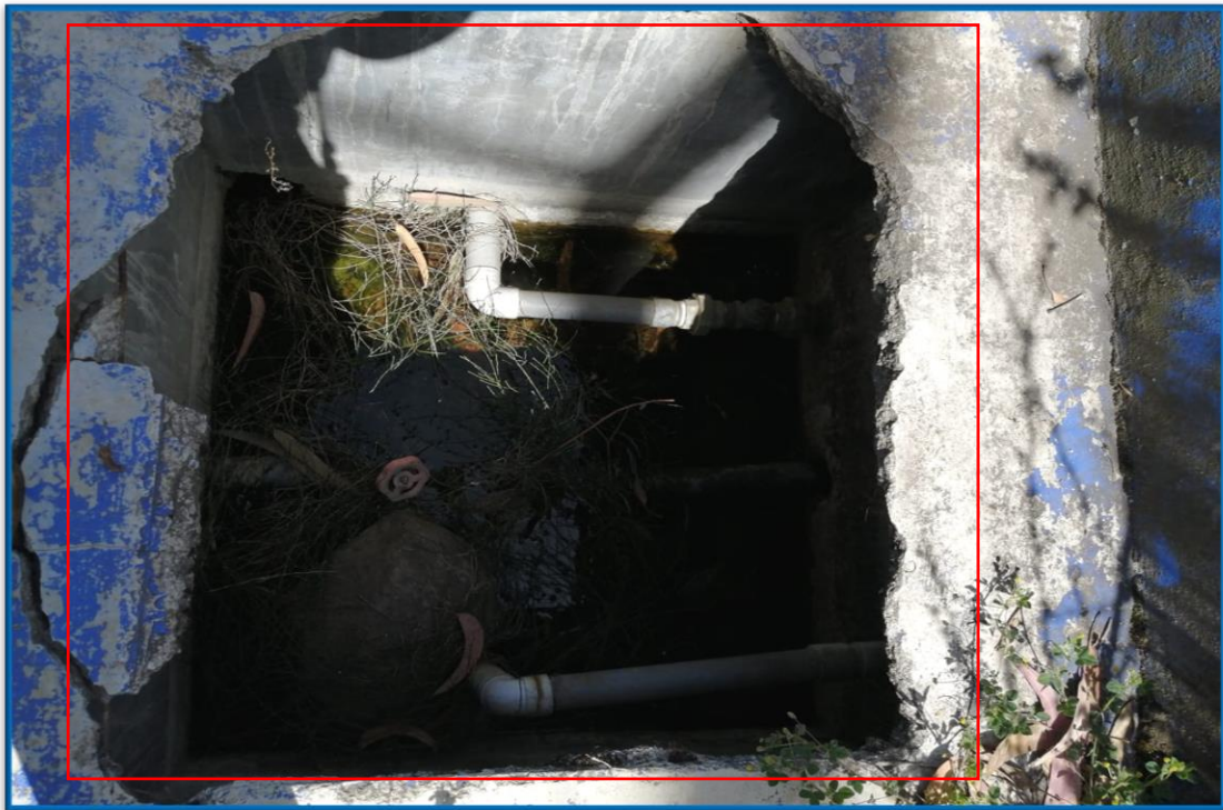
Fotografía 09: Cámara seca del reservorio existente. Se encuentra en su gran parte deteriorado.
