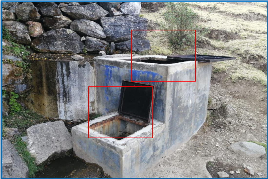
Fotografía 05: Se observa corrosión y oxido en las tapas metálicas de la captación existente.
