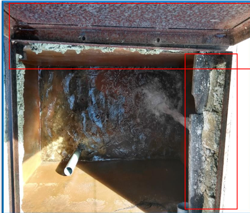
Fotografía 02: Cámara de captación existente 1 se aprecia presencia de oxido en la tapas y desprendimiento de concreto en los bordes.
