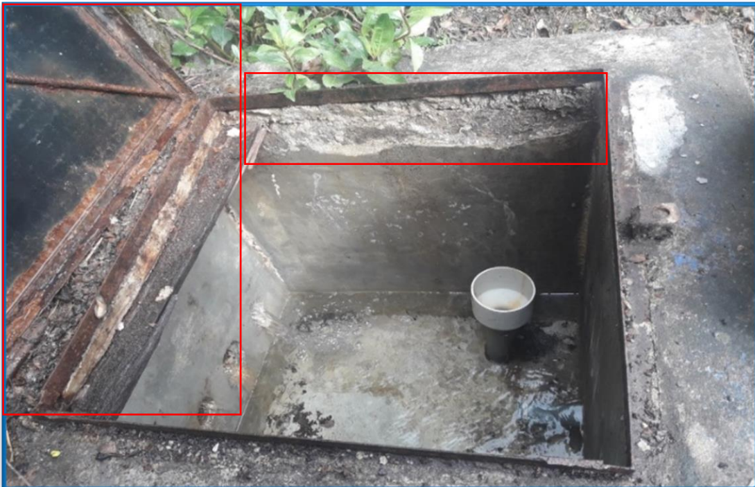
Fotografía 04: Cámara de captación existente 2 se aprecia presencia de oxido en la tapas y desprendimiento de concreto en los bordes.
