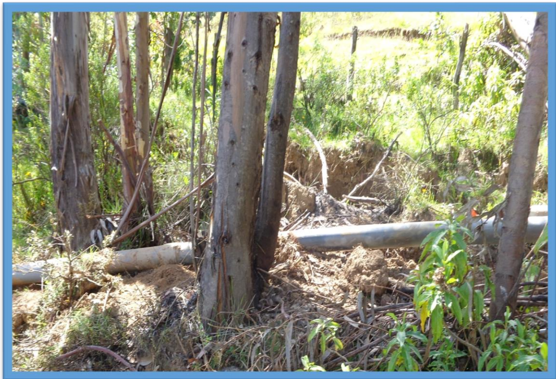
Fotografía 04: Tubería de la línea de condición expuesta a la intemperie.
