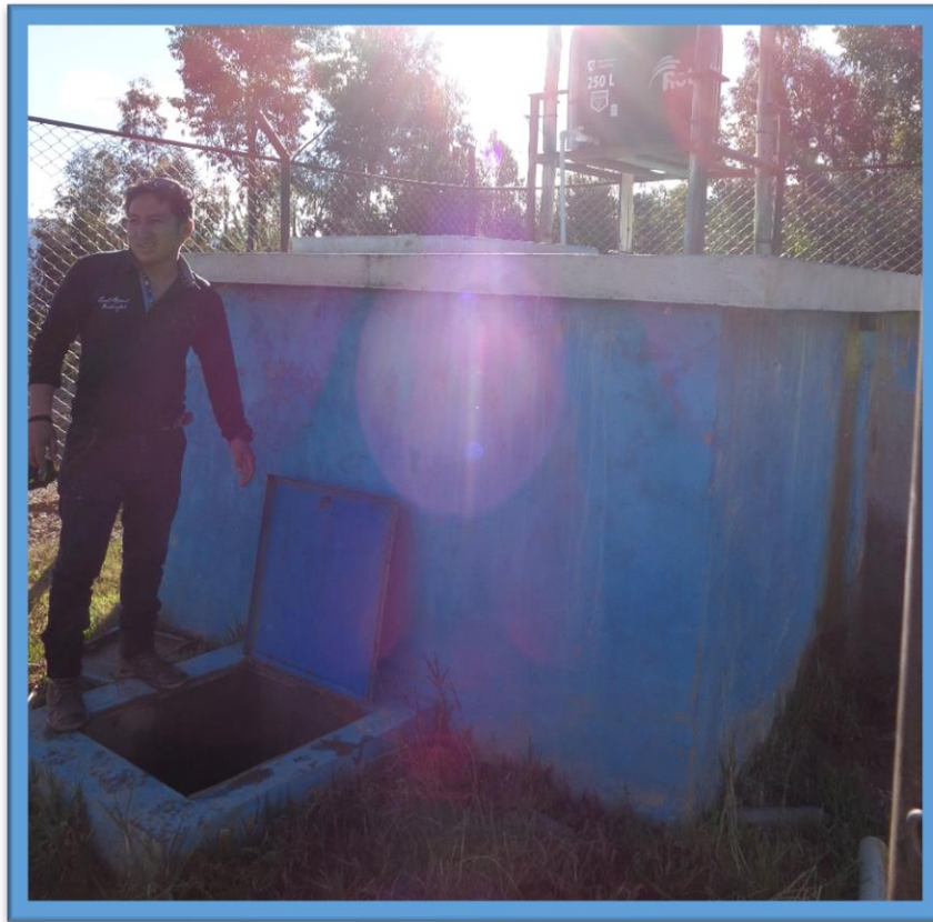
Fotografía 07: Se observa la cámara de válvulas del reservorio.
