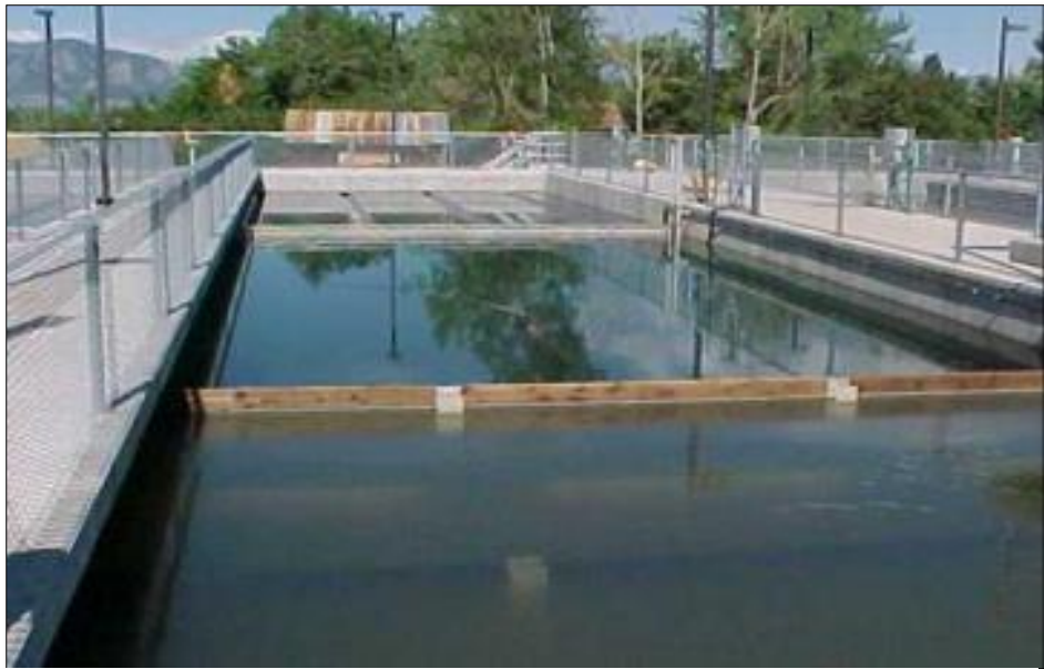
Imagen 02: Tratamiento de agua potable
