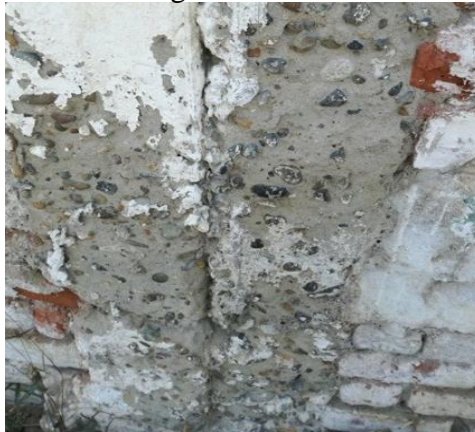
Gráfico 10: Patología en el concreto armado de columna.
