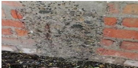
Gráfico 13: Erosión en columnas confinada.
