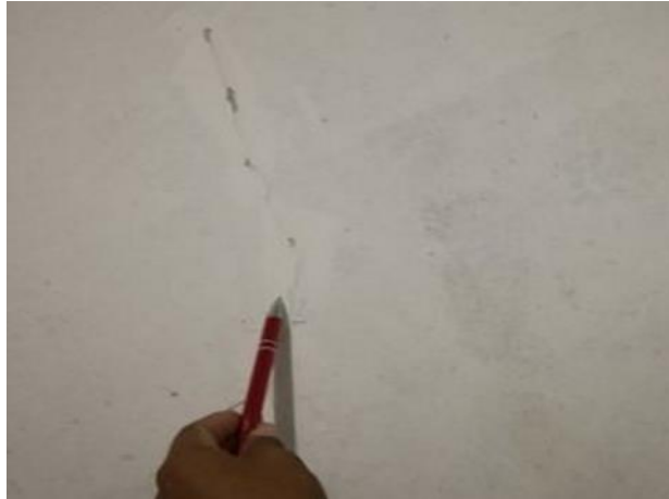
Gráfico 16: fisura en el tarrajeo.
