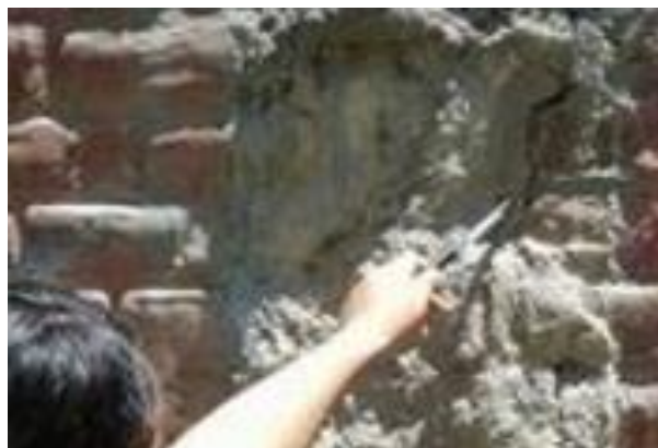
Gráfico 17: Grieta afectando la columna.
