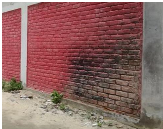
Gráfico 14: Suciedad en muro de albañilería.
