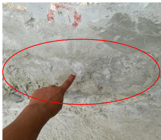
Gráfico 18: Eflorescencia en el tarrajeo del muro de albañilería.
