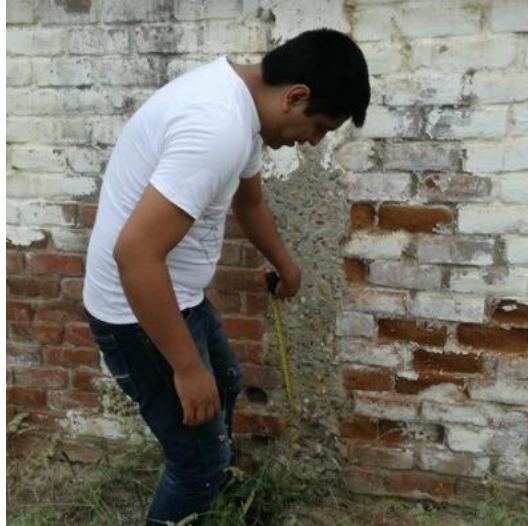
Gráfico 11: Patologías en albañilería confinada.
