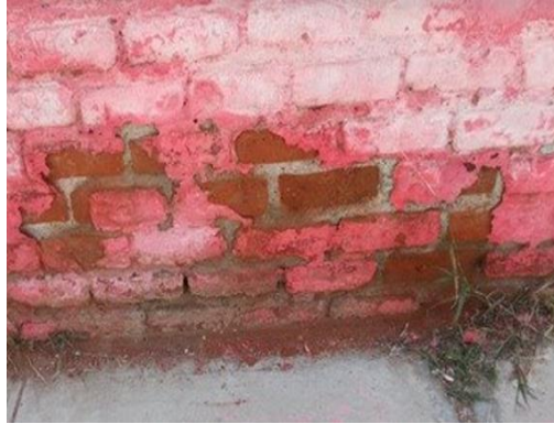
Gráfico 12: humedad en muro de albañilería.
