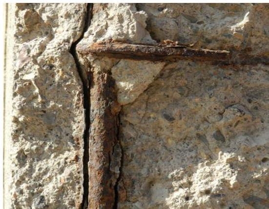
Gráfico 19: oxidación y corrosión en el acero de la columna.
