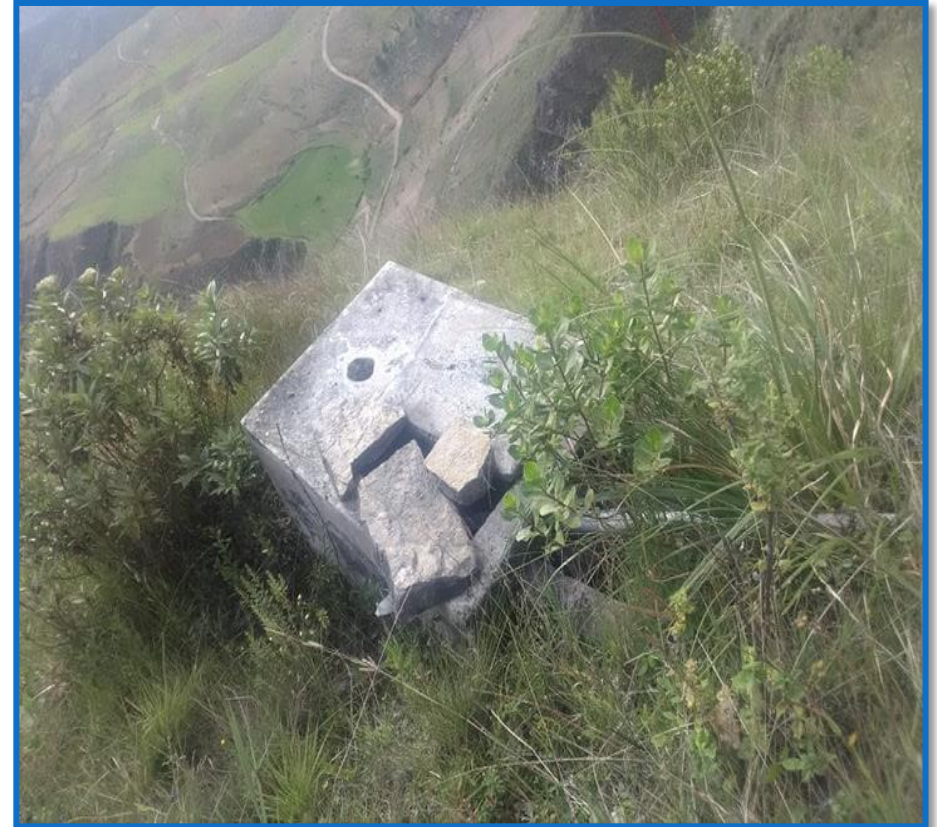
Imagen 6: Cámara rompe presión 6 – (4), sin tubo de ventilación y tapa de concreto rota.
