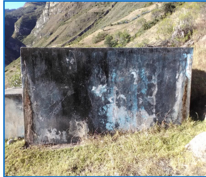
Imagen 10. Vista lateral del reservorio por donde filtra el agua
