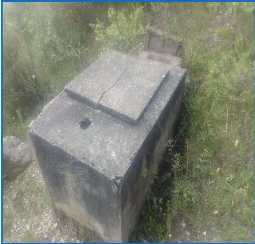
Imagen 5: Cámara rompe presión 6 – (3), sin tubo de ventilación y la tapa de concreto rota.
