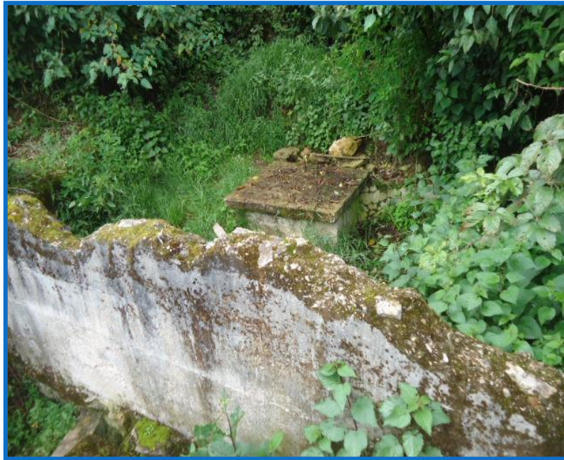
Imagen 1. Captación artesanal Quinapuquio
