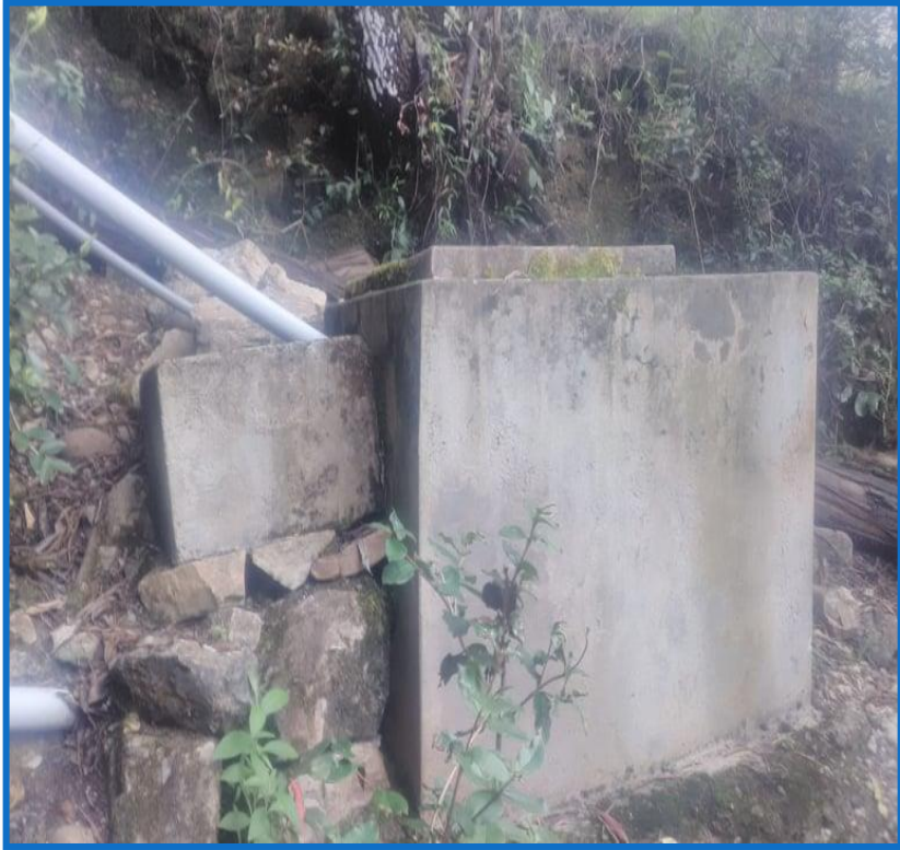
Imagen 3. Cámara rompe presión 6 – (1), tubería conectado directo a la caja de CRP6
