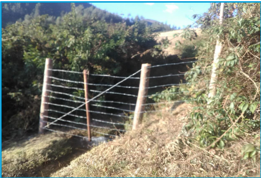
Imagen 14. Cerco perimétrico de la captación Quinapuquio
