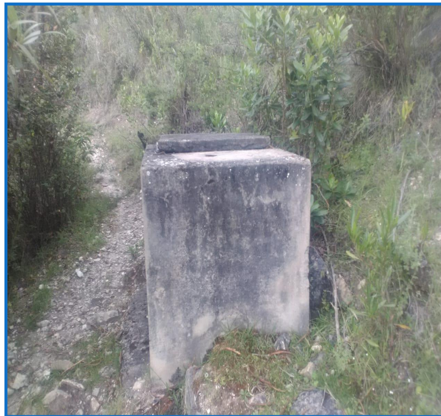
Imagen 8: Cámara rompe presión 6 – (6), en mal estado
