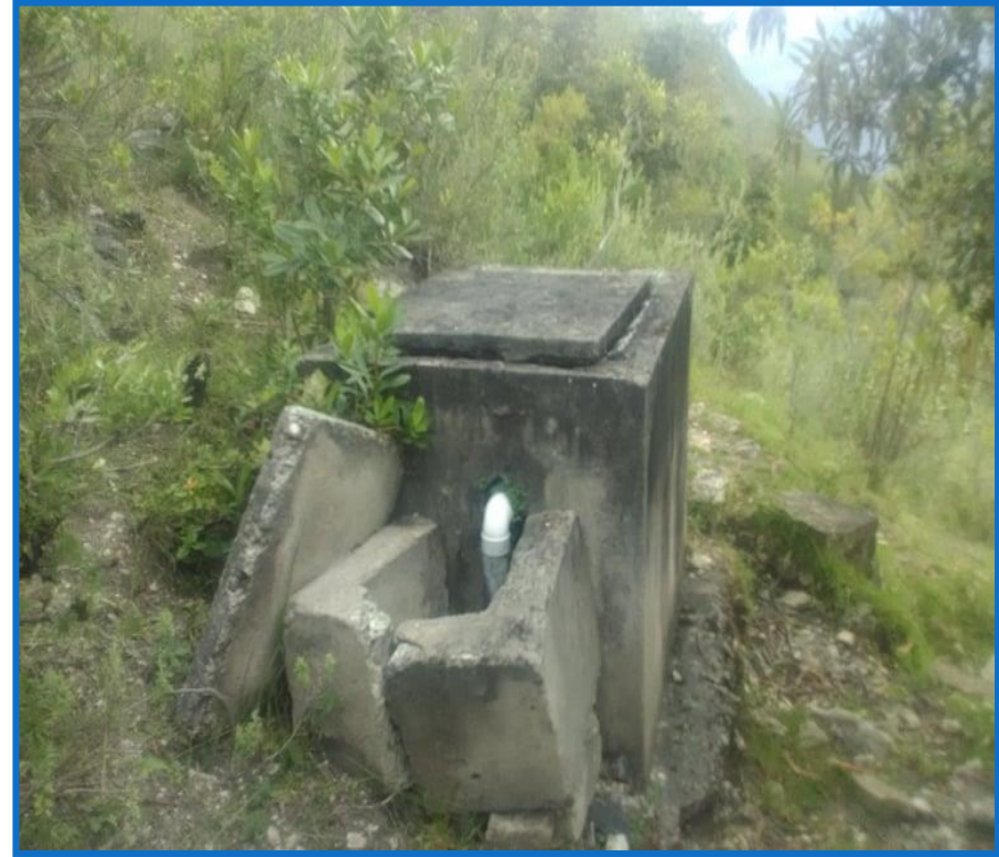
Imagen 4. Cámara rompe presión 6 – (2), caja de válvulas en mal estado
