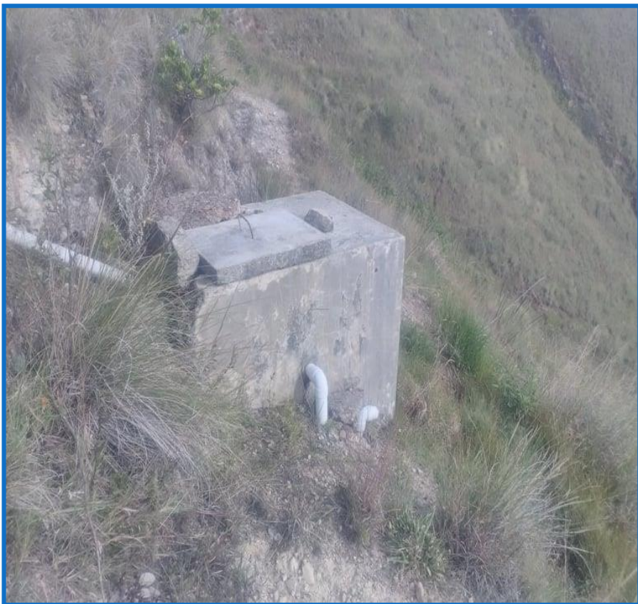
Imagen 7: Cámara rompe presión 6 – (5), en mal estado
