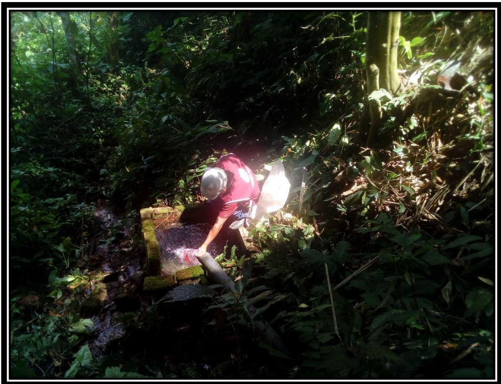
Figura 122: Vista Panorámica de la Captación del centro poblado Río Oso.
