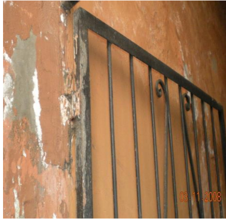
Figura 4: Corrosión de metales
