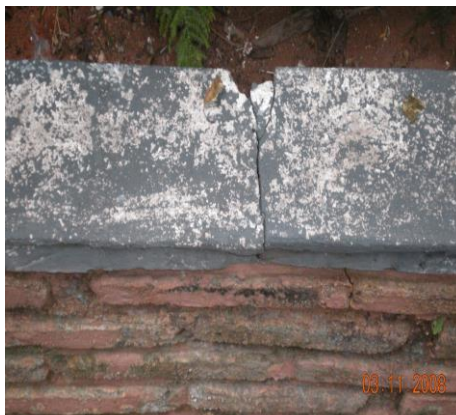
Figura 5: Eflorescencia y fisuras
