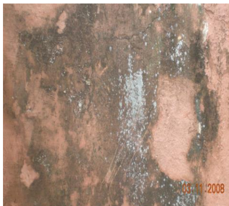
Figura 6: Manchas de humedad
