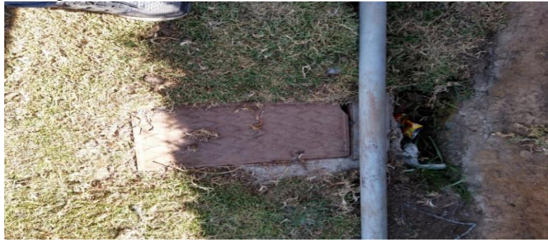
Imagen 15: Situación actual de conexiones domiciliarias
