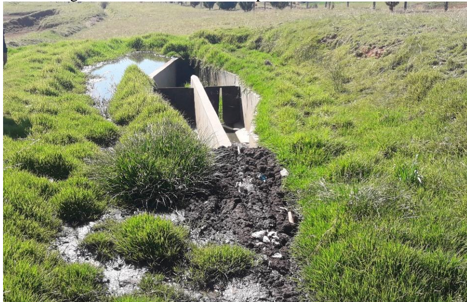
Imagen 17: Situación actual del pre tratamiento del PTAR.
