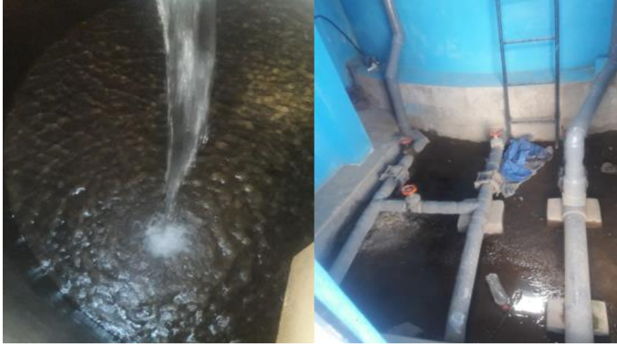
Imagen 12: Nótese el reservorio a medio llenar y estado de las válvulas
