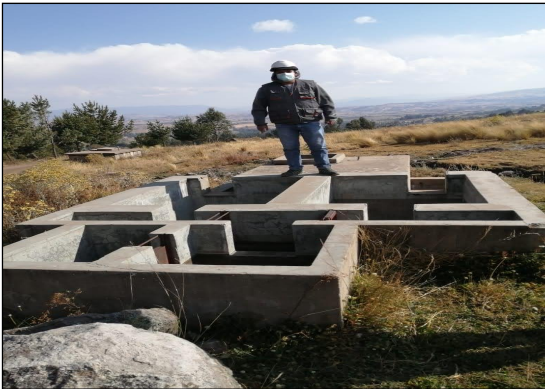
Imagen 23: Pre-filtro sin funcionamiento.
