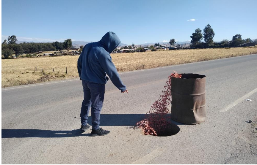
Imagen 14: Buzón en la carretera sin tapa.
