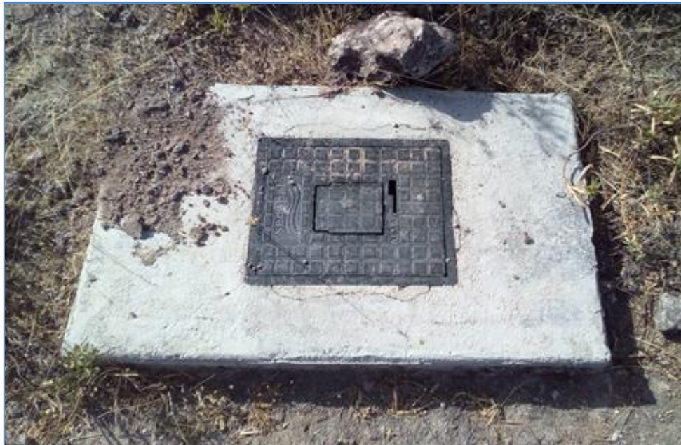
Figura 18: Caja de válvula de aire
