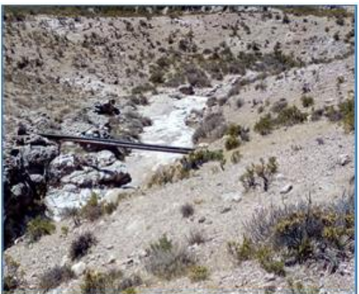
Imagen 3: Línea de conducción sobre una quebrada.
