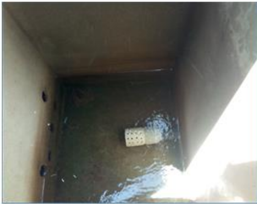
Imagen 1: Captación tipo manantial en el sector Secce
