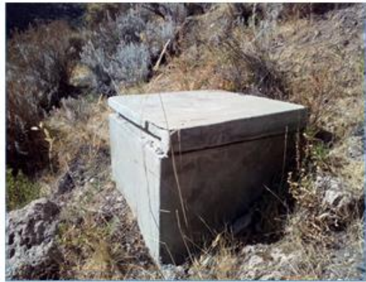
Imagen 4: Cámara Rompe Presión T-6 en la línea de conducción.
