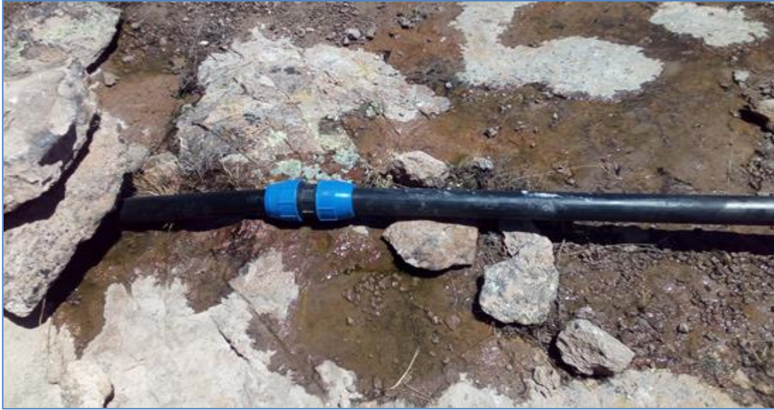
Figura 17: Filtración de agua por fallas en la unión de la línea de conducción
