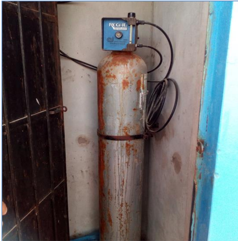
Figura 22: Tanque de cloración gaseoso
