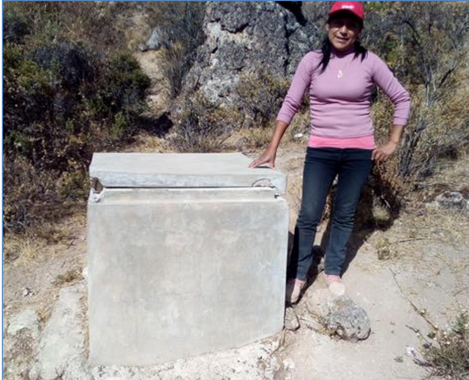
Figura 19: Cámara rompe presión
