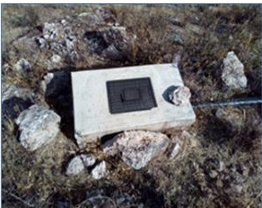
Imagen 6: Válvula de aire, con tapa y en perfectas condiciones.
