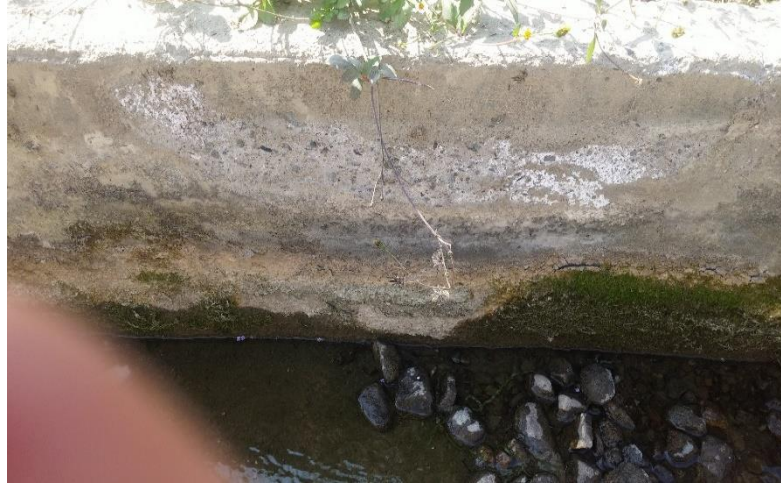
Imagen 03: Manchas en las paredes de la caja del canal.
