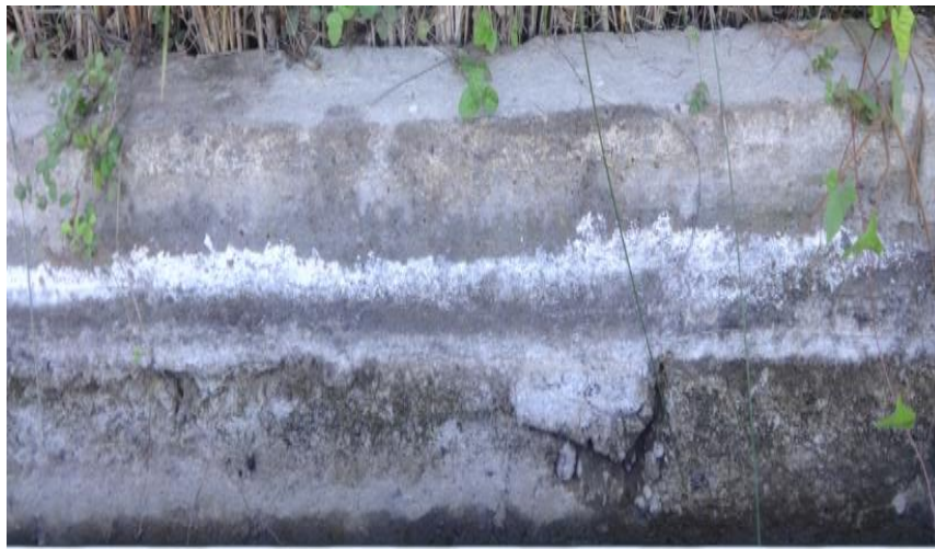
Imagen 12: Eflorescencia en las paredes del canal.
