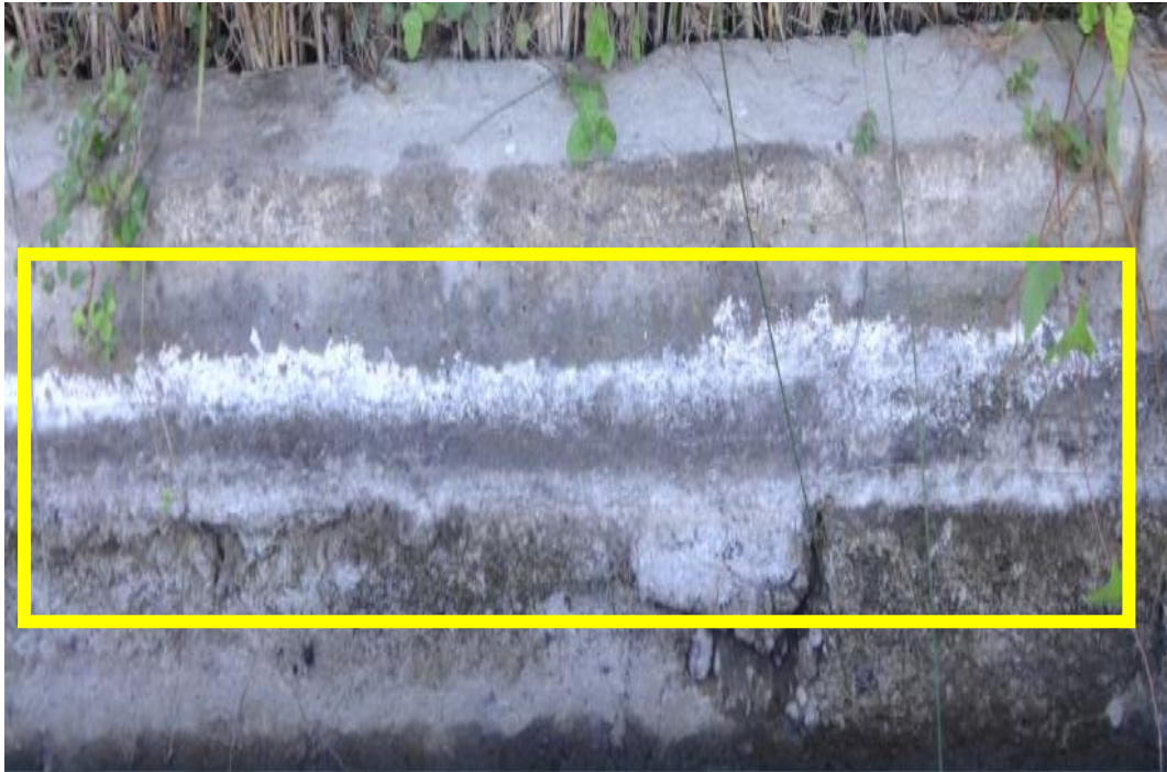
Fotografía 02: Eflorescencia en la unidad de muestra 6 el canal de riego Monte Común.
