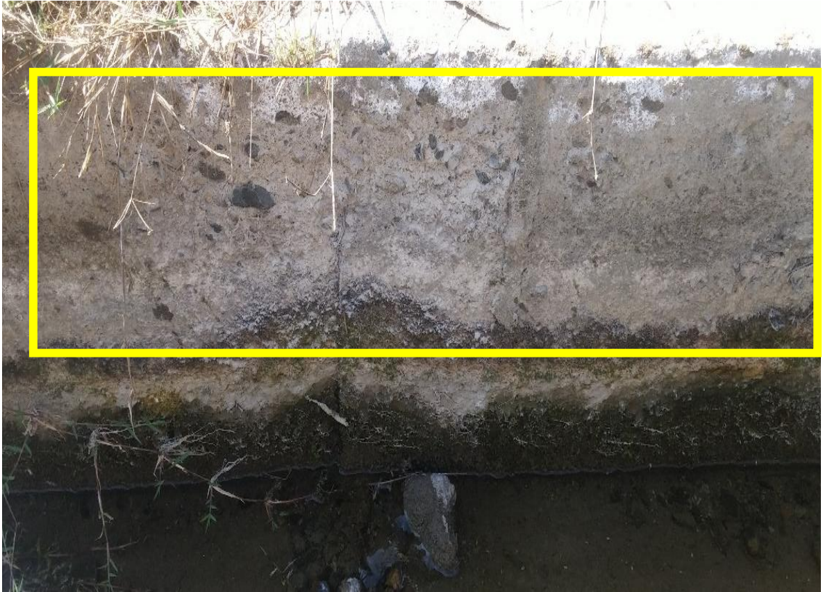
Fotografía 06: Erosión en la unidad de muestra 20 en el canal de riego Monte Común.
