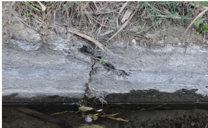
Imagen 06: Grietas en la estructura del canal.
