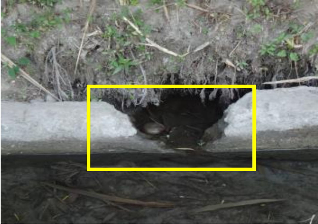
Fotografía 03: Rotura en la unidad de muestra 5 del canal de riego Monte Común.
