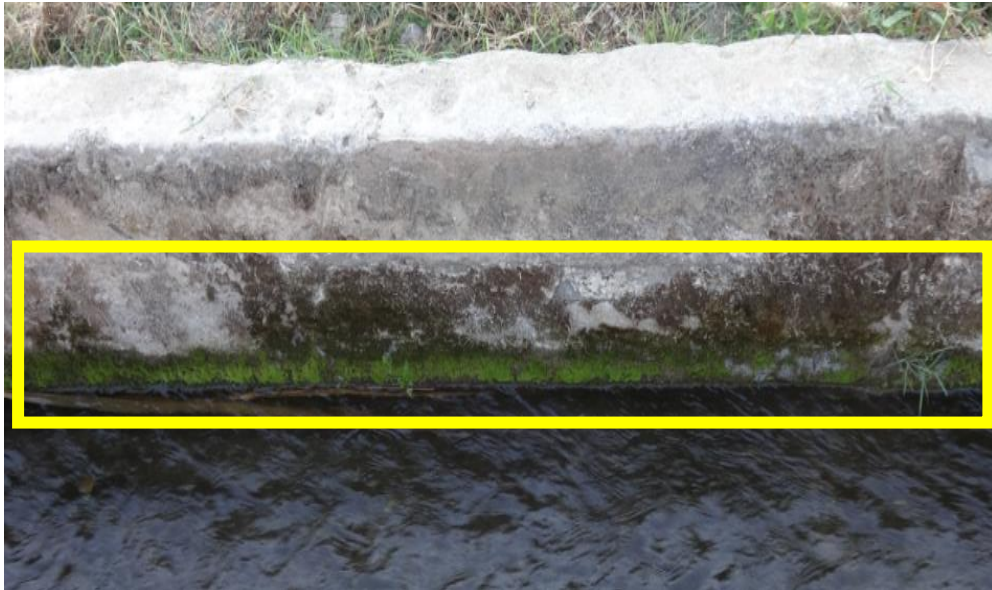
Fotografía 09: Hongos en la unidad de muestra 23 en el canal Monte Común.
