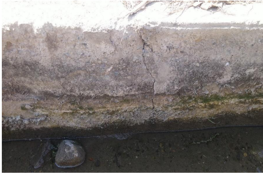
Imagen 07: Fisuras en las paredes de la caja del canal.
