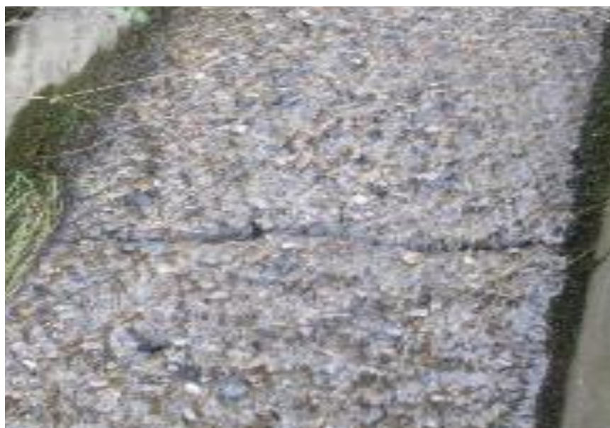
Imagen 08: Erosión en el fondo del canal.
