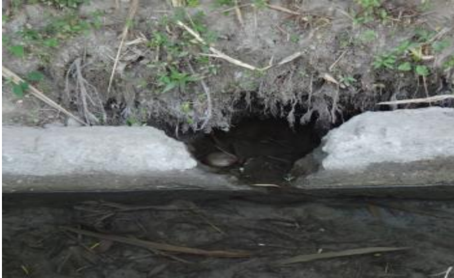
Imagen 11: Rotura del canal de concreto.
