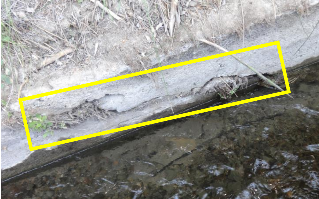
Fotografía 04: Grieta en la unidad de muestra 4 en el canal de riego Monte Común.
