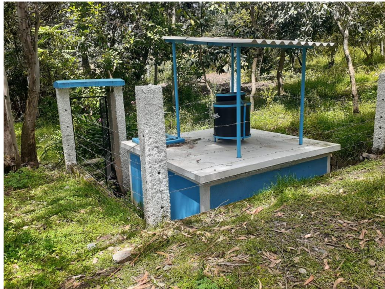
Fotografía 3: Reservorio de 4.00 m 3
