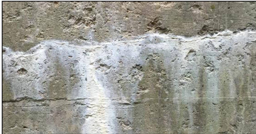
Gráfico N.º 6: Descascaramiento del concreto
