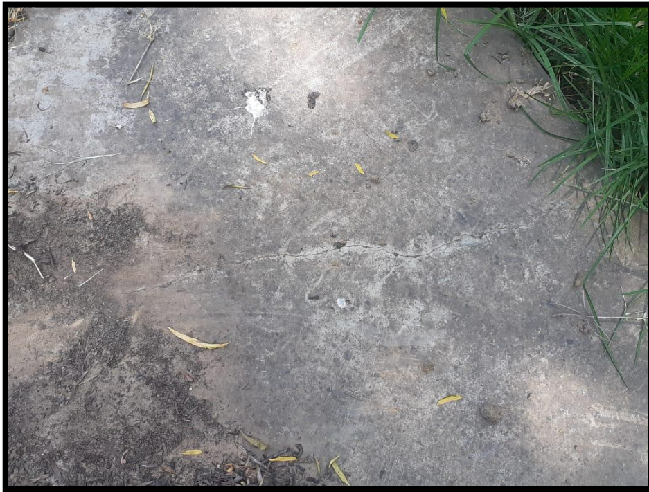
Fotografía 5: Fotografía 10: Figuraciones en el tanque séptico
