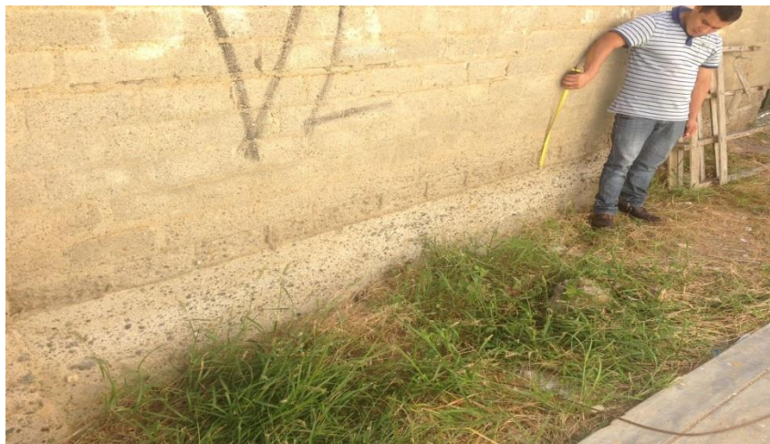
Gráfico 63: Erosion en la parte inferior del muro
