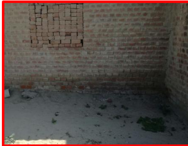
Gráfico 3: Humedad en la parte inferior del muro.
