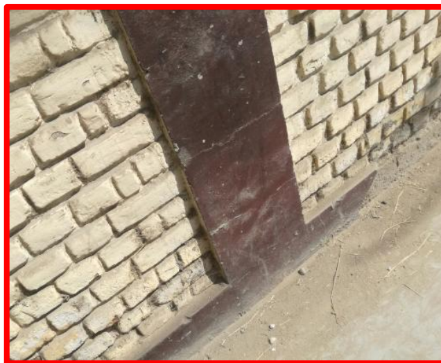
Gráfico 6: Fisura afectando la columna de concreto armado.
