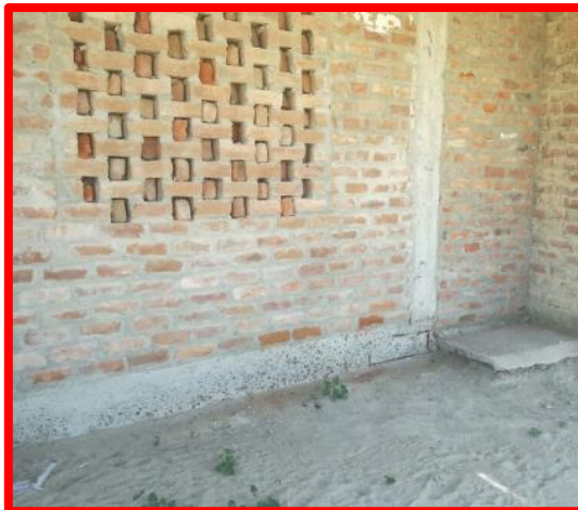
Gráfico 4: Erosión afectando el sobrecimiento.
