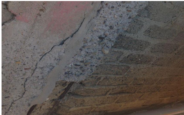
Gráfico 395: Fisuras- Parte inferior de la columna.
