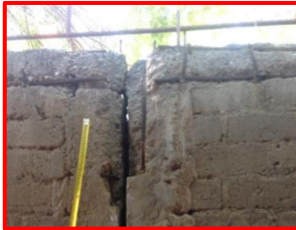
Gráfico 9: Oxidación y corrosión en acero de la columna y viga.
