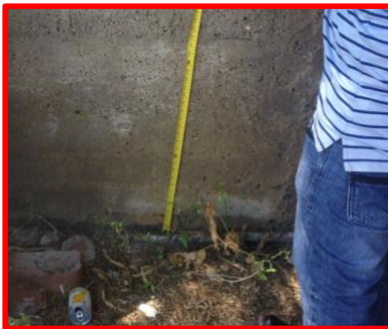
Gráfico 8: Eflorescencia en la parte inferior del muro.
