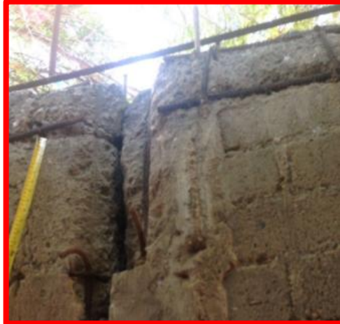
Gráfico 7: Desprendimiento del concreto de la viga y columna.
