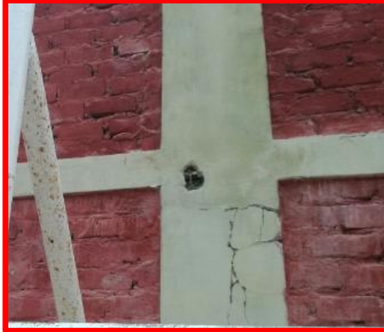
Gráfico 5: Grieta en la columna.
