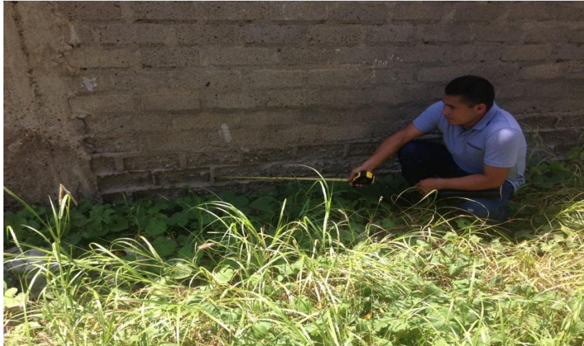
Gráfico 64: Eflorescencia en la parte inferior del muro
