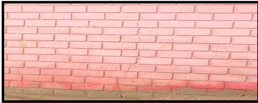
Figura 12. Imagen de fisura en elementos de albañilería
