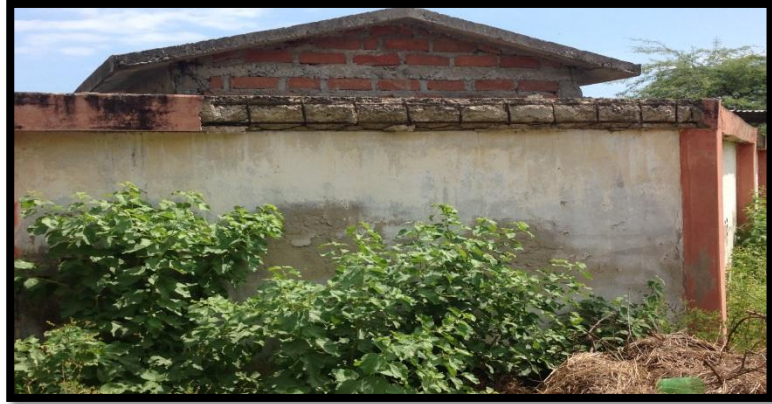
Figura 10. Imagen de corrosión en elementos de albañilería
