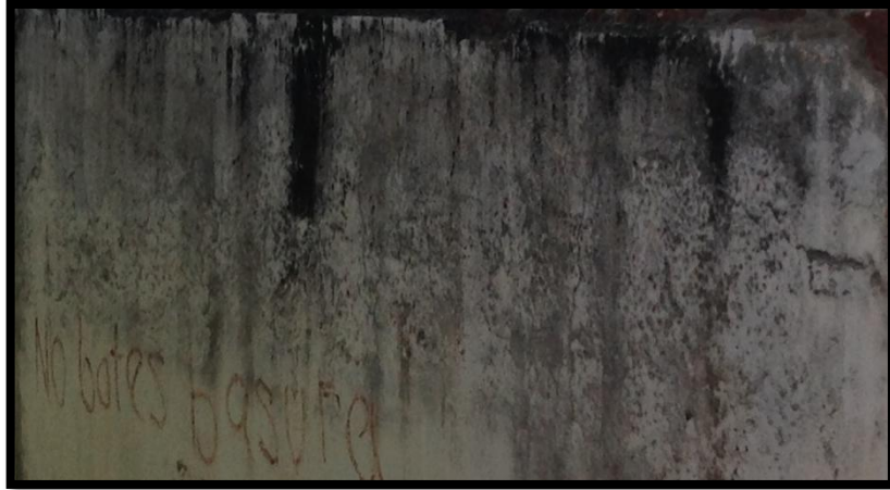
Figura 13. Imagen de suciedad en elementos de albañilería
