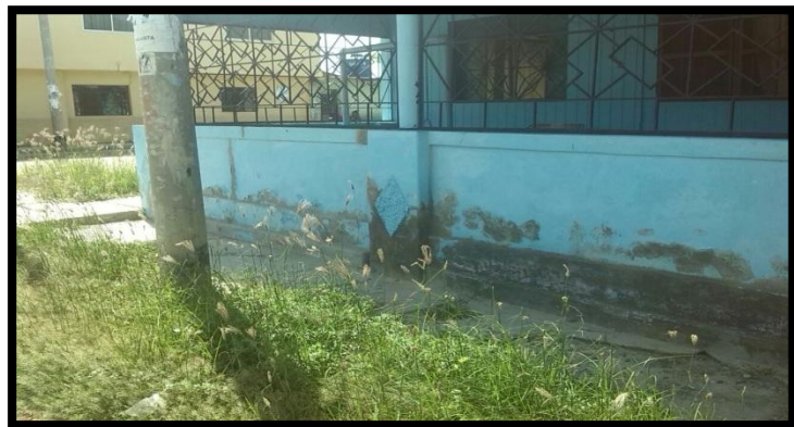
Figura 09. Imagen de Eflorescencia en elementos de albañilería
