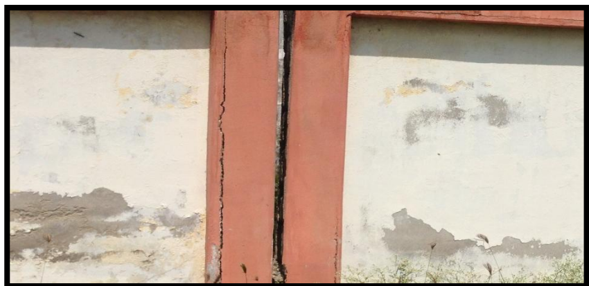
Figura 11. Imagen de grieta en elementos de albañilería
