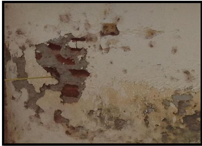
Figura 15. Imagen de erosión en elementos de albañilería
