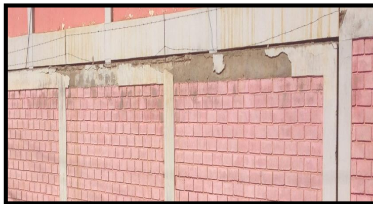
Figura 14. Imagen de fisura en elementos de albañilería
