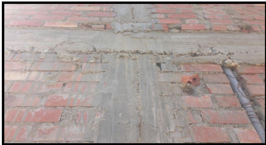
Figura 08. Imagen de Patología de Concreto
