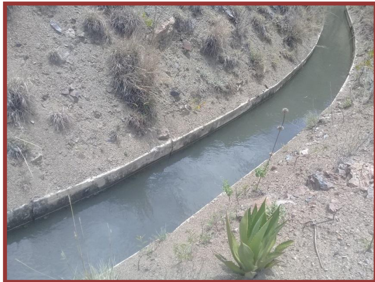
Fotografía N° 04: Vista de las grietas identificadas en las curvas del canal.
