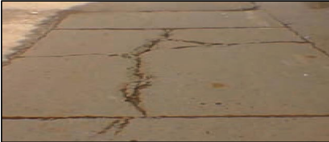
Figura 2.8: Falla de losa dividida.
