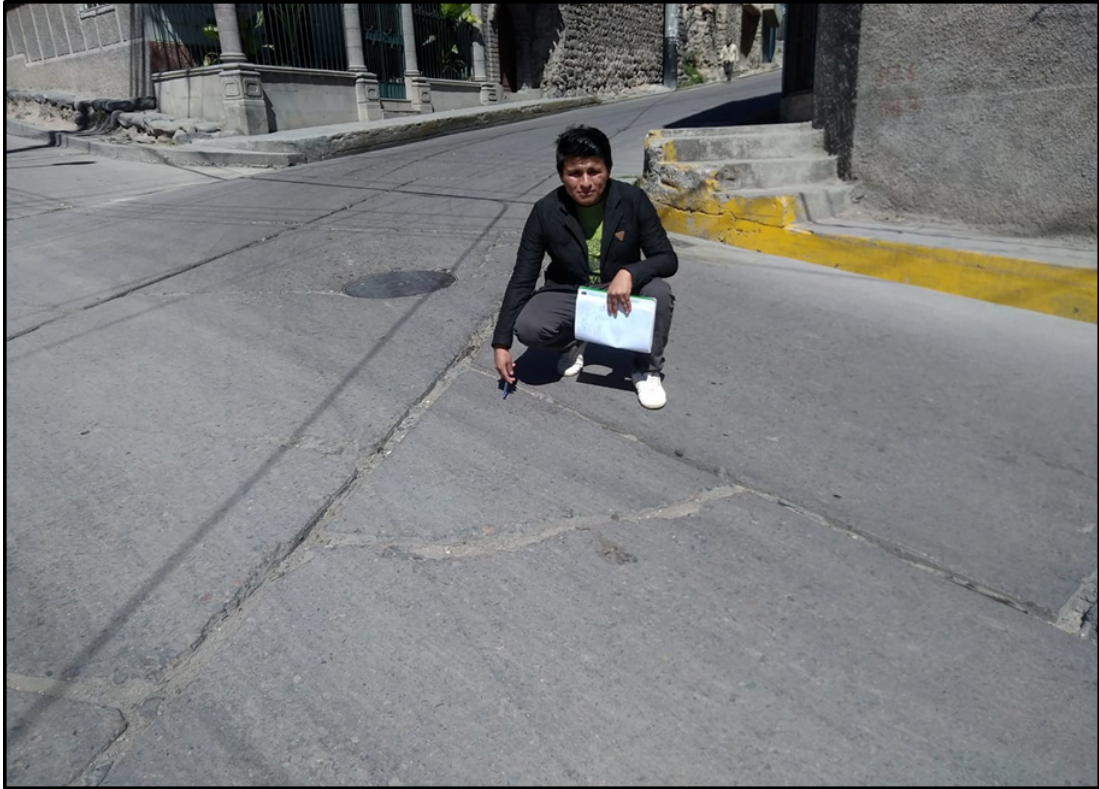
Fotografía 3: Grieta de esquina, sello de junta de la cuadra 01 de la Avenida Carmen Alto.
