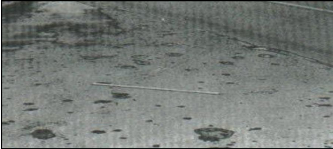
Figura 2.17: Falla por Popouts.
