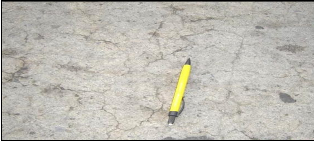
Figura 2.22: Grieta por Retracción.
