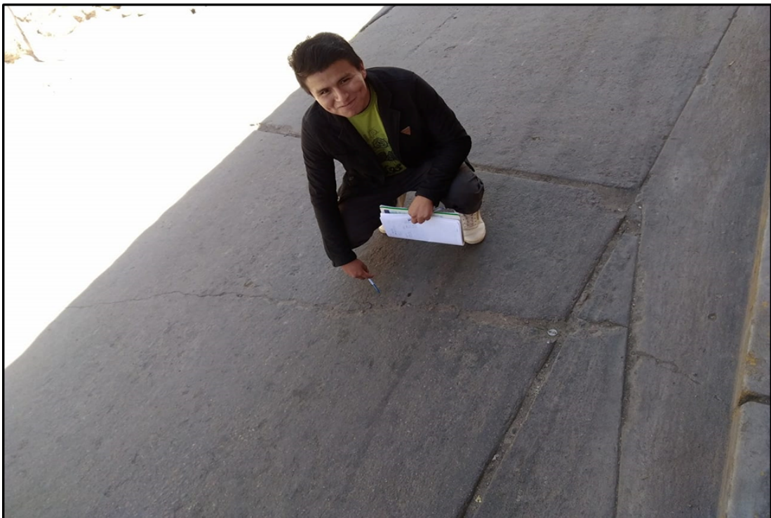
Fotografía 4: Grieta longitudinal y transversal, descascamiento de junta, presente en la cuadra 02 de la Avenida Carmen Alto.
