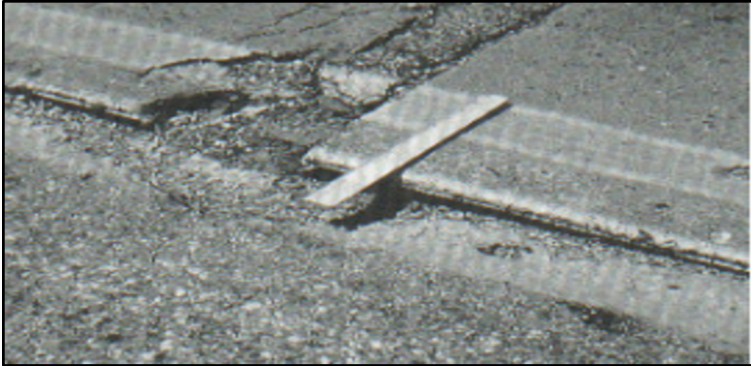
Figura 2.12: Desnivel carril berma.
