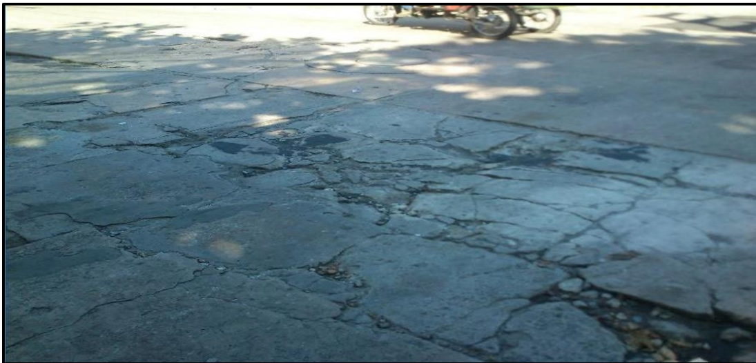
Figura 2.21: Desconchamiento, mapa de grietas, craquelado.
