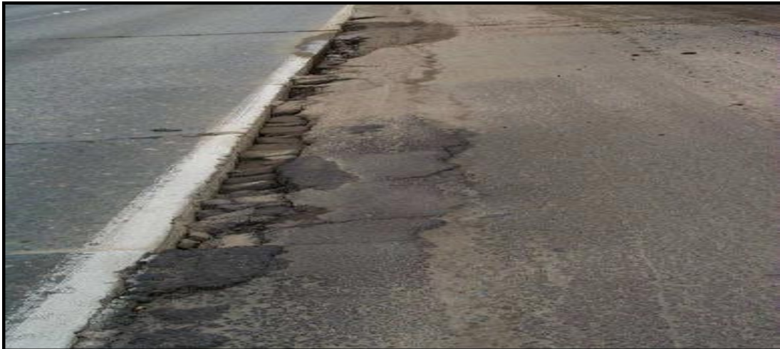
Figura 2.18: Falla por Bombeo.
