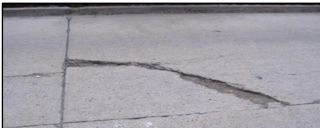
Figura 2.23: Descascaramiento de esquina.
