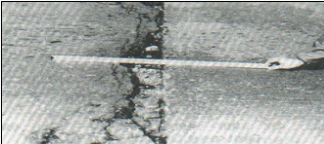
Figura 2.24: Descascaramiento de Junta.
