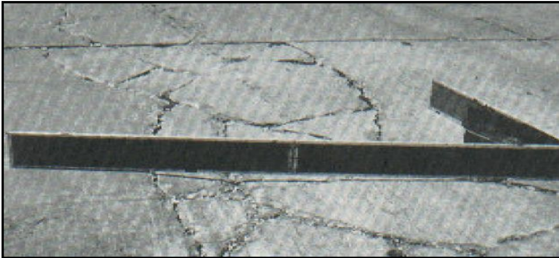
Figura 2.19: Falla por Punzonamiento.
