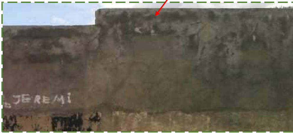
Gráfico N° 181: Patología – Fisuras (UM – 16)
