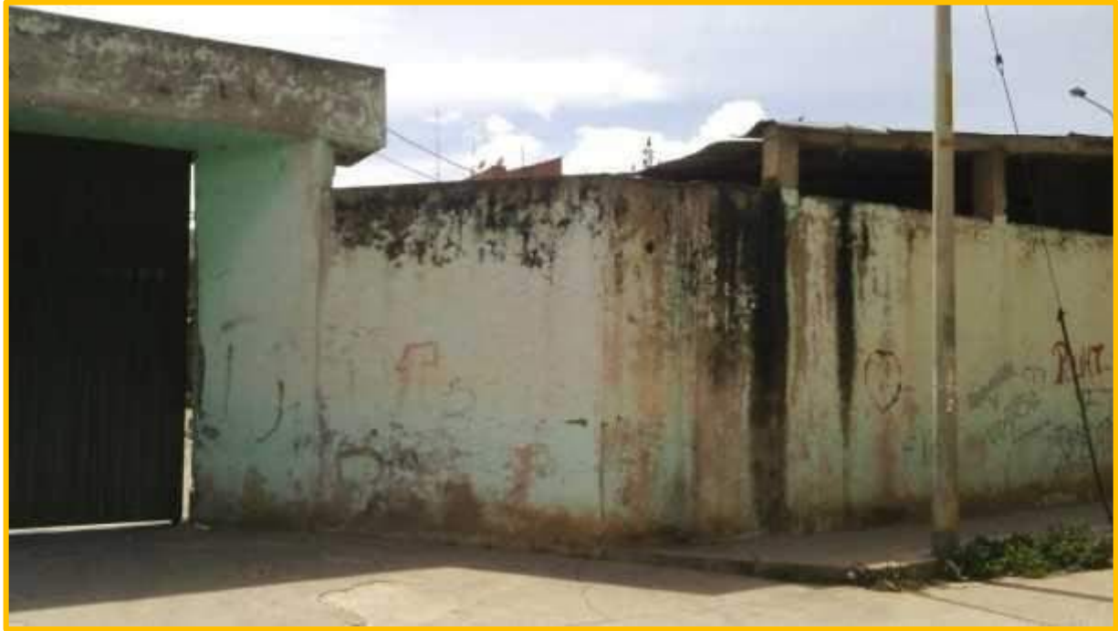
Gráfico N° 175: Vista del estado actual del Cerco Perimétrico, donde se muestra alguna de las patologías como, Grietas, y Mohos (en las zonas superiores).
