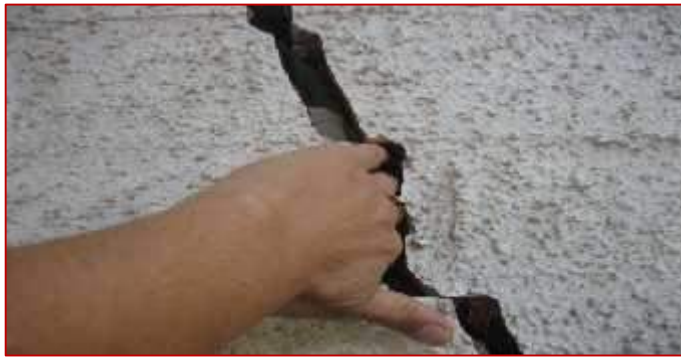
Gráfico N° 02: Presencia de grieta
