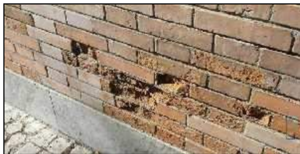
Grafico N° 01: Presencia de erosión Fuente: Elaboración propia.
