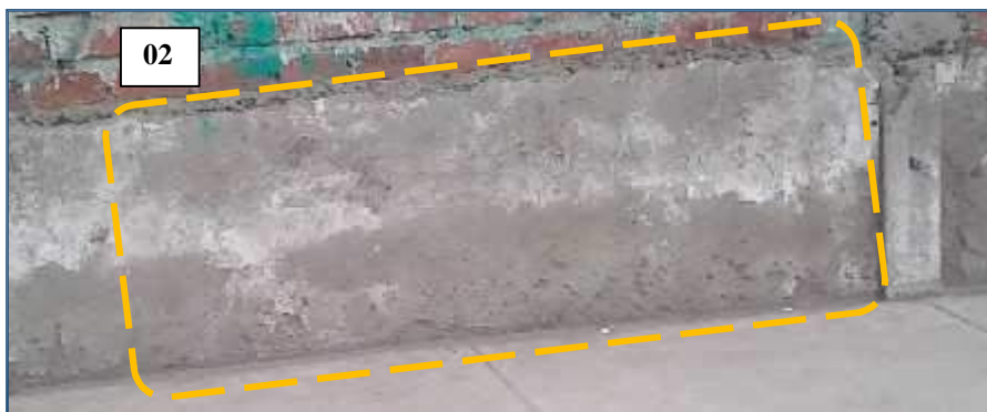
Gráfico N° 184: Patología – Eflorescencia (UM – 06, UM – 20)
