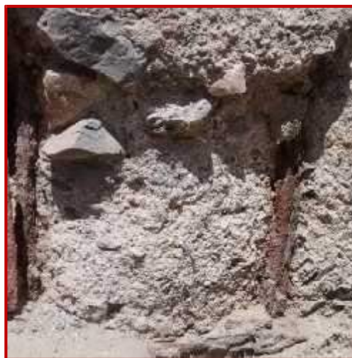
Grafico N°07: Presencia de corrosión Fuente: elaboración propia.
