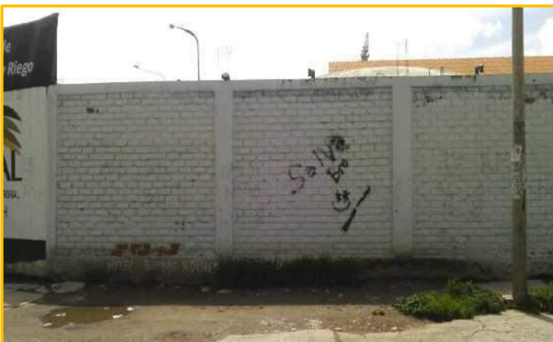
Gráfico N° 174: Vista del Jr. Italia, donde se visualiza las Criptoeflorescencias, tanto en los Muros como en el Sobrecimientos, tanto en los Muros como en el Sobrecimientos, de la misma forma se aprecia las Erosiones en los Muros.
