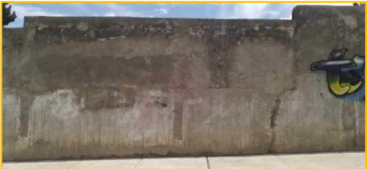
Gráfico N° 176: Vista de los Muros correspondiente al Jr. Italia, donde se aprecia las Grietas, las Eflorescencias, tanto en los muros, como en las vigas, de igual forma las Erosiones en la base de los muros.
