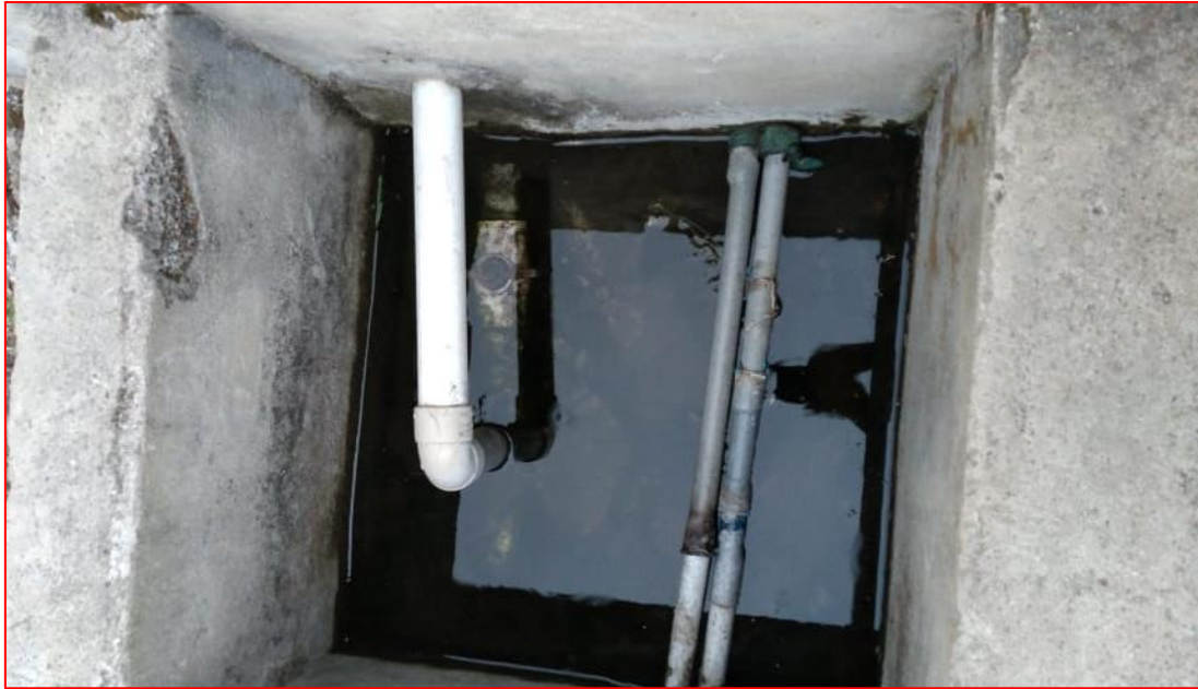
Imagen 29: Cámara de válvula del reservorio
