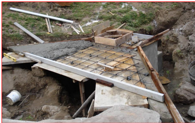
Imagen 08: Captación de un manantial de ladera
