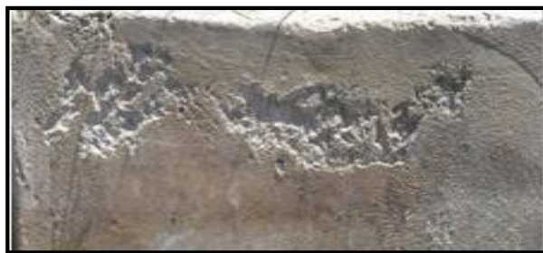
Imagen N°05. Desportillamiento o Descascaramiento.
