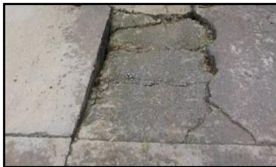
Imagen N° 06: Daño por Hundimiento
