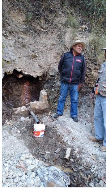
Fotografía 1: Aforo Captación Muruhuay Rajra 1-a
