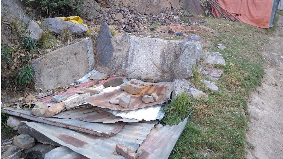
Fotografía 11: Caja rompe presión en malas condiciones
