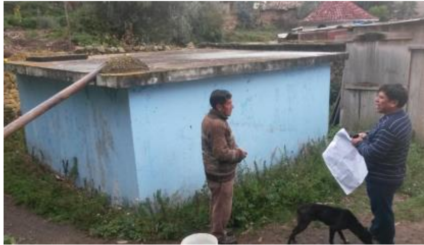
Fotografía 23: Reservorio Existente de 25 m 3 , se observa filtración en las paredes.
