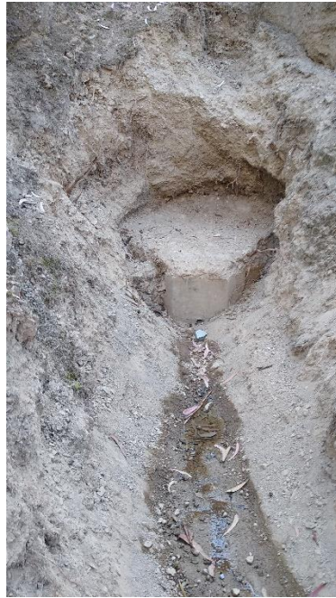
Fotografía 12: Captación Muruhuay Rajra 2 en malas condiciones
