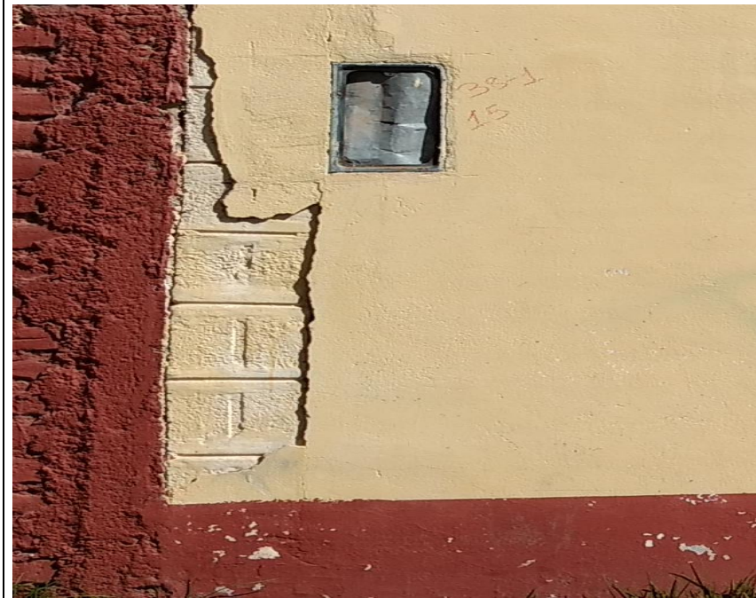
Fotografía 04: Desprendimiento en el cerco perimétrico de la Institución Educativa Secundaria Perú Birf
