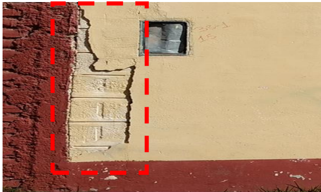
Figura 44. Desprendimiento por causa de falta de adherencia
