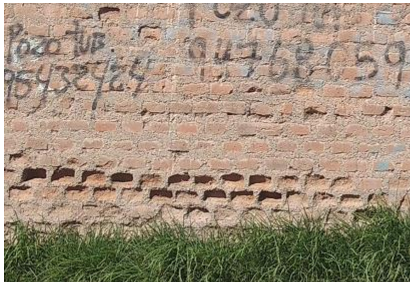
Figura 35. Erosión en muro de albañilería Nota. Fuente: Elaboracion Propia
