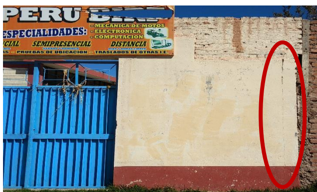
Figura 38. Fisura Nota. Fuente: Elaboracion Propia
