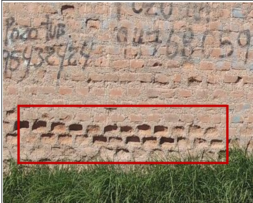
Fotografía 01: Erosión en el cerco perimétrico de la Institución Educativa Secundaria Perú Birf
