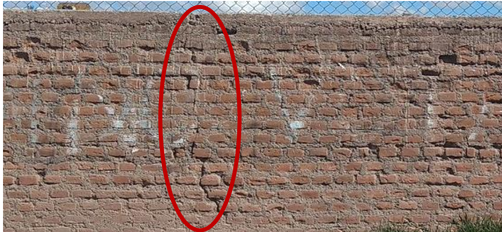
Figura 41. Grieta Nota. Fuente: Elaboracion Propia
