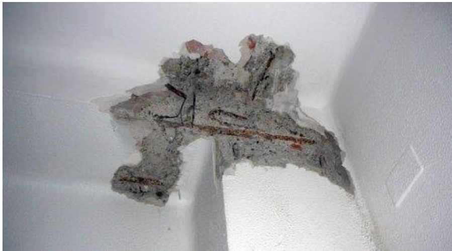
Figura 32. Corrosión de losa y columna Nota. Fuente: (Zurita W. 2015) 21
