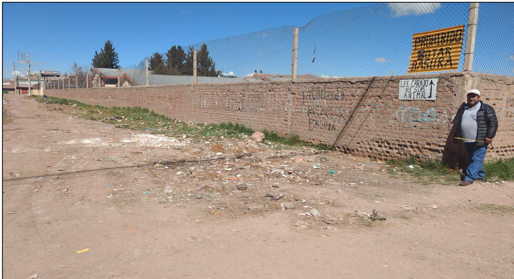
VISTA POSTERIOR DEL CERCO PERIMÉTRICO DE LA INSTITUCIÓN EDUCATIVA SECUNDARIA PERÚ BIRF
