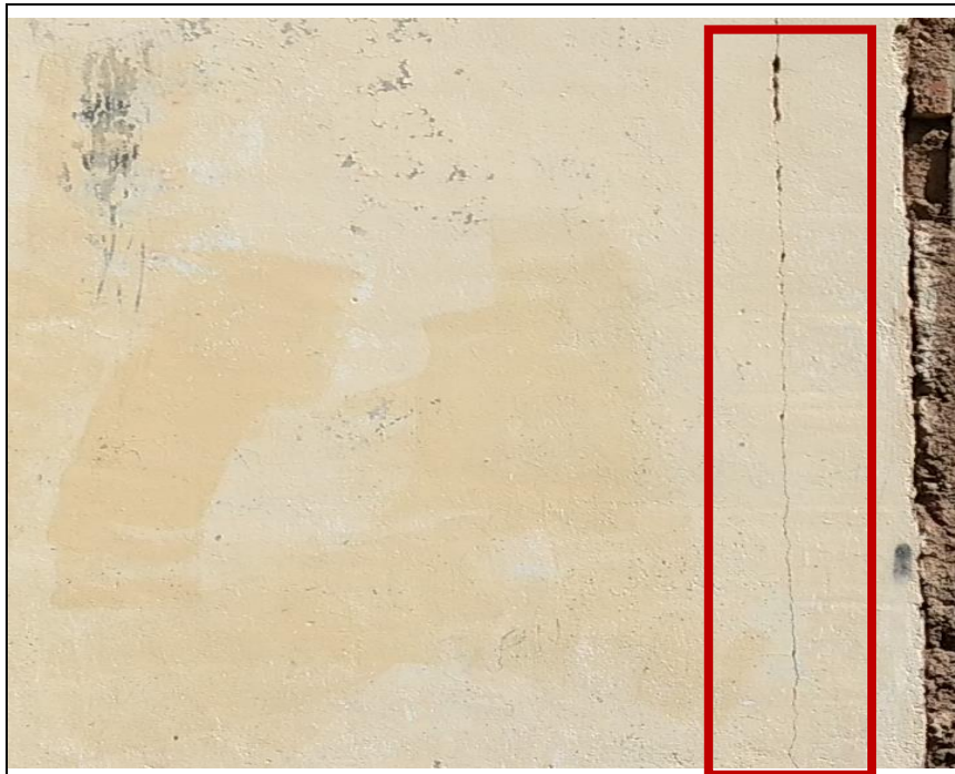
Fotografía 03: Fisura en el cerco perimétrico de la Institución Educativa Secundaria Perú Birf
