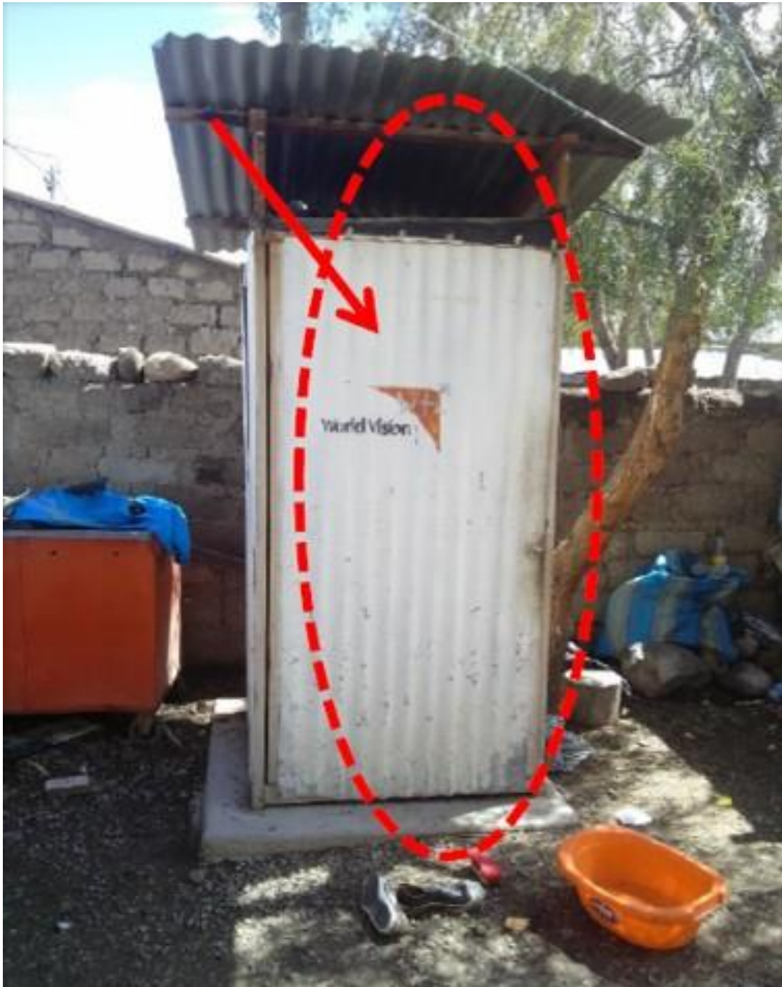
Figura 5.8: Vistas fotográficas del estado situacional de las letrinas. Fuente: Elaboración propia.
