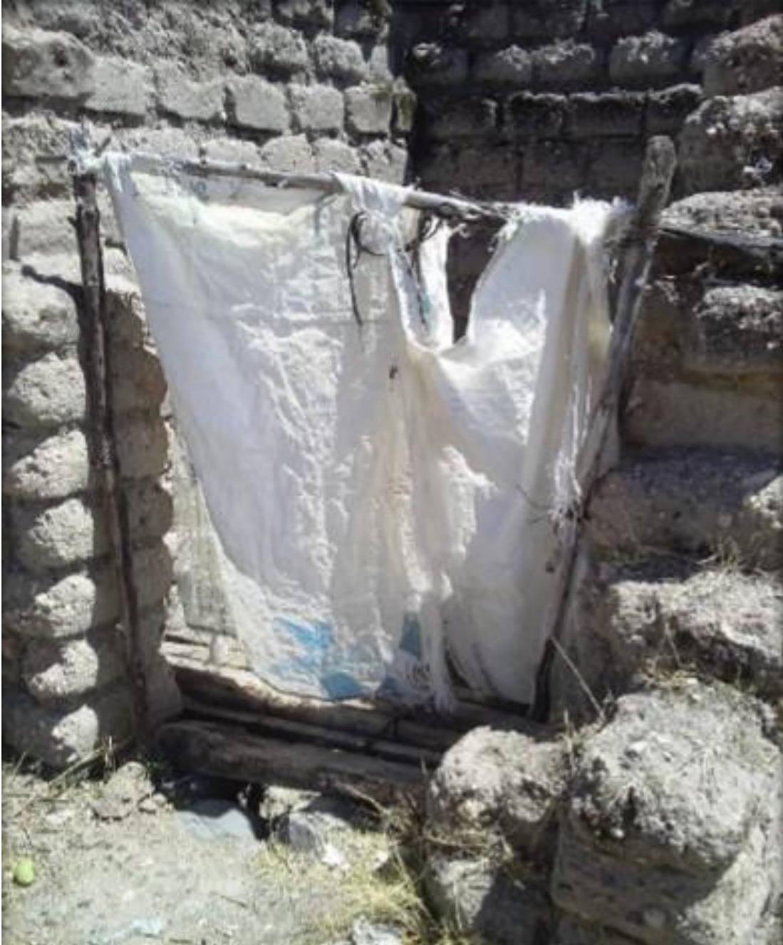
Figura 5.9: Vistas fotográficas del estado situacional de las letrinas. Fuente: Elaboración propia.
