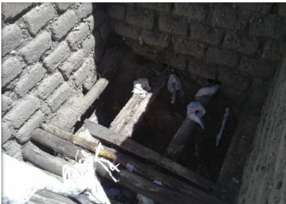
Figura 5.1: Estado actual de las letrinas existentes.
